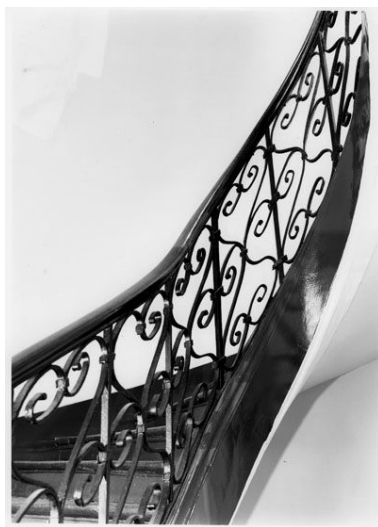
Vue de la rampe. Photographie, 2000. (Collection particulière. Photographies P. Sébert) Phot. Laurent Kruszyk, Autr. Philippe (photographe) Sébert IVR11_20097500352NUC2B
