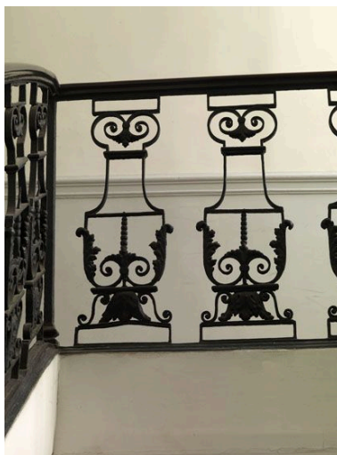
Balustres droits du dernier palier en partie refaits. Phot. Laurent Kruszyk IVR11_20107500208NUC4A
