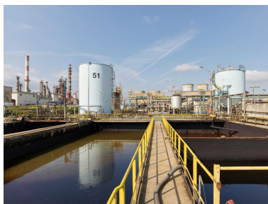
Zone du traitement des eaux (Unité 420). Bassin d'orage (déversoir en cas de débordement). Phot. Stéphane Asseline IVR11_20237700382NUC4A
