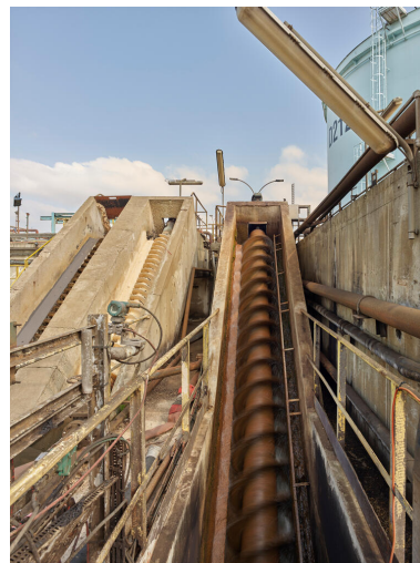
Zone du traitement des eaux (Unité 420). Vis sans fin de la chaîne huileuse (premier traitement mécanique pour séparer l'eau des hydrocarbures). À gauche, les deux autres vis de la chaîne process (eau issue du dessalage du pétrole brut). Phot. Stéphane Asseline, Phot. Stéphane Asseline IVR11_20237700380NUC4A
