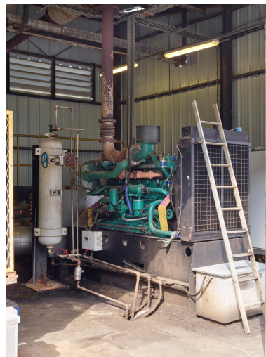
Zone du traitement des eaux (Unité 420). Moteur diesel incendie.
