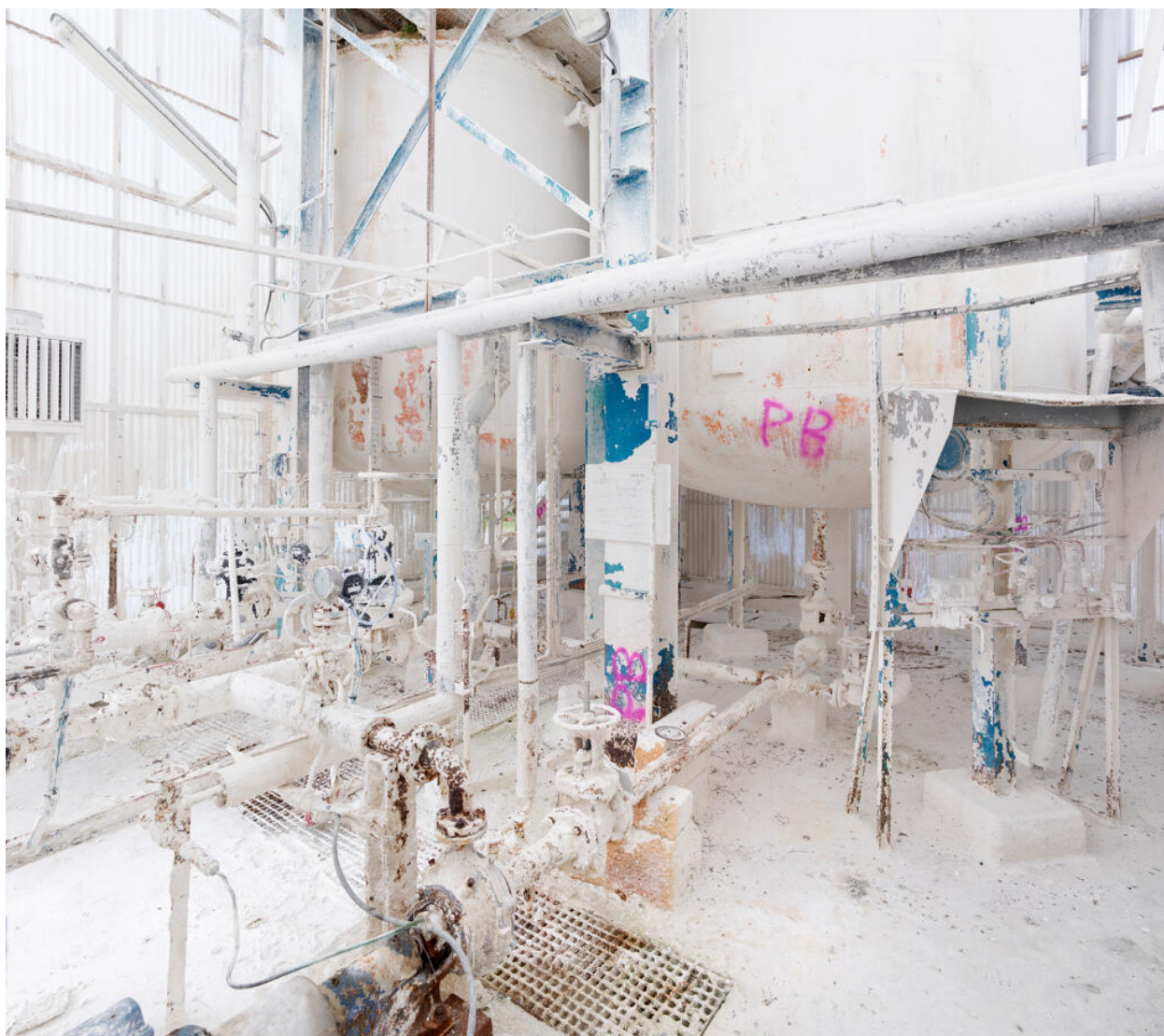
Zone du traitement des eaux (Unité 420). Intérieur du local à chaux.
