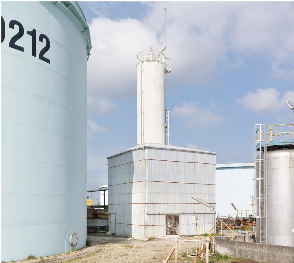
Zone du traitement des eaux (Unité 420). Local à chaux, produit chimique utilisé pour les décarbonateurs et pour faire remonter le pH de l'eau traitée.
