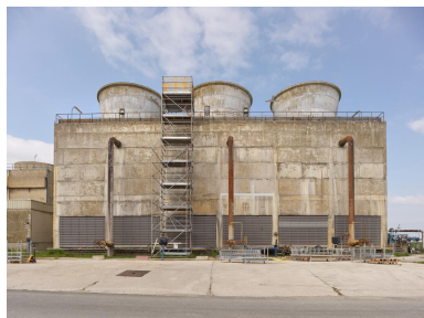
Zone du traitement des eaux (Unité 420). Tour aéroréfrigérante "SCAM", utilisée pour refroidir les eaux procédés pour le fonctionnement des Unités Ouest. Phot. Stéphane Asseline, Phot. Stéphane Asseline IVR11_20237700378NUC4A
