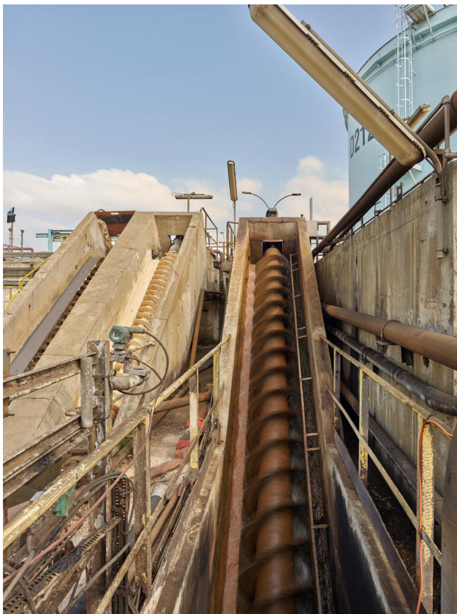
Zone du traitement des eaux (Unité 420). Vis sans fin de la chaîne huileuse (premier traitement mécanique pour séparer l'eau des hydrocarbures). À gauche, les deux autres vis de la chaîne process (eau issue du dessalage du pétrole brut).
