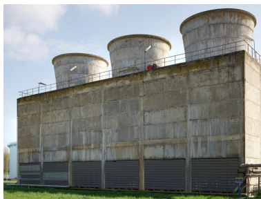
Zone du traitement des eaux (Unité 420). Tour aéroréfrigérante "SCAM", utilisée pour refroidir les eaux procédés pour le fonctionnement des Unités Ouest. Phot. Stéphane Asseline, Phot. Stéphane Asseline IVR11_20237700379NUC4A
