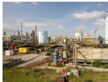
Zone du traitement des eaux (Unité 420). L'opérateur à droite contrôle les goulottes d'écumage des chaînes API (chaînes de séparation d'eaux et d'hydrocarbures). Phot. Stéphane Asseline, Phot. Stéphane Asseline IVR11_20237700374NUC4A
