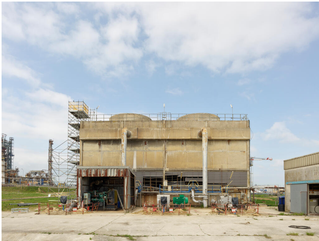
Zone du traitement des eaux (Unité 420). Tour aéroréfrigérante "SCAM", utilisée pour refroidir les eaux procédé pour le fonctionnement des Unités Est.
