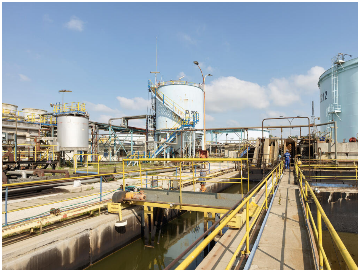
Zone du traitement des eaux (Unité 420). Bassin 420-D1, près des huileurs (séparation des eaux et de l'hydrocarbure). Au fond à droite, les vis sans fin.
