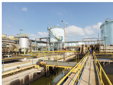
Zone du traitement des eaux (Unité 420). Bassin 420-D1, près des huileurs (séparation des eaux et de l'hydrocarbure). Au fond à droite, les vis sans fin. Phot. Stéphane Asseline, Phot. Stéphane Asseline IVR11_20237700381NUC4A
