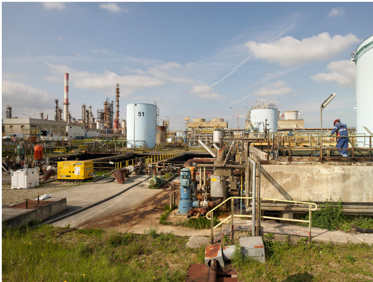
Zone du traitement des eaux (Unité 420). L'opérateur à droite contrôle les goulottes d'écumage des chaînes API (chaînes de séparation d'eaux et d'hydrocarbures).
