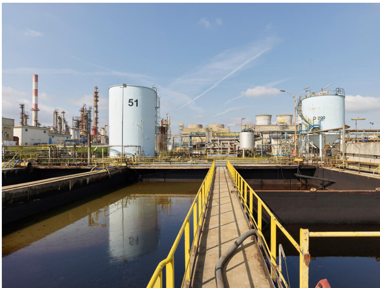
Zone du traitement des eaux (Unité 420). Bassin d'orage (déversoir en cas de débordement).
