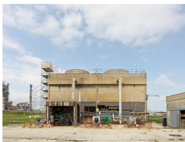
Zone du traitement des eaux (Unité 420). Tour aéroréfrigérante "SCAM", utilisée pour refroidir les eaux procédé pour le fonctionnement des Unités Est. Phot. Stéphane Asseline, Phot. Stéphane Asseline IVR11_20237700376NUC4A
