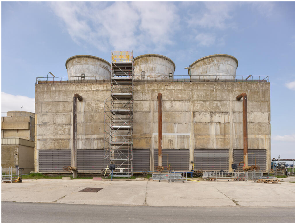
Zone du traitement des eaux (Unité 420). Tour aéroréfrigérante "SCAM", utilisée pour refroidir les eaux procédé pour le fonctionnement des Unités Ouest.
