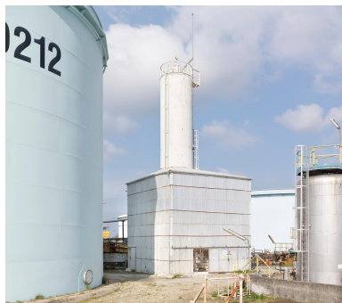
Zone du traitement des eaux (Unité 420). Local à chaux, produit chimique utilisé pour les décarbonateurs et pour faire remonter le pH de l'eau traitée.
