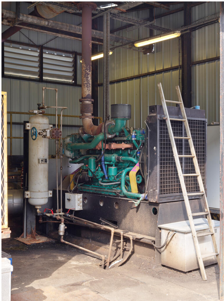
Zone du traitement des eaux (Unité 420). Moteur diesel incendié.
