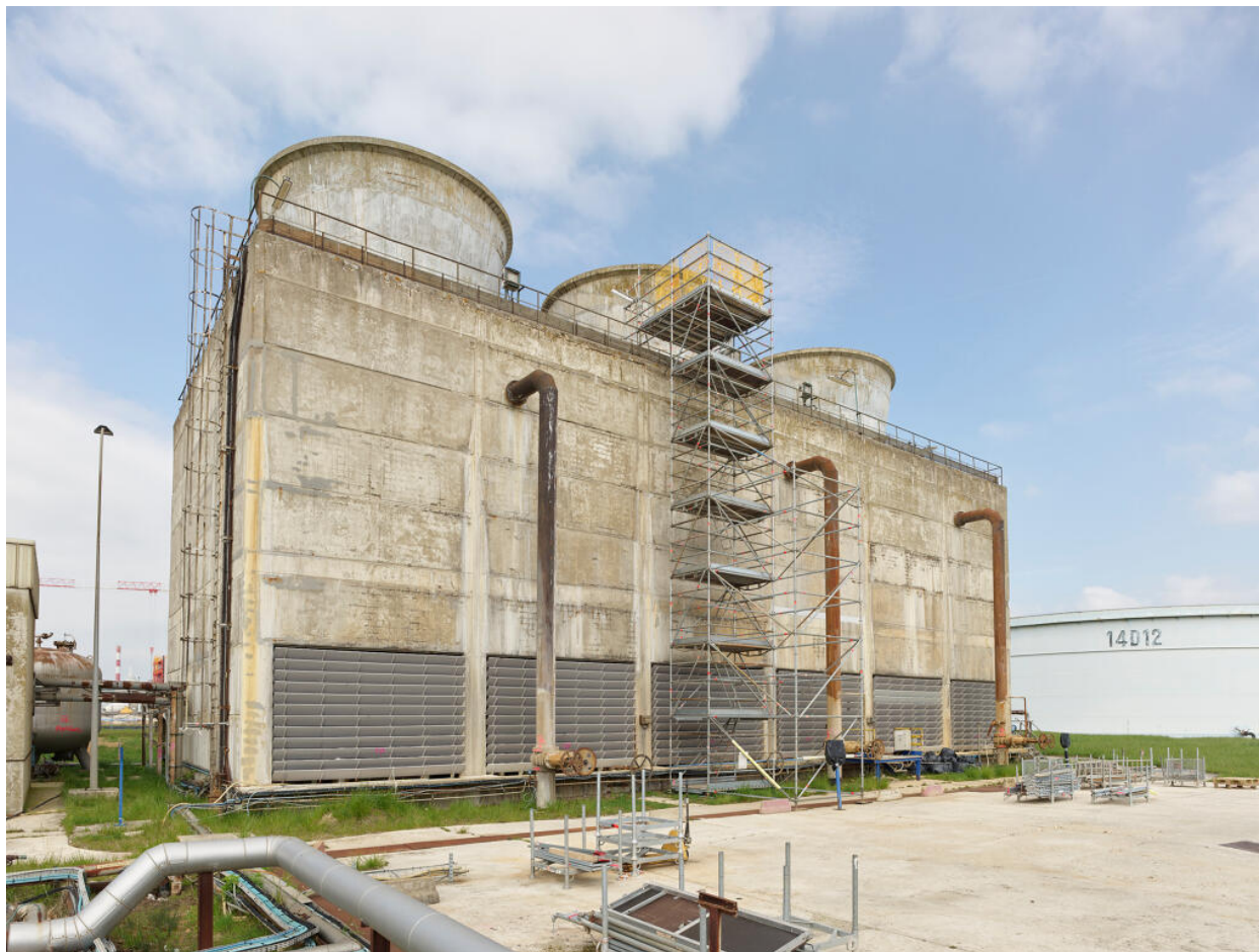
Zone du traitement des eaux (Unité 420). Tour aérorefrigérante "SCAM", utilisée pour refroidir les eaux procédé pour le fonctionnement des Unités Ouest. Au fond à droite, bac de réserve d'eau incendie (20 000 m 3 ).
