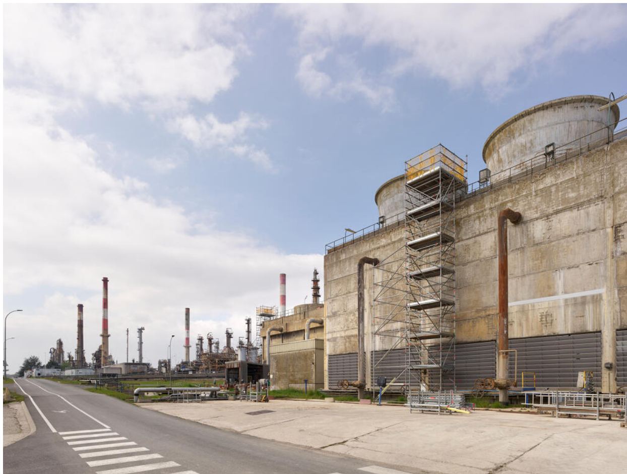
Zone du traitement des eaux (Unité 420). Tour aéroréfrigérante "SCAM", utilisée pour refroidir les eaux procédé pour le fonctionnement des Unités Est.
