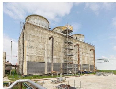
Zone du traitement des eaux (Unité 420). Tour aéroréfrigérante "SCAM", utilisée pour refroidir les eaux procédé pour le fonctionnement des Unités Ouest. Au fond à droite, bac de réserve d'eau incendie (20 000 m 3 ). Phot. Stéphane Asseline, Phot. Stéphane Asseline IVR11_20237700377NUC4A
