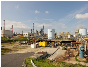
Zone du traitement des eaux (Unité 420). Vue générale. Phot. Stéphane Asseline, Phot. Stéphane Asseline IVR11_20237700373NUC4A
