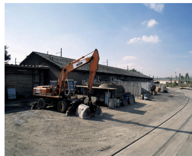
Hangar et matériel des Entrepôts ; à droite, la ligne de raccordement à la voie ferrée. Phot. Philippe Ayrault IVR11_20029101469XA
