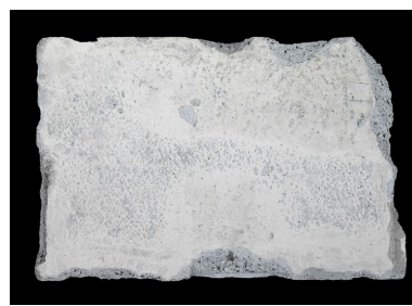
Graffiti illisible, à part un « F ». Phot. Jean-Bernard Vialles IVR11_20119300270NUC4A
