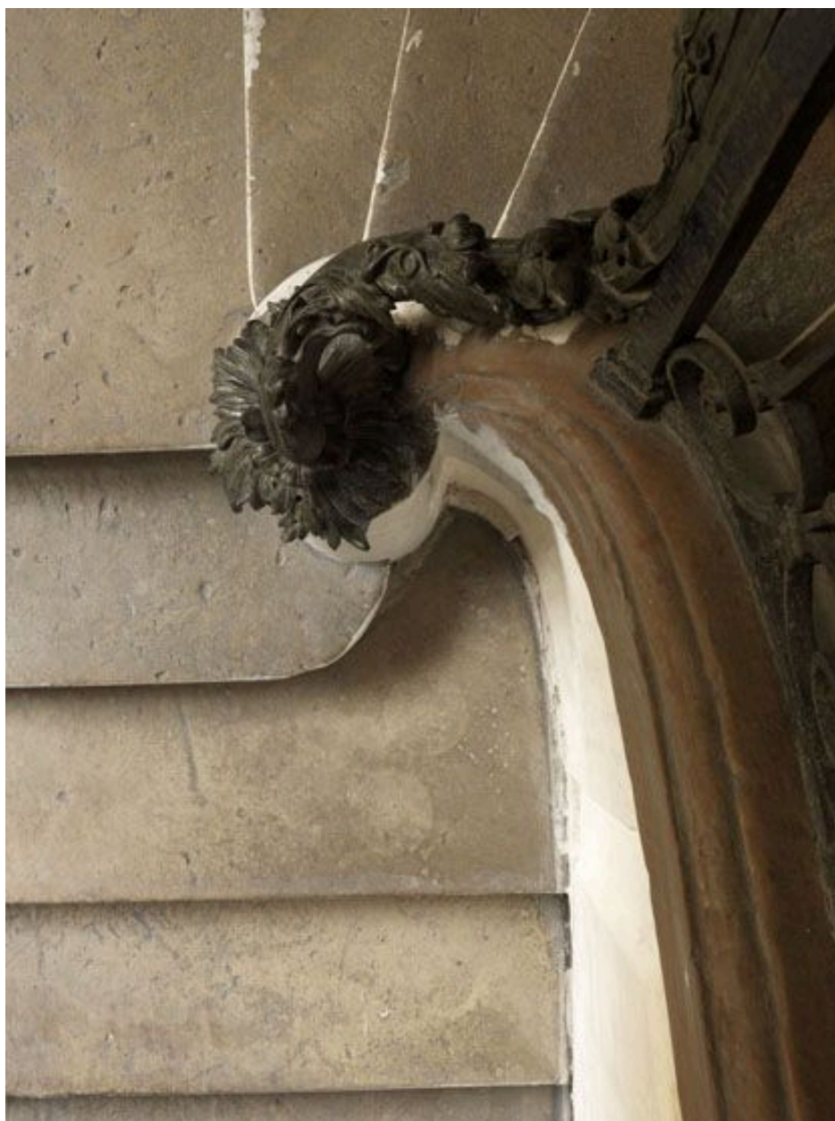
La console de départ vue en plongée.
