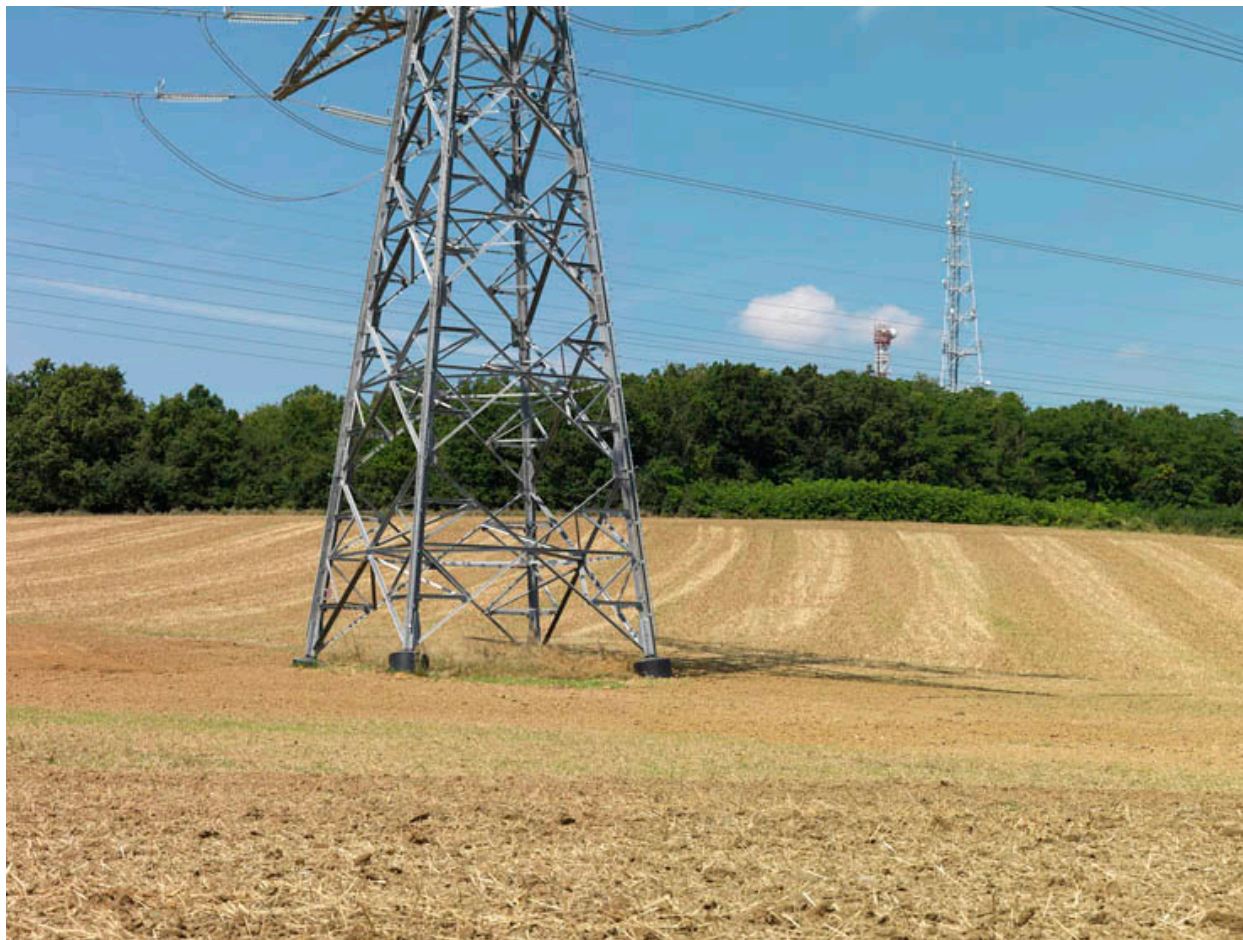
Pylone et lignes électriques haute tension dans un champ cultivé.
