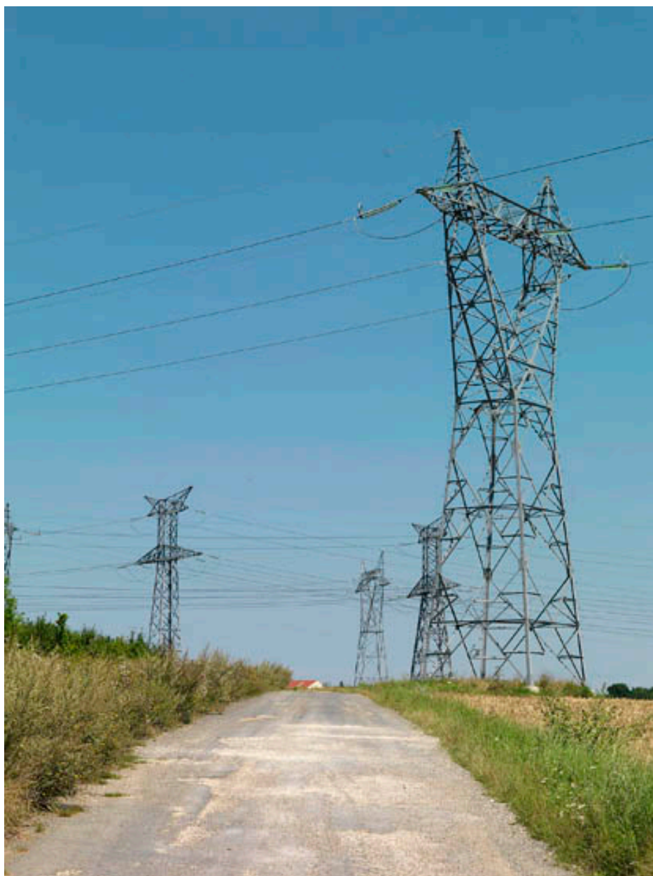
Pylones électriques haute tension au bord d'une route.
