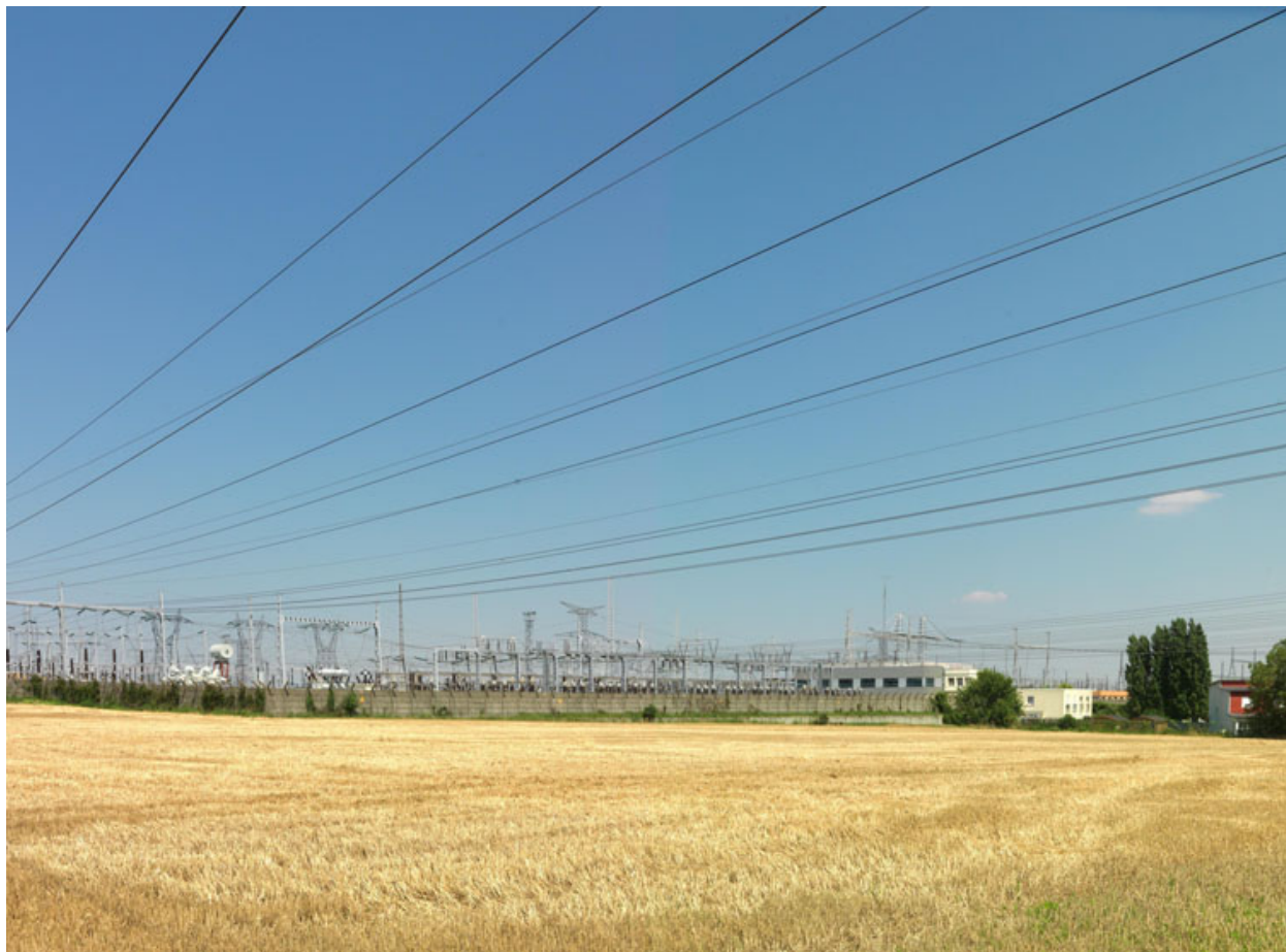
Lignes électrique haute tension et transformateur.
