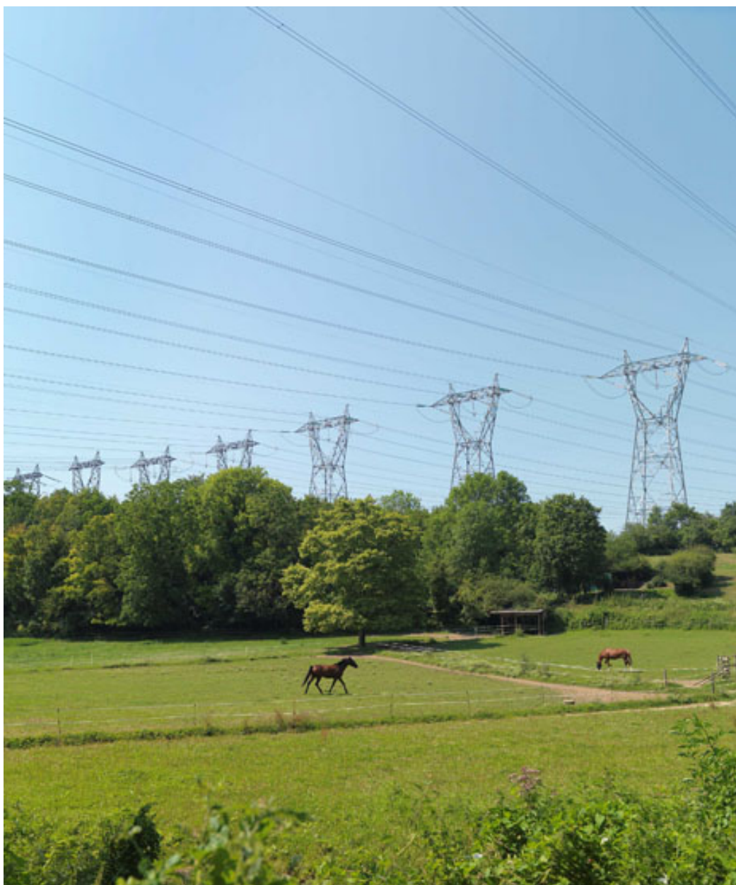
Rangée de pylones électriques à haute tension dans un champ.
