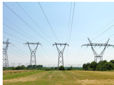
Pylones électriques à haute tension dans un champ. Phot. Philippe Ayrault IVR11_20127700652NUC4A
