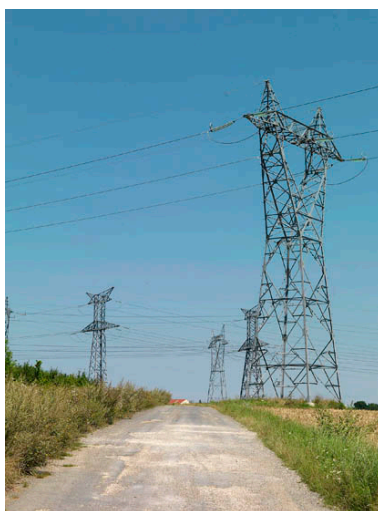
Pylones électriques haute tension au bord d'une route. Phot. Philippe Ayrault IVR11_20147700394NUC4A
