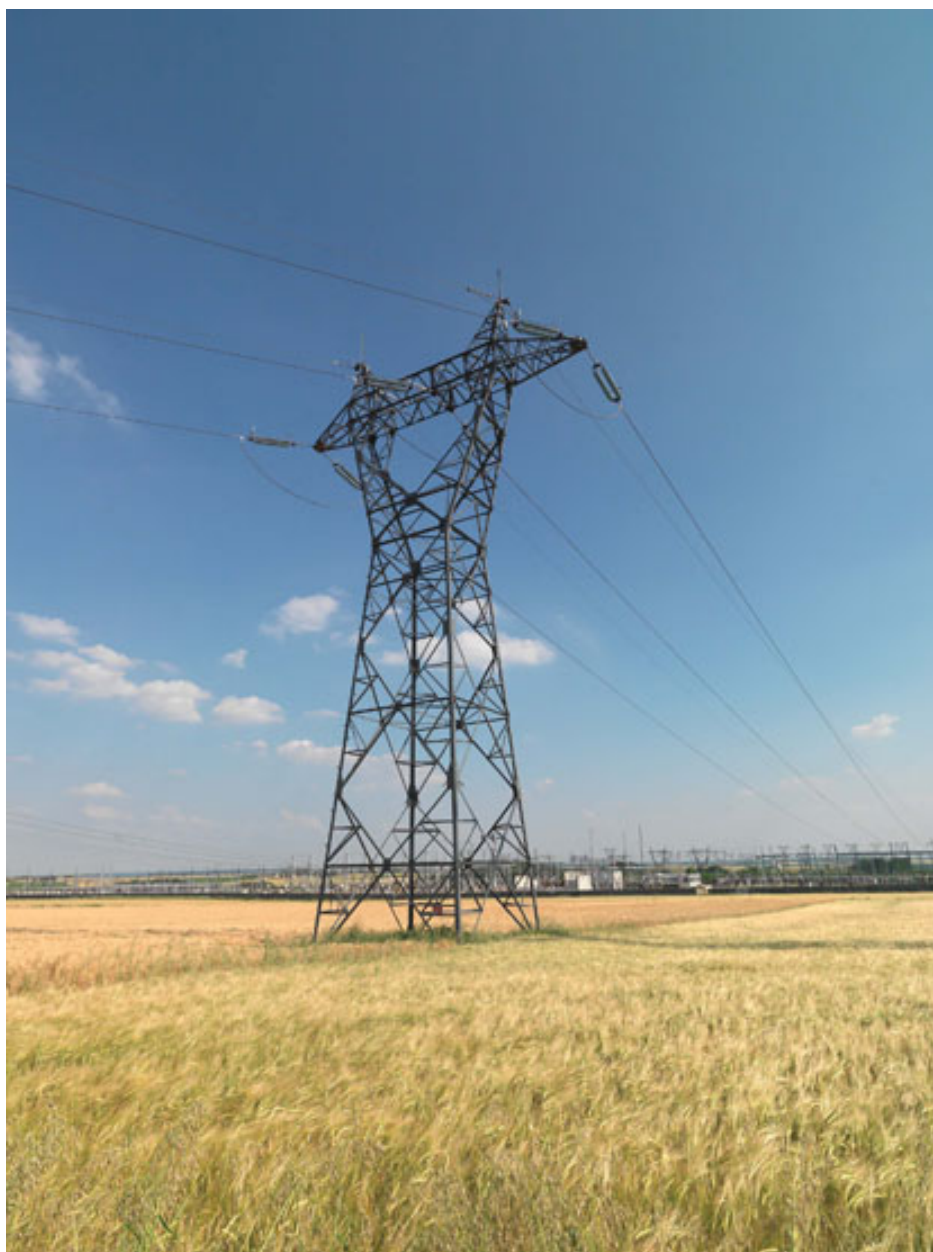
Pylone électriques à haute tension dans un champ. A l'arrière plan, le transformateur.
