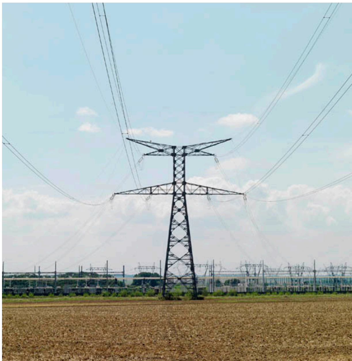
Pylones et lignes électriques haute tension.
