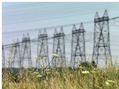
rangée de pylones électriques à haute tension. Phot. Philippe Ayrault IVR11_20127700653NUC4A
