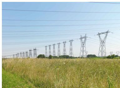
Rangée de pylones électriques à haute tension dans un champ. Phot. Philippe Ayrault IVR11_20127700650NUC4A
