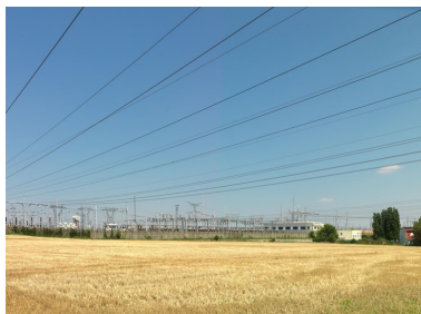
Lignes électrique haute tension et transformateur. Phot. Philippe Ayrault IVR11_20127700651NUC4A
