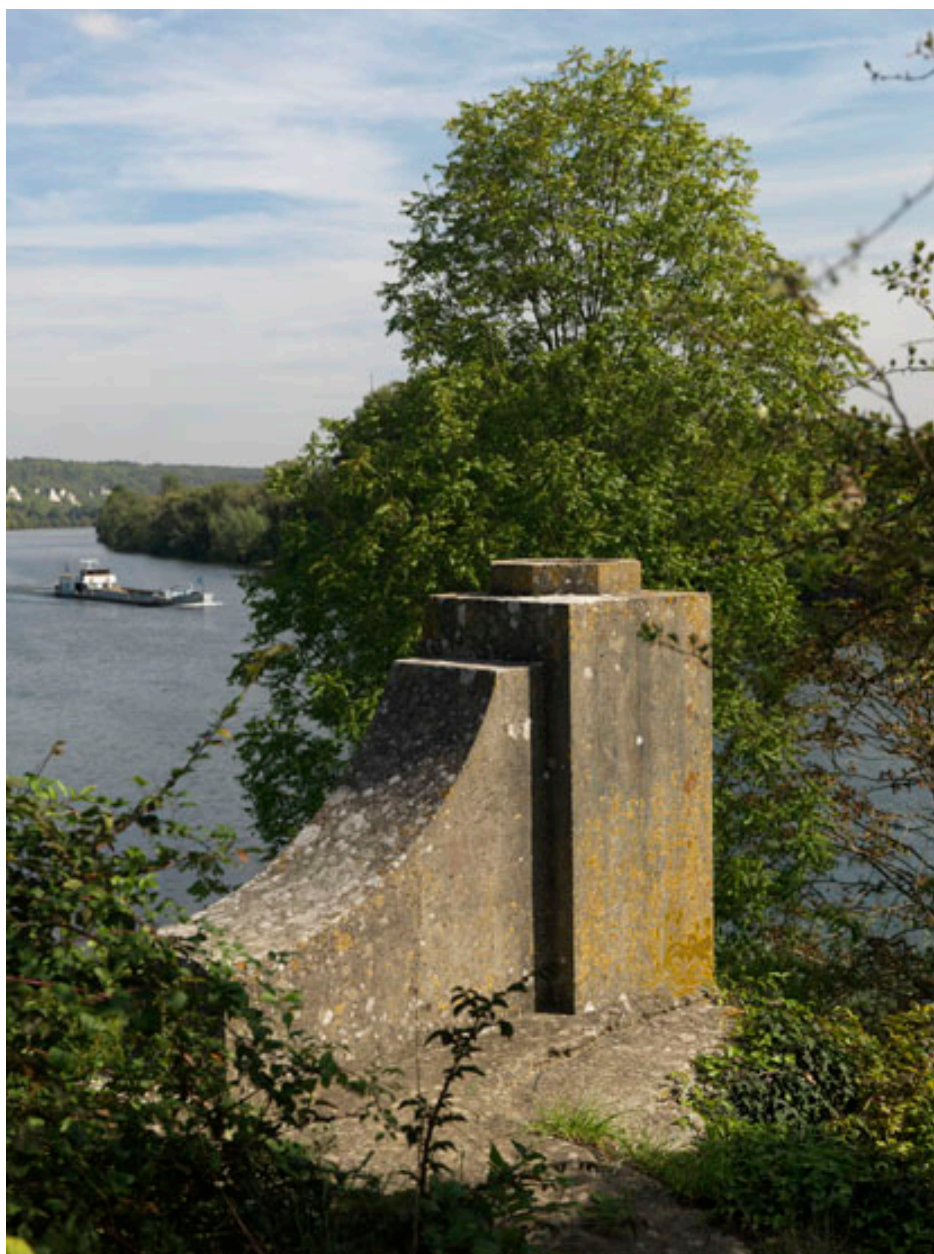
Pile en béton du pont détruit en 1944 vue depuis les berges de La Roche-Guyon vers l'amont.
