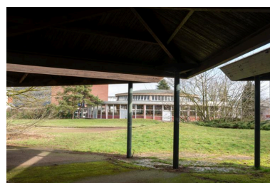
Devant l'un des préaux, au sol, le motif d'escargot dessiné par le dallage conçu par Charles Gianferrari (1969). Phot. Philippe Ayrault
