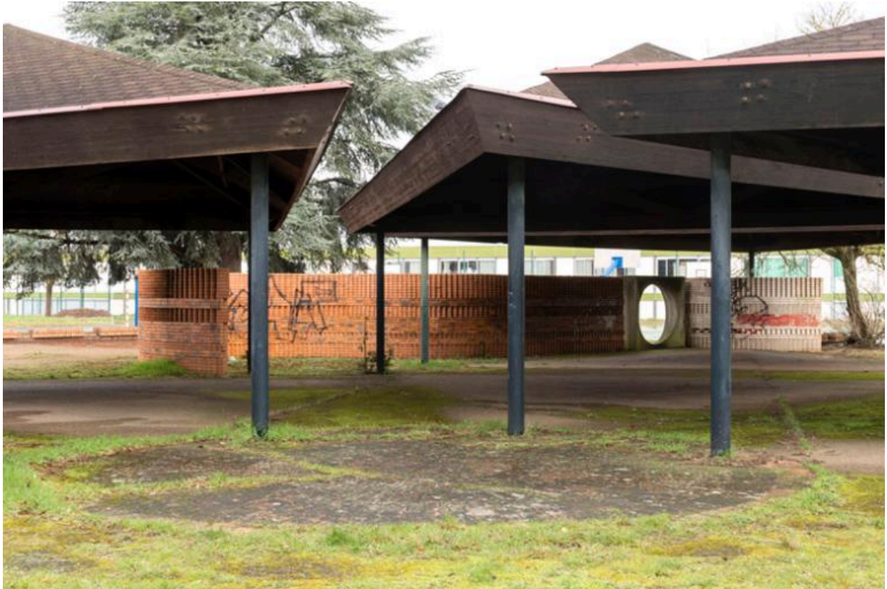
Détail d'un mur-écran en briques de Vaugirard percé d'un oculus, réalisé par Charles Gianferrari (1969).
