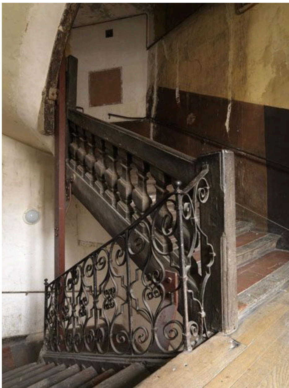
Vue de la transition entre garde-corps en fer forgé et balustres de bois.
