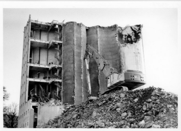
Les silos en cours de démolition. 5 janvier 1999. (Collection particulière) Phot. Philippe Ayrault, Autr. Claude Descloux IVR11_20057700334NUCB
