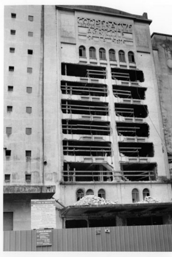
La façade des silos en cours de démolition. 1er novembre 1998. (Collection particulière) Phot. Philippe Ayrault, Autr. Claude Descloux IVR11_20057700331NUCB
