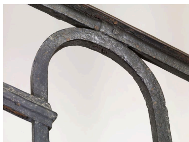
Détail du mode d'assemblage de l'arcade ainsi que des barres formant la plate-bande haute. Phot. Laurent Kruszyk IVR11_20107500051NUC4A
