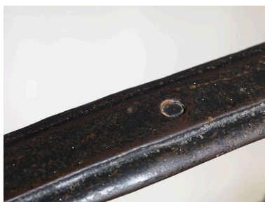
Détail du mode d'assemblage de la main courante à la plate-bande haute. Phot. Laurent Kruszyk IVR11_20107500052NUC4A
