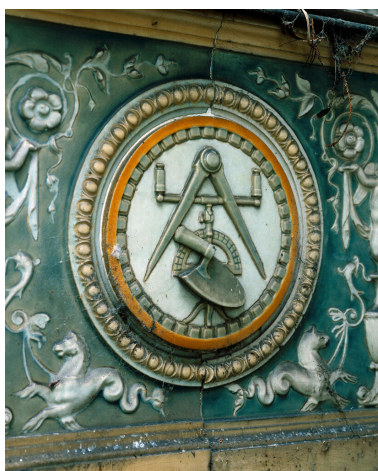
Détail de la frise du jardin d'hiver, la maçonnerie. Phot. Décamps Christian IVR11_19957800682XA
