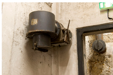
vue du système de ventilation du couloir du soubassement. Phot. Laurent Kruszyk IVR11_20157500174NUC4A
