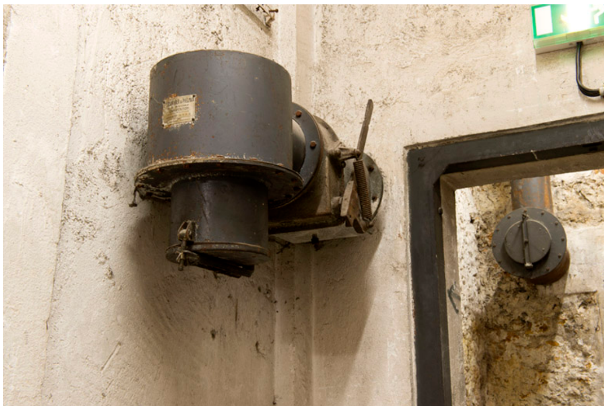
vue du système de ventilation du couloir du soubassement.
