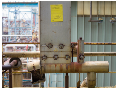
« Clarinette » de traceur vapeur destinée au réchauffement des tuyaux. Phot. Hourdebaigt Cindy IVR11_20237700261NUC4A
