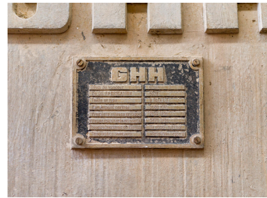
Unités Est - Zone FCC (Unité 651). Compresseur turbo-alternateur, autrement dit compresseur à récupération d'énergie. Plaque signalétique du compresseur. Phot. Hourdebaigt Cindy IVR11_20237700214NUC4A
