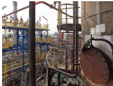
Unités Est - Zone FCC (Unité 651). En bleu et jaune, le filtre P.A.L (récupération du catalyseur dans le produit de fond de colonne), vue depuis le FCC. Au premier plan à droite, un trou d'homme permettant la visite interne d'un équipement. Phot. Stéphane Asseline, Phot. Stéphane Asseline IVR11_20237700275NUC4A
