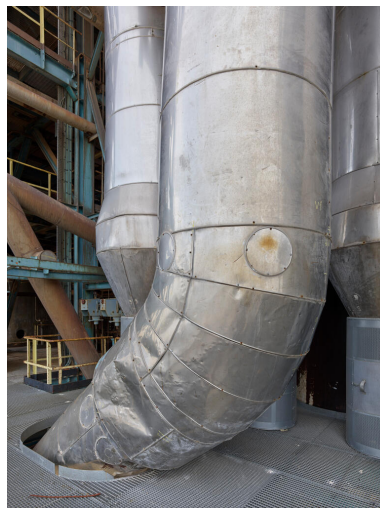
Unités Est - Zone FCC (Unité 651). Conduite de fumées alimentant les cyclones de récupération du catalyseur.
