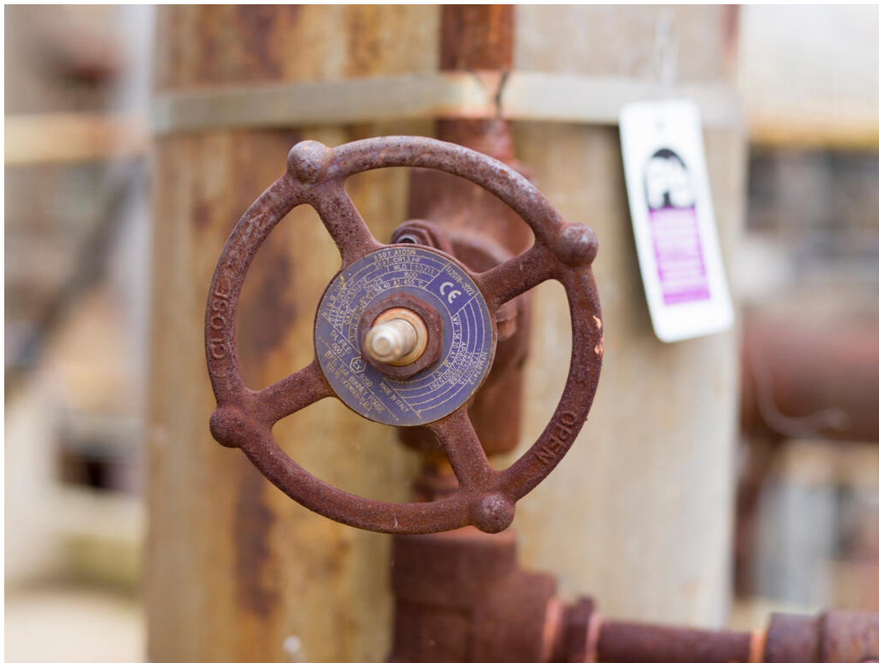
Volant de vanne d'un circuit de fluidisation.
