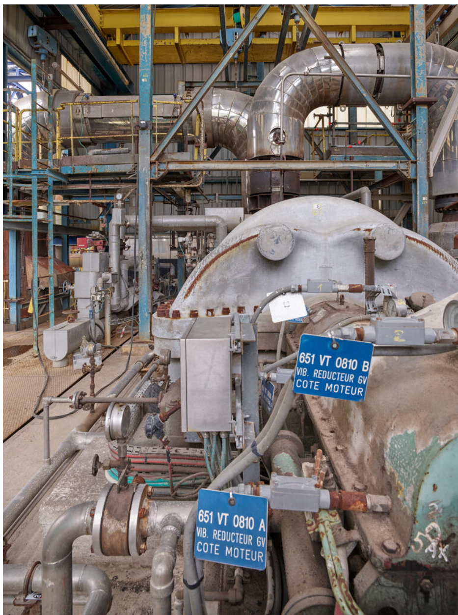
Unités Est - Zone FCC (Unité 651). Compresseur turbo-alternateur, autrement dit compresseur à récupération d'énergie.
