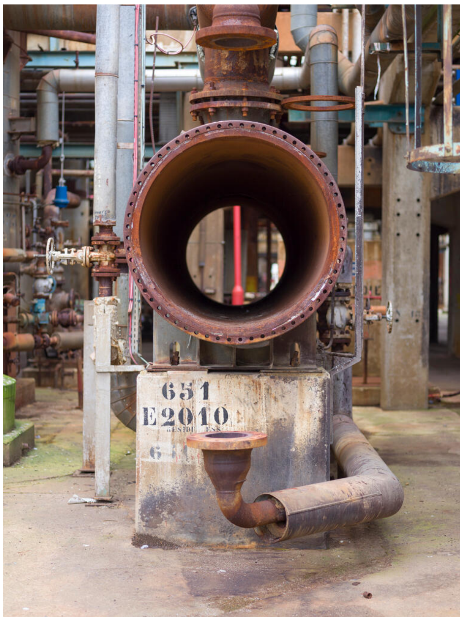
Unités Est - Zone FCC (Unité 651). Calandre de l'échangeur tubulaire E2010 sur l'unité FCC (651). Equipement servant à l'échange de calories entre deux fluides ayant des températures différentes.
