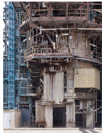
Unités Est - Zone FCC (Unité 651). Centre de l'image, lignes de traçage vapeur et de retour de condensats destinées au réchauffage des tuyauteries. En bas à droite, au premier plan, la conduite de fluidisation du catalyseur du régénérateur de l'unité. À gauche, en bleu, l'ascenseur de la zone.
