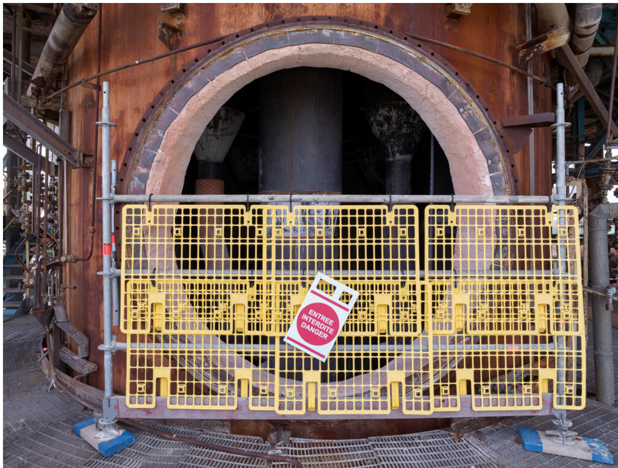
Unités Est - Zone FCC (Unité 651). Porte d'accès à l'intérieur du régénérateur du FCC. Porte boulonnée lorsque l'unité est en fonctionnement.
