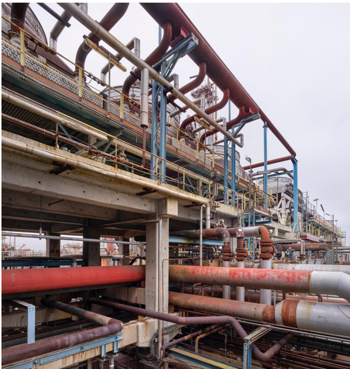
Unités Est - Zone FCC (Unité 651). Au premier plan, en rouge, ligne de torches (évacuation des gaz).
