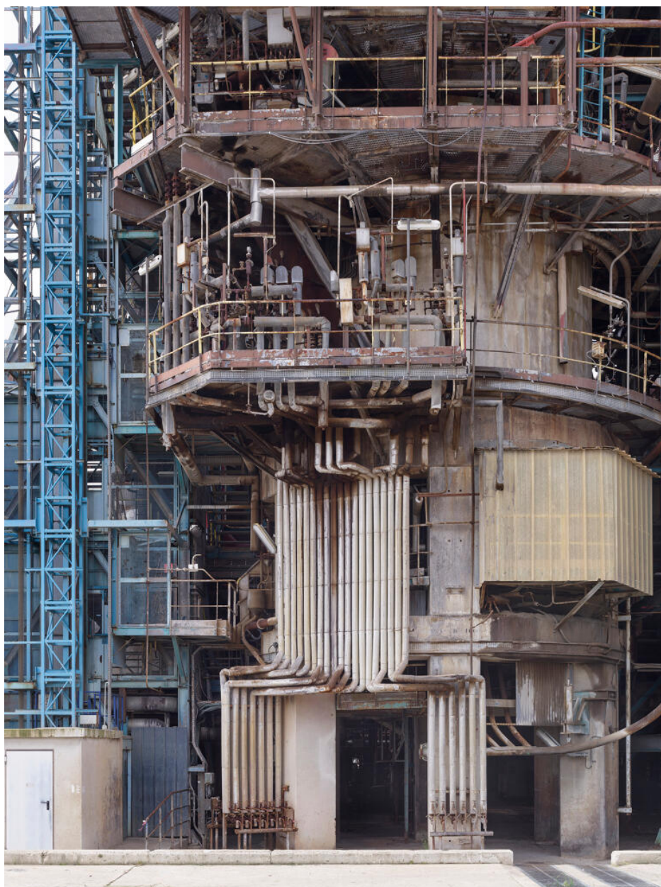
Unités Est - Zone FCC (Unité 651). Centre de l'image, lignes de traçage vapeur et de retour de condensats destinées au réchauffage des tuyauteries. En bas à droite, au premier plan, la conduite de fluidisation du catalyseur du régénérateur de l'unité. À gauche, en bleu, l'ascenseur de la zone.
