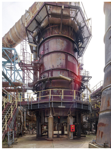
Unités Est - Zone du viscoréducteur (Unité 691). Vue du four de l'alkylation (Unité 761) situé sur l'unité du viscoréducteur. Phot. Stéphane Asseline, Phot. Stéphane Asseline IVR11_20237700284NUC4A
