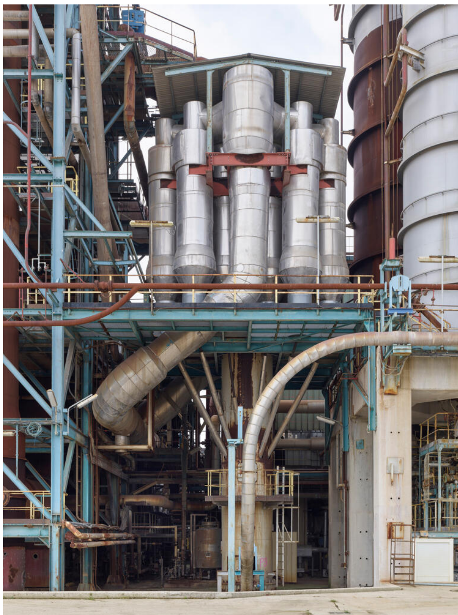
Vue globale des cyclones de récupération du catalyseur. (Unité FCC, 651). Les fumées chargées en catalyseur proviennent de la zone réactionnelle.
