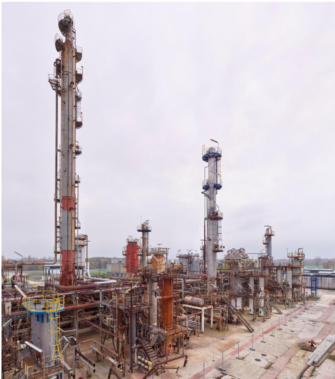
Unités Est - Zone FCC (Unité 651). Vue globale sur l'alkylation. La colonne C1003 (isostrippeur, séparation des gaz) au premier plan est la plus grande du site (72 mètres).
