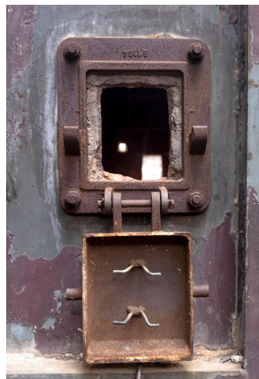
Unités Est - Zone du viscoréducteur (Unité 691). Regard permettant de contrôler la combustion dans le four. Phot. Stéphane Asseline, Phot. Stéphane Asseline IVR11_20237700291NUC4A
