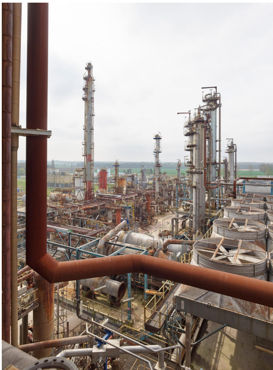
Unités Est - Zone FCC (Unité 651). Vue sur l'alkylation (à gauche) depuis la zone réactionnelle du FCC. À droite, la batterie aéroréfrigérants E 1001 .
