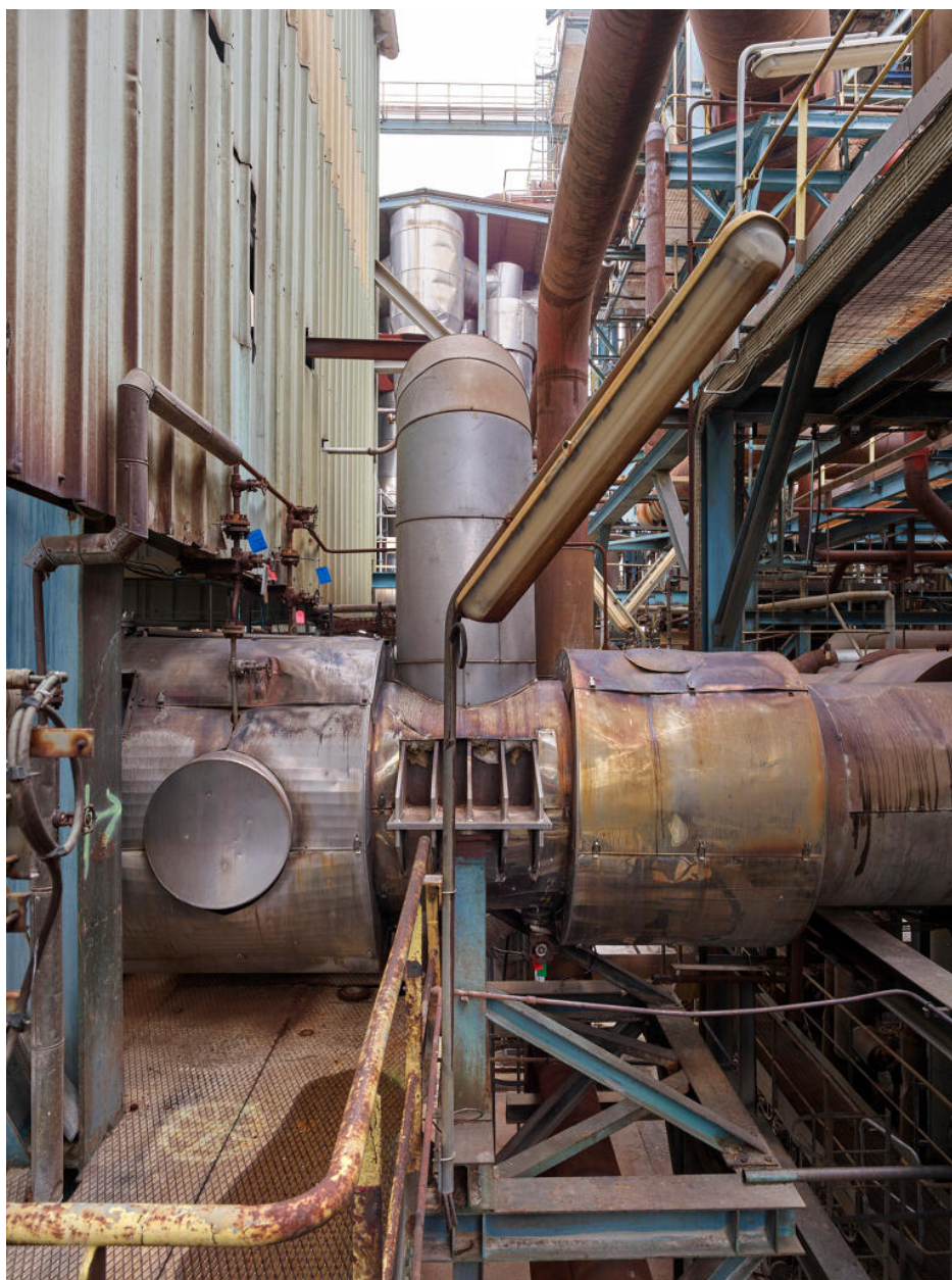
Unités Est - Zone FCC (Unité 651). Vanne "Adams" papillon servant à admettre les fumées dans la turbine du compresseur K1001.
