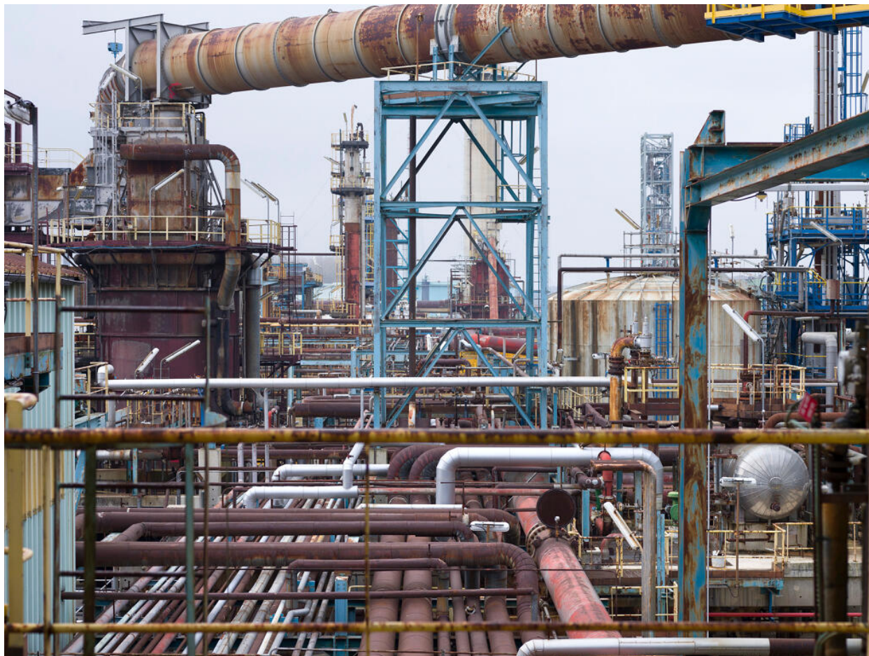
Sur la gauche de l'image, vue sur le four de l'unité alkylation (761) et son conduit de fumées depuis le FCC (unité 651).
