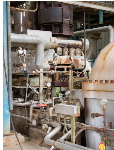
Unités Est - Zone FCC (Unité 651). Compresseur turbo- alternateur, autrement dit compresseur à récupération d'énergie. Vue de la turbine de récupération d'énergie, à gauche. Phot. Hourdebaigt Cindy IVR11_20237700220NUC4A
