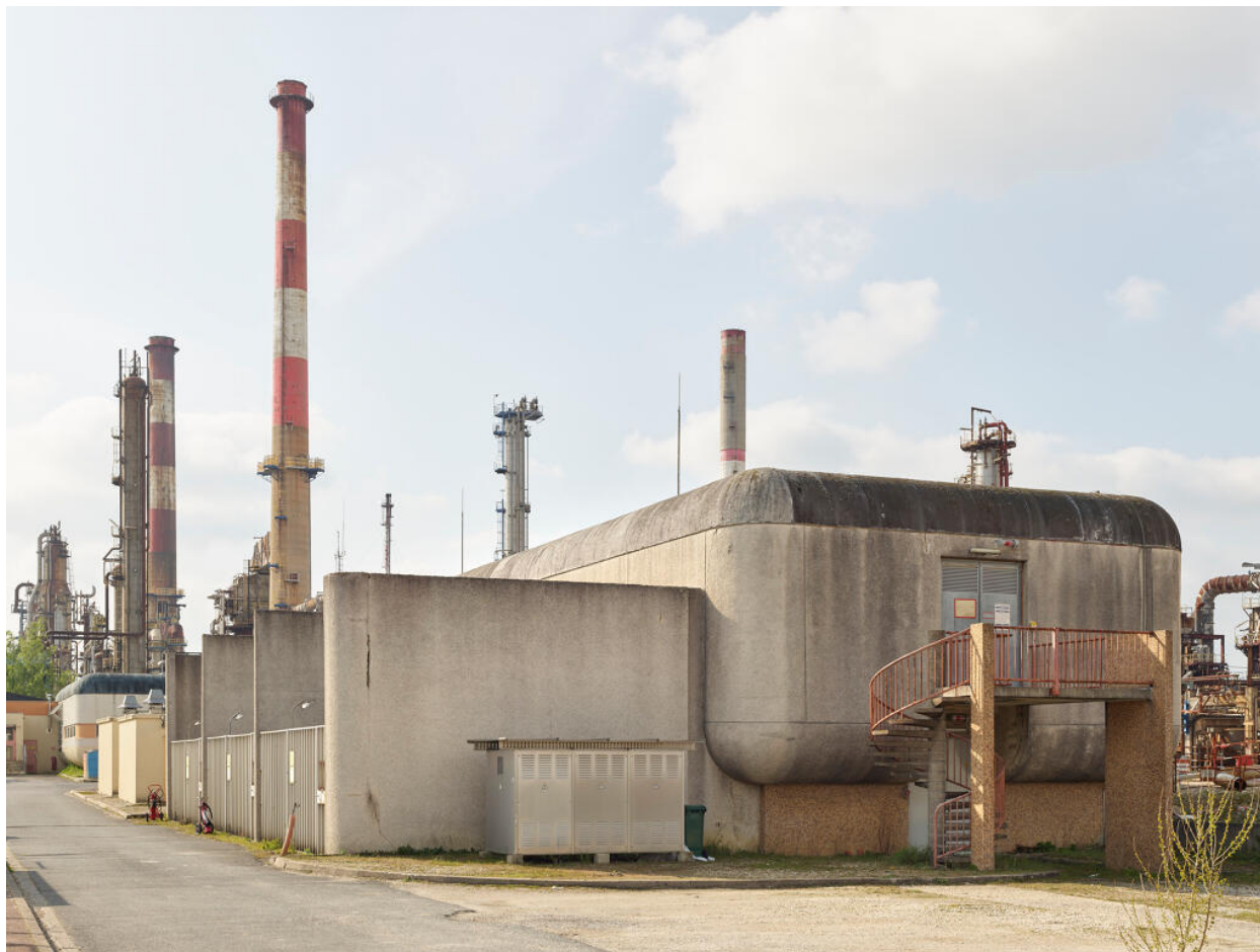
Unités Est - Zone du viscoréducteur (Unité 691). Vue du poste électrique P 10 permettant d'alimenter en électricité les unités Est.
