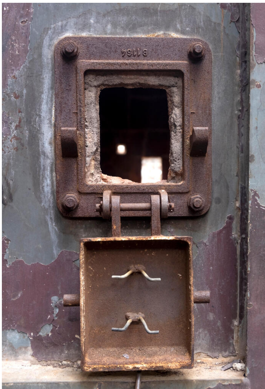
Unités Est - Zone du viscoréducteur (Unité 691). Regard permettant de contrôler la combustion dans le four.
