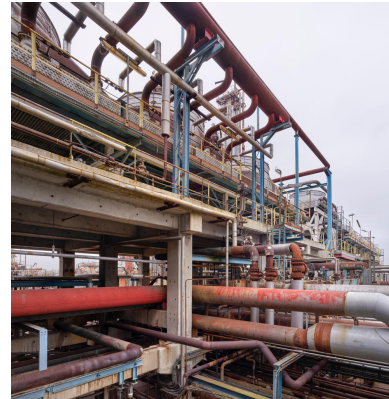
Unités Est - Zone FCC (Unité 651). Au premier plan, en rouge, ligne de torches (évacuation des gaz). Phot. Stéphane Asseline, Phot. Stéphane Asseline IVR11_20237700226NUC4A
