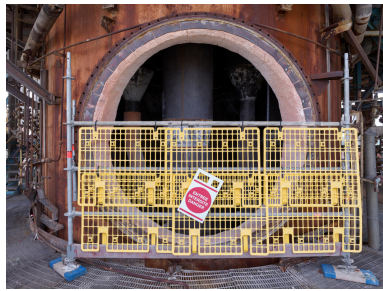
Unités Est - Zone FCC (Unité 651). Porte d'accès à l'intérieur du régénérateur du FCC. Porte boulonnée lorsque l'unité est en fonctionnement. Phot. Stéphane Asseline, Phot. Stéphane Asseline IVR11_20237700280NUC4A
