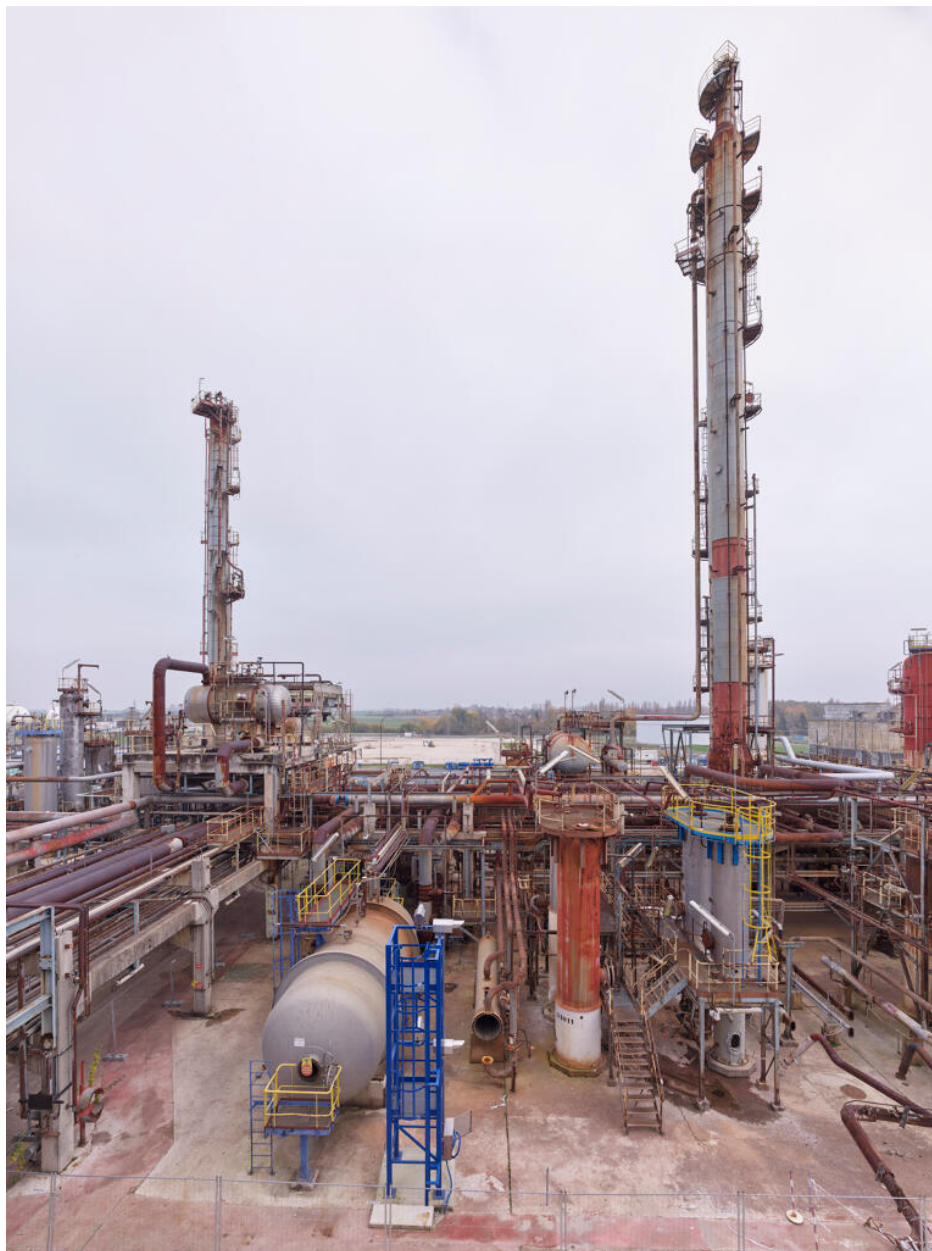
Unités Est - Zone FCC (Unité 651). Vue partielle sur l'alkylation. La structure en bleu est le radar de détection de fuite d'acide fluoridrique (HF).
