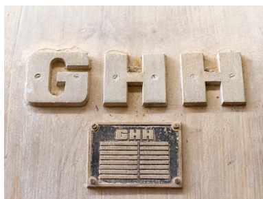
Unités Est - Zone FCC (Unité 651). Compresseur turbo-alternateur, autrement dit compresseur à récupération d'énergie. Plaque signalétique du compresseur. Phot. Hourdebaigt Cindy IVR11_20237700215NUC4A
