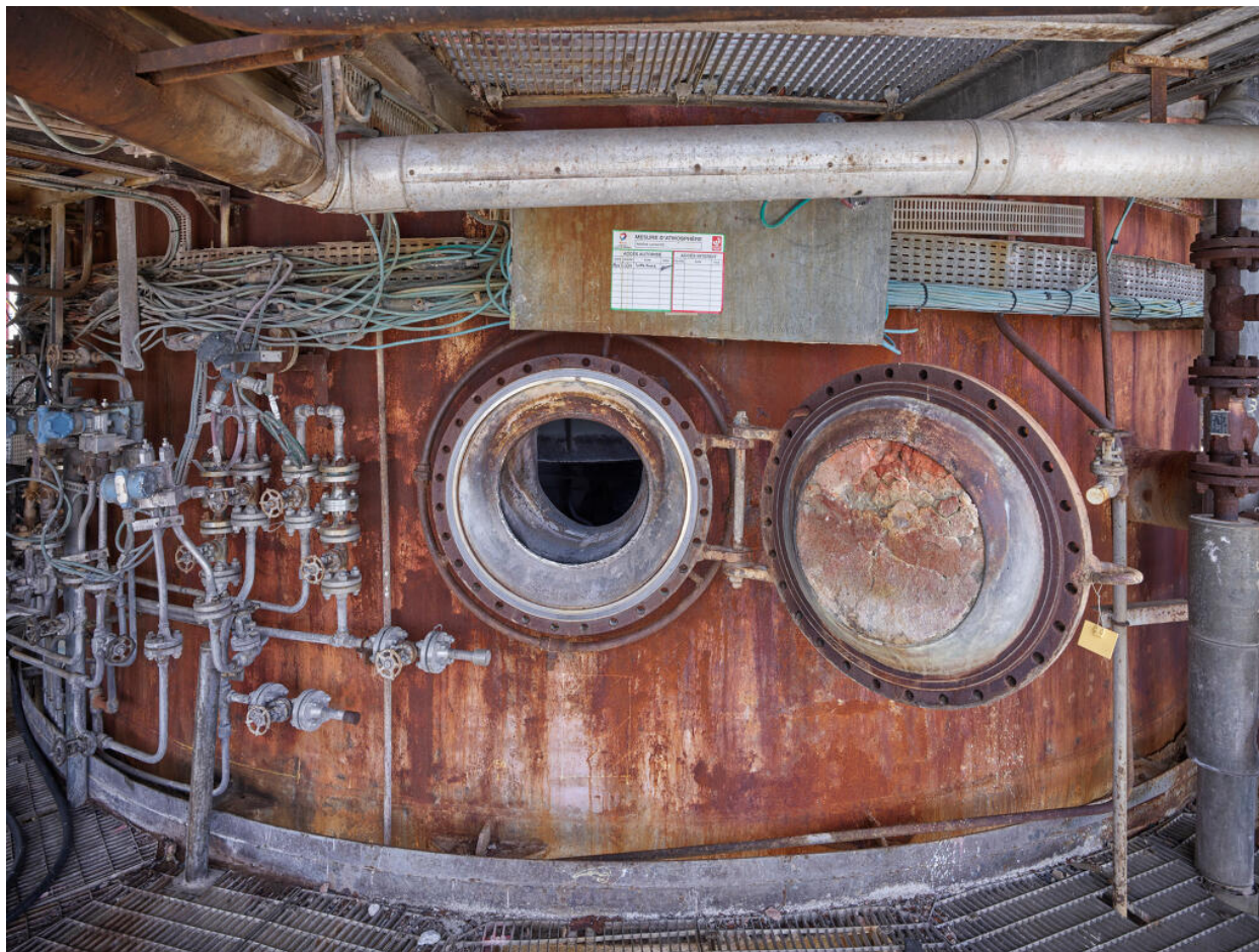
Unités Est - Zone FCC (Unité 651). Un des trous d'homme du régénérateur de FCC permettant la visite interne de l'équipement. Verrouillé en marche normale.
