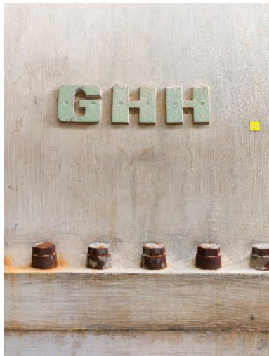
Unités Est - Zone FCC (Unité 651). Compresseur turbo-alternateur, autrement dit compresseur à récupération d'énergie. Plaque signalétique du compresseur. Phot. Hourdebaigt Cindy IVR11_20237700218NUC4A
