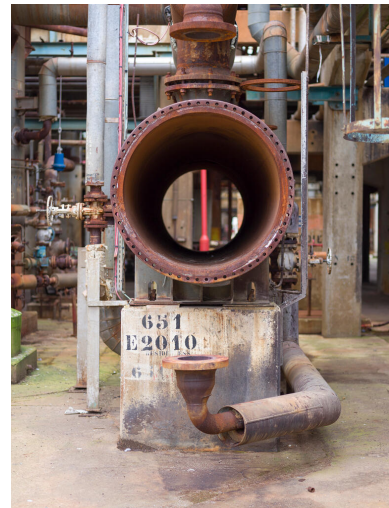
Unités Est - Zone FCC (Unité 651). Calandre de l'échangeur tubulaire E2010 sur l'unité FCC (651). Equipement servant à l'échange de calories entre deux fluides ayant des températures différentes. Phot. Hourdebaigt Cindy IVR11_20237700262NUC4A
