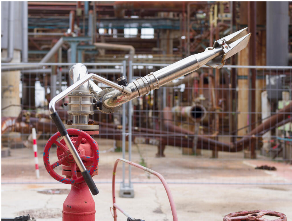
Unités Est - Allée de cheminement entre le viscoréducteur (Unité 691) et le FCC (Unité 651). Canon de défense incendie (au moins 100 m de portée).
