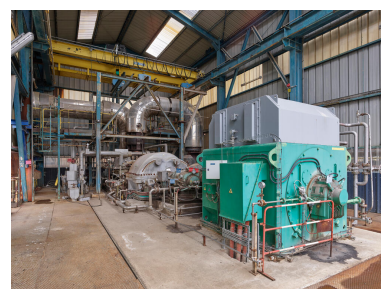
Unités Est - Zone FCC (Unité 651). Compresseur turbo-alternateur, autrement dit compresseur à récupération d'énergie.
