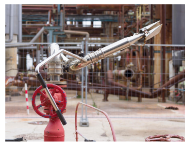
Unités Est - Allée de cheminement entre le viscoréducteur (Unité 691) et le FCC (Unité 651). Canon de défense incendie (au moins 100 m de portée).
