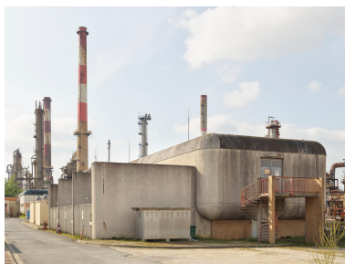
Unités Est - Zone du viscoréducteur (Unité 691). Vue du poste électrique P 10 permettant d'alimenter en électricité les unités Est. Phot. Stéphane Asseline, Phot. Stéphane Asseline IVR11_20237700293NUC4A
