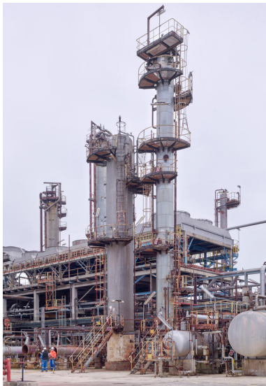
Unités Est - Zone FCC (Unité 651). Personnel à proximité des colonnes de lavage de DEA. Phot. Stéphane Asseline, Phot. Stéphane Asseline IVR11_20237700201NUC4A
