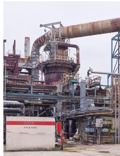
Unités Est - Zone FCC (Unité 651). Vue du four de l'alkylation situé sur la zone viscoréducteur. Phot. Stéphane Asseline, Phot. Stéphane Asseline IVR11_20237700205NUC4A
