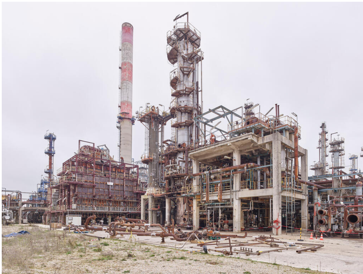
Unités Est - Zone viscoréducteurs (Unité 691). "Mis à zéro énergie" en prévision d'un démantèlement.
