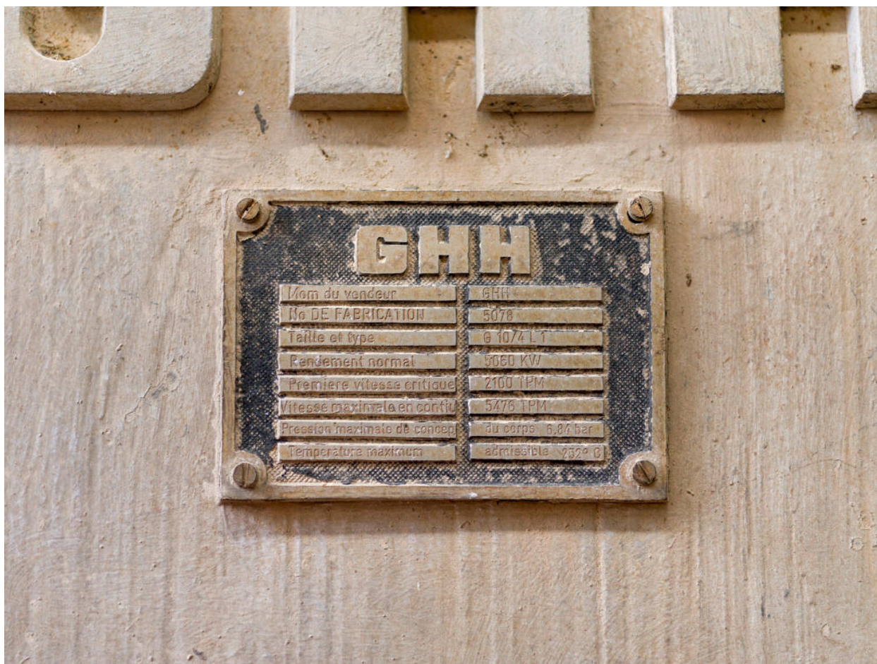
Unités Est - Zone FCC (Unité 651). Compresseur turbo-alternateur, autrement dit compresseur à récupération d'énergie. Plaque signalétique du compresseur.
