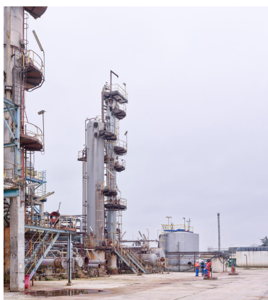
Unités Est - Zone FCC (Unité 651). Colonnes de lavage de la DEA. À l'arrière D6003, ballon de stockage.
