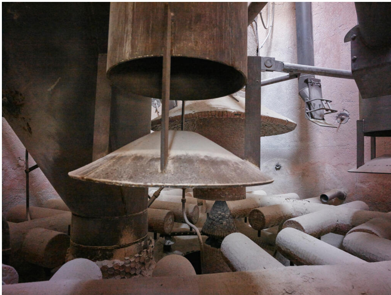
Unités Est - Zone FCC (Unité 651). Vue des râteaux d'air de fluidisation du catalyseur à l'intérieur du régénérateur du FCC.
