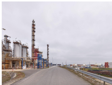
À gauche, vue sur l'unité alkylation (761) depuis l'avenue 3 bis. Route réglementée due à la dangerosité de l'unité alkylation. Phot. Stéphane Asseline, Phot. Stéphane Asseline IVR11_20237700265NUC4A
