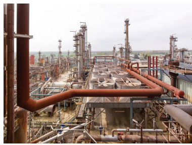
Unités Est - Zone FCC (Unité 651). Vue sur la partie supérieure des aéroréfrigérants E 1001 depuis la zone réactionnelle du FCC. Phot. Stéphane Asseline, Phot. Stéphane Asseline IVR11_20237700278NUC4A
