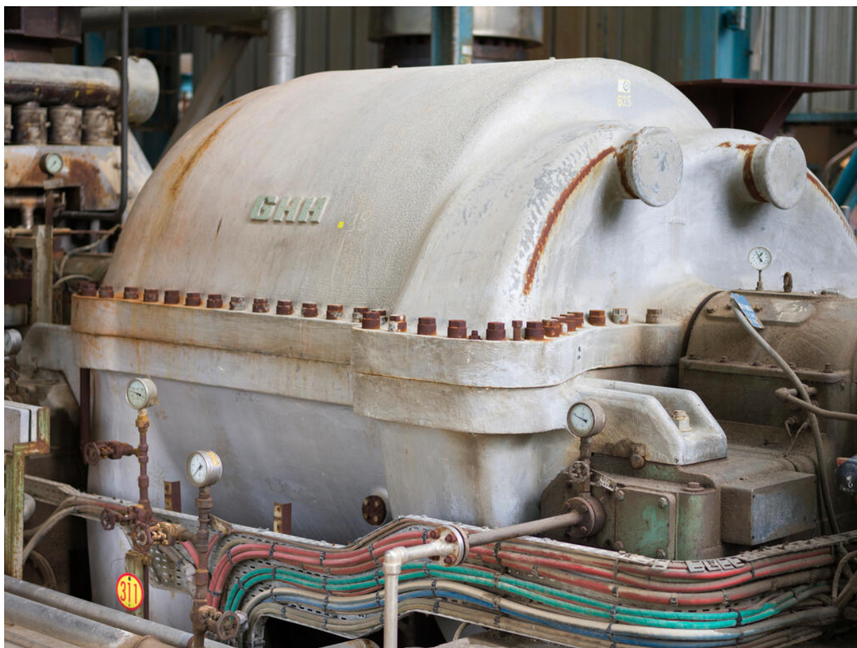
Unités Est - Zone FCC (Unité 651). Compresseur turbo-alternateur, autrement dit compresseur à récupération d'énergie. Vue du compresseur. Les manomètres permettent de vérifier la pression du circuit d'huile de lubrification.
