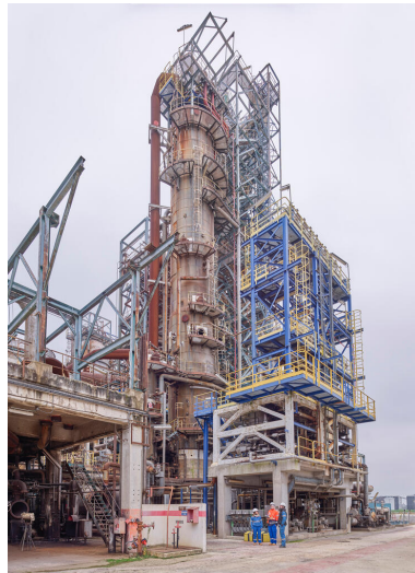
Unités Est - Zone FCC (Unité 651). Colonne de fractionnement primaire au centre, filtre PALL à droite qui permet d'enlever les particules fines liées au process.
