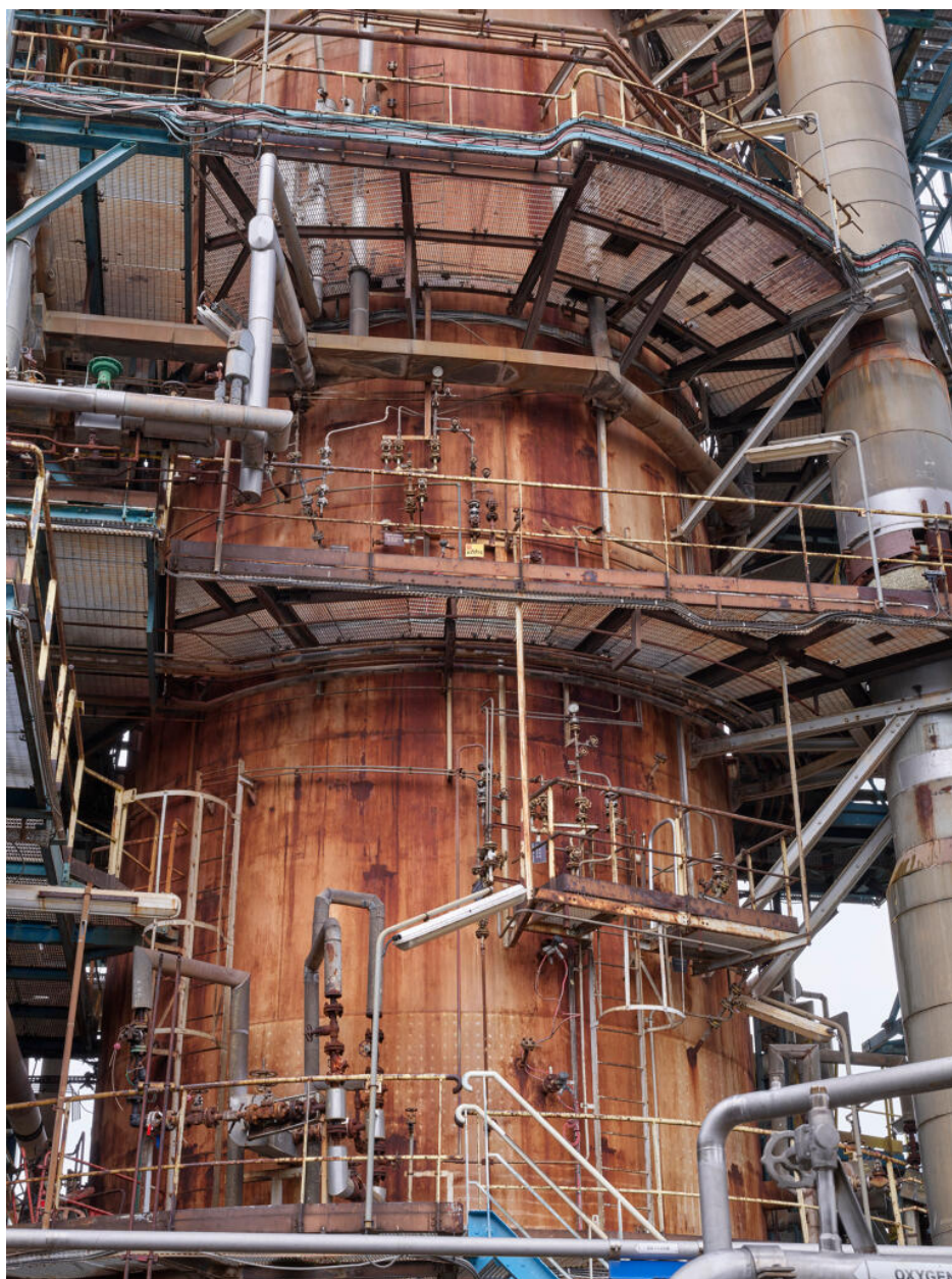
Unités Est - Zone FCC (Unité 651). Vue globale. À droite, entrée du compresseur K1001.
