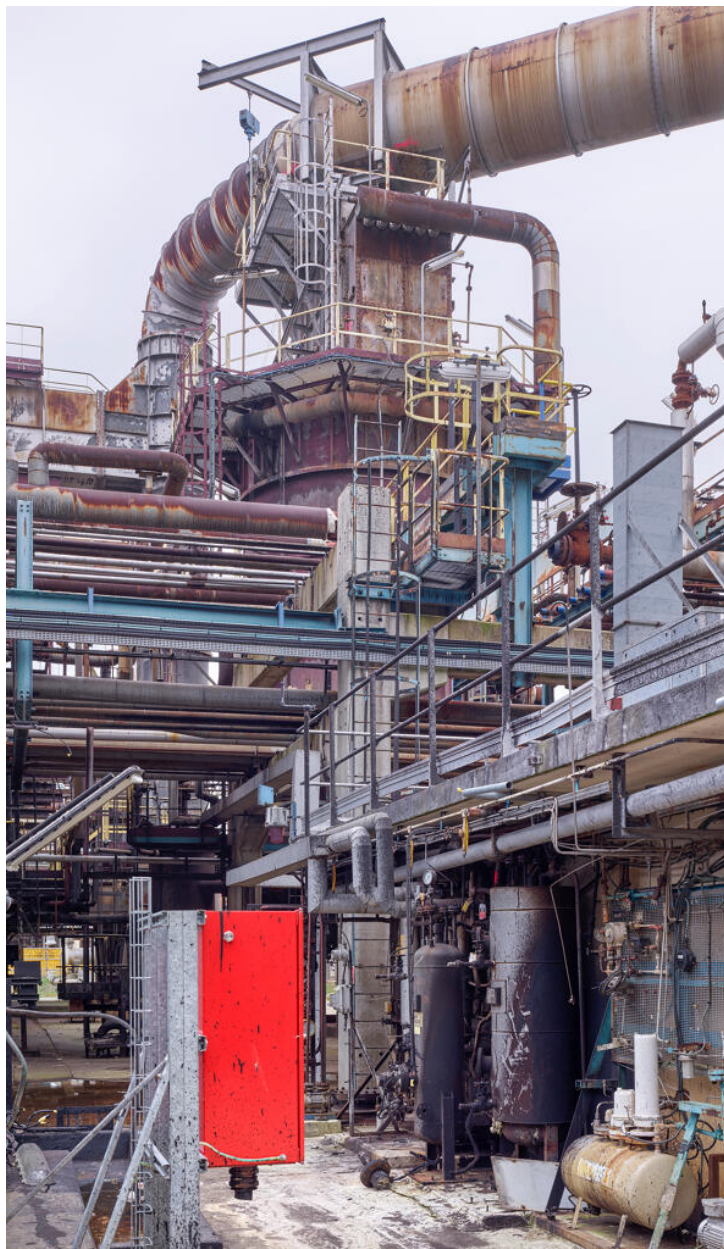
Unités Est - Zone FCC (Unité 651). Vue du four de l'alkylation situé sur la zone viscoréducteur.
