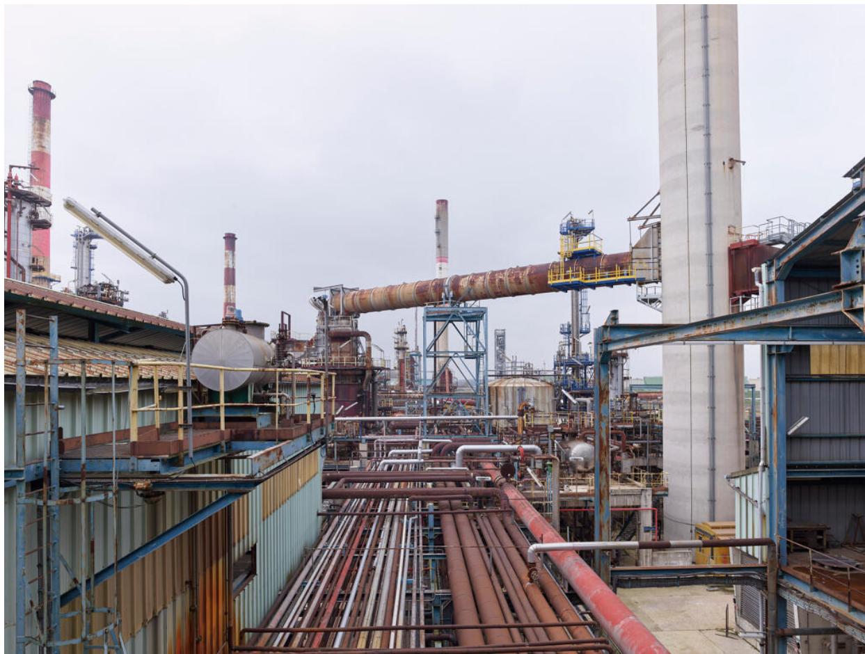
Unités Est - Zone FCC (Unité 651). Vue globale. À droite, entrée du compresseur K1001.
