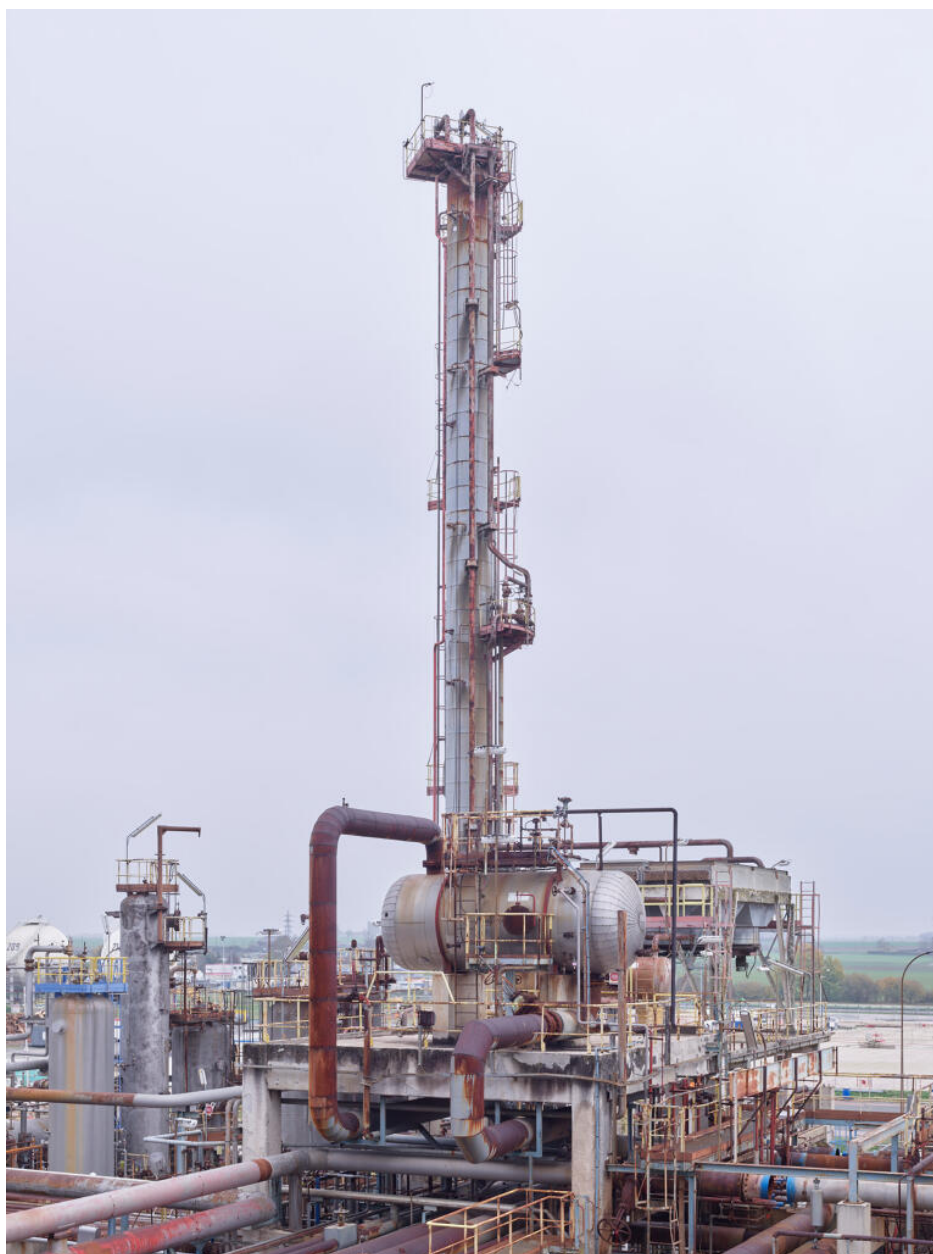
Unités Est - Zone FCC (Unité 651). Vue sur la colonne de préfractionnement, pour préparer la charge de l'alkylation.
