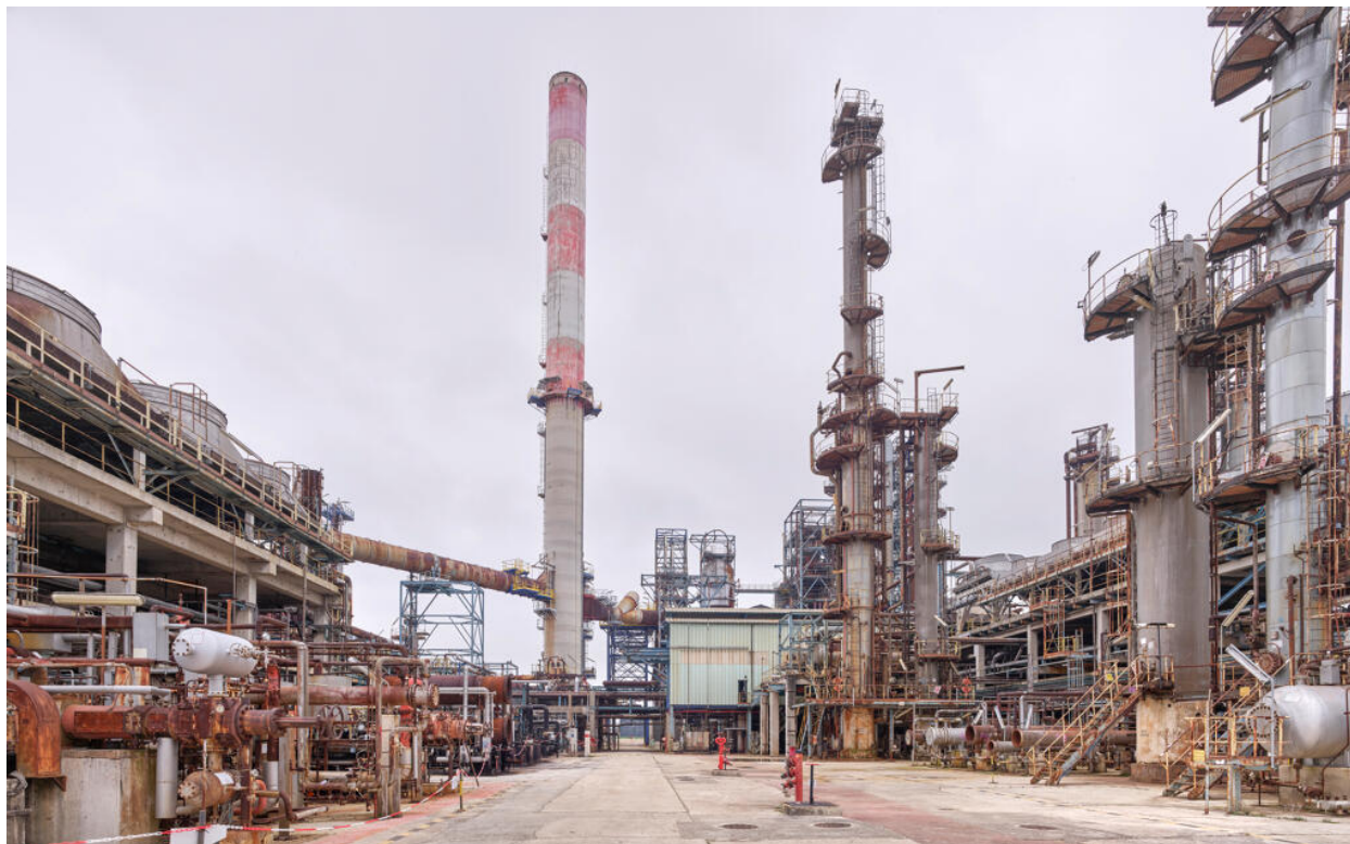
Unités Est - Allée de cheminement entre le viscoréducteur (Unité 691) et le FCC (Unité 651).
