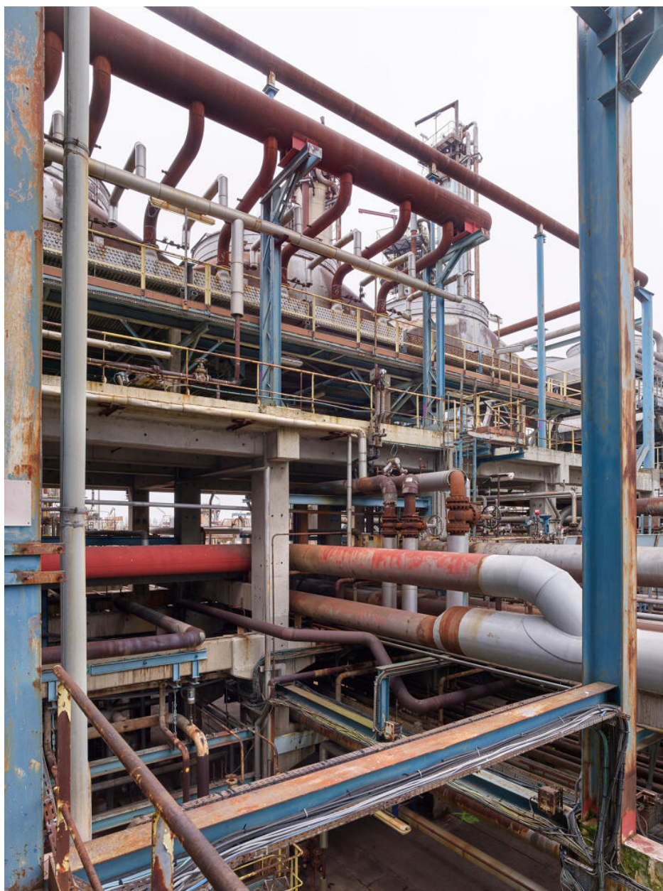
Unités Est - Zone FCC (Unité 651). Au premier plan, en rouge, ligne de torches (évacuation des gaz).
