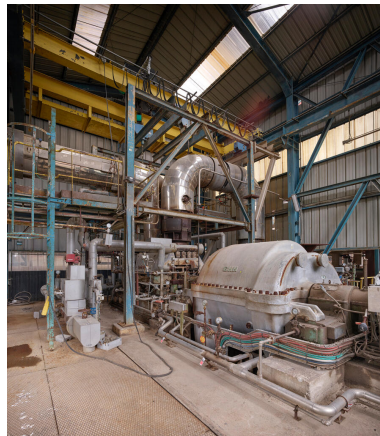
Unités Est - Zone FCC (Unité 651). Compresseur turbo-alternateur, autrement dit compresseur à récupération d'énergie. Phot. Stéphane Asseline, Phot. Stéphane Asseline IVR11_20237700213NUC4A
