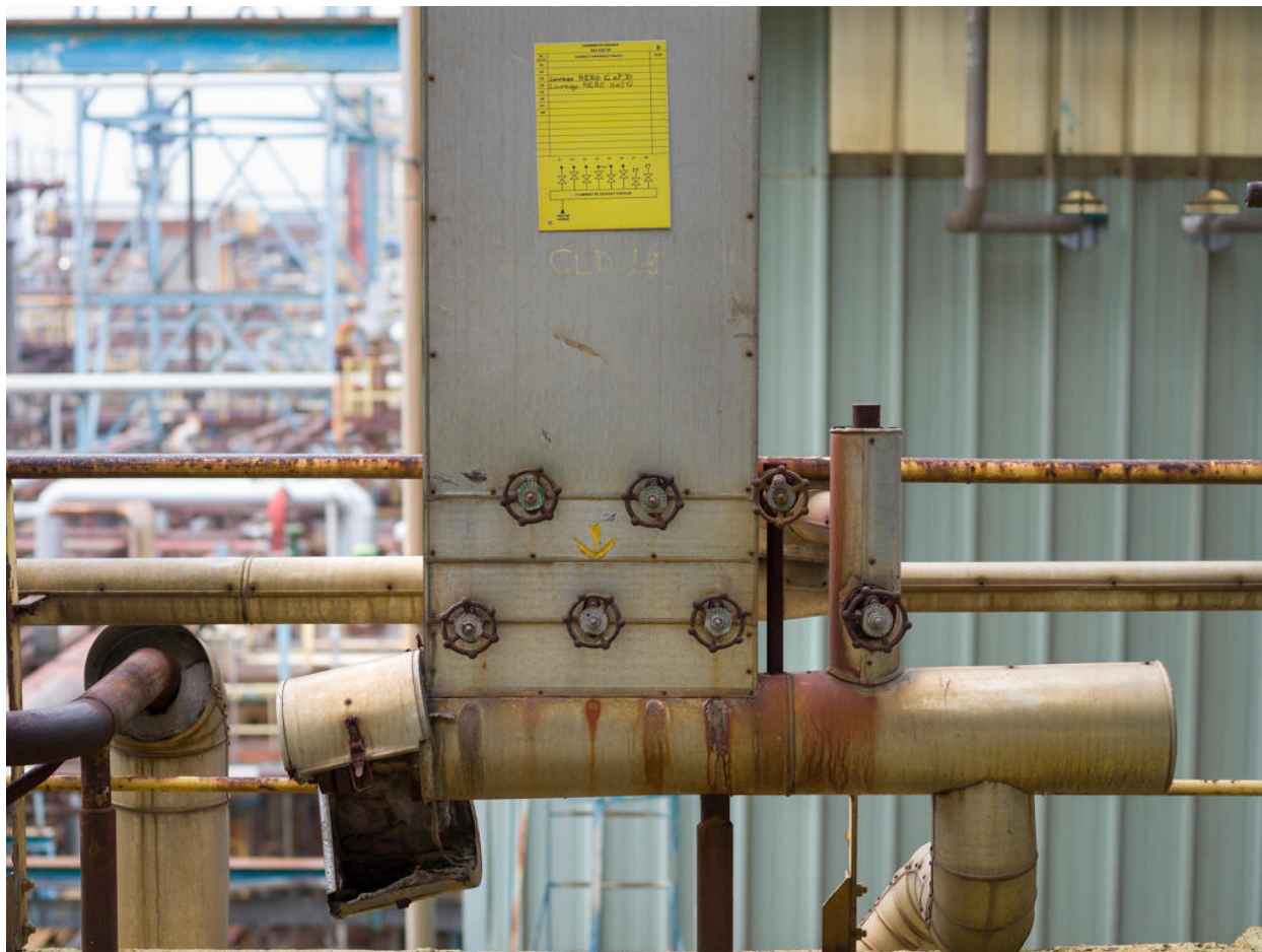
« Clarinette » de traceur vapeur destinée au réchauffement des tuyaux.
