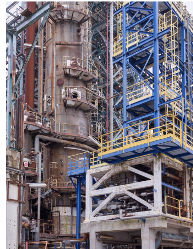
Unités Est - Zone FCC (Unité 651). Colonne de fractionnement primaire au centre, filtre PALL à droite qui permet d'enlever les particules fines liées au process.
