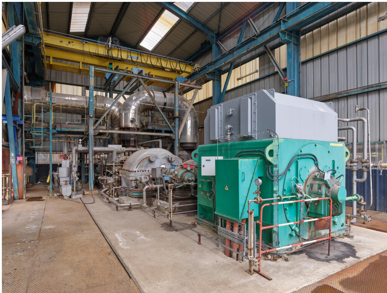
Unités Est - Zone FCC (Unité 651). Compresseur turbo-alternateur, autrement dit compresseur à récupération d'énergie.
