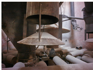
Unités Est - Zone FCC (Unité 651). Vue des râtaux d'air de fluidisation du catalyseur à l'intérieur du régénérateur du FCC. Phot. Stéphane Asseline, Phot. Stéphane Asseline IVR11_20237700277NUC4A
