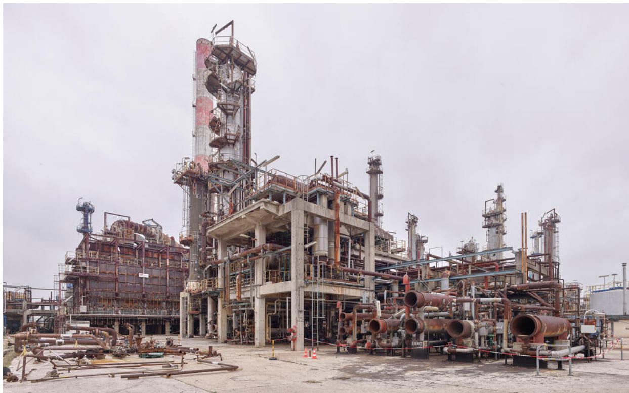
Unités Est - Zone viscoréducteurs (Unité 691). "Mis à zéro énergie" en prévision d'un démantèlement.
