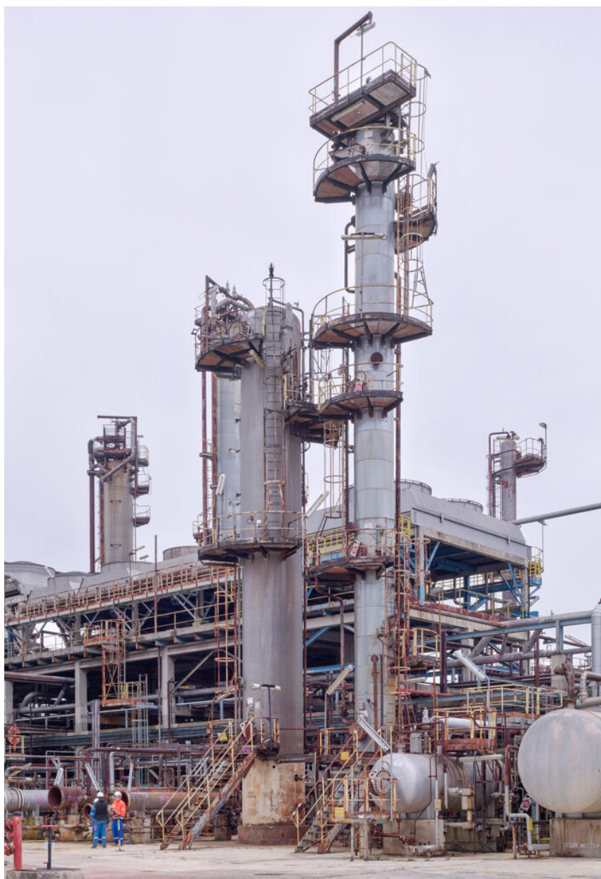
Unités Est - Zone FCC (Unité 651). Personnel à proximité des colonnes de lavage de DEA.
