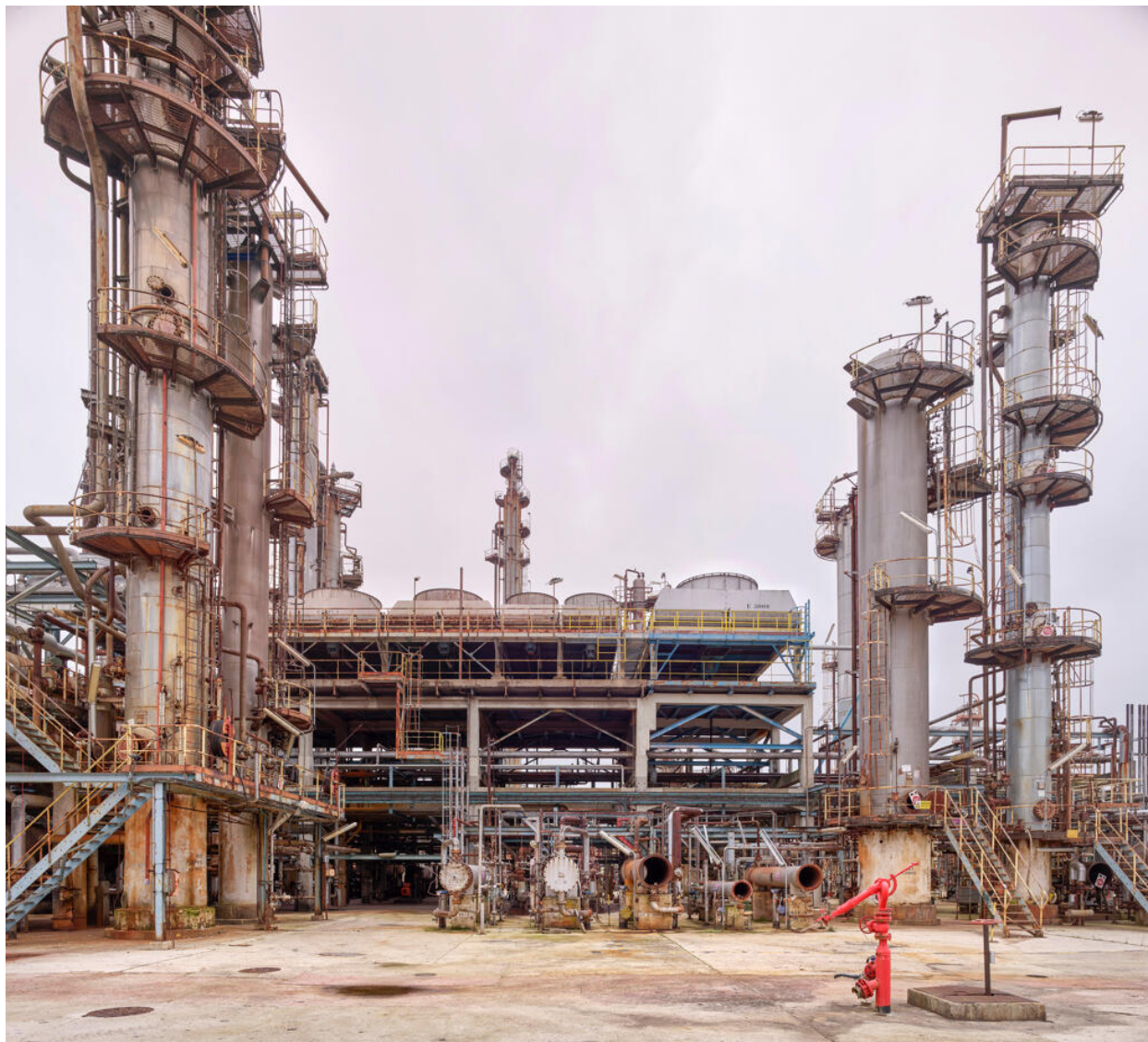
Unités Est - FCC (Unité 651). Absorbours. Première séparation gaz-essence.
