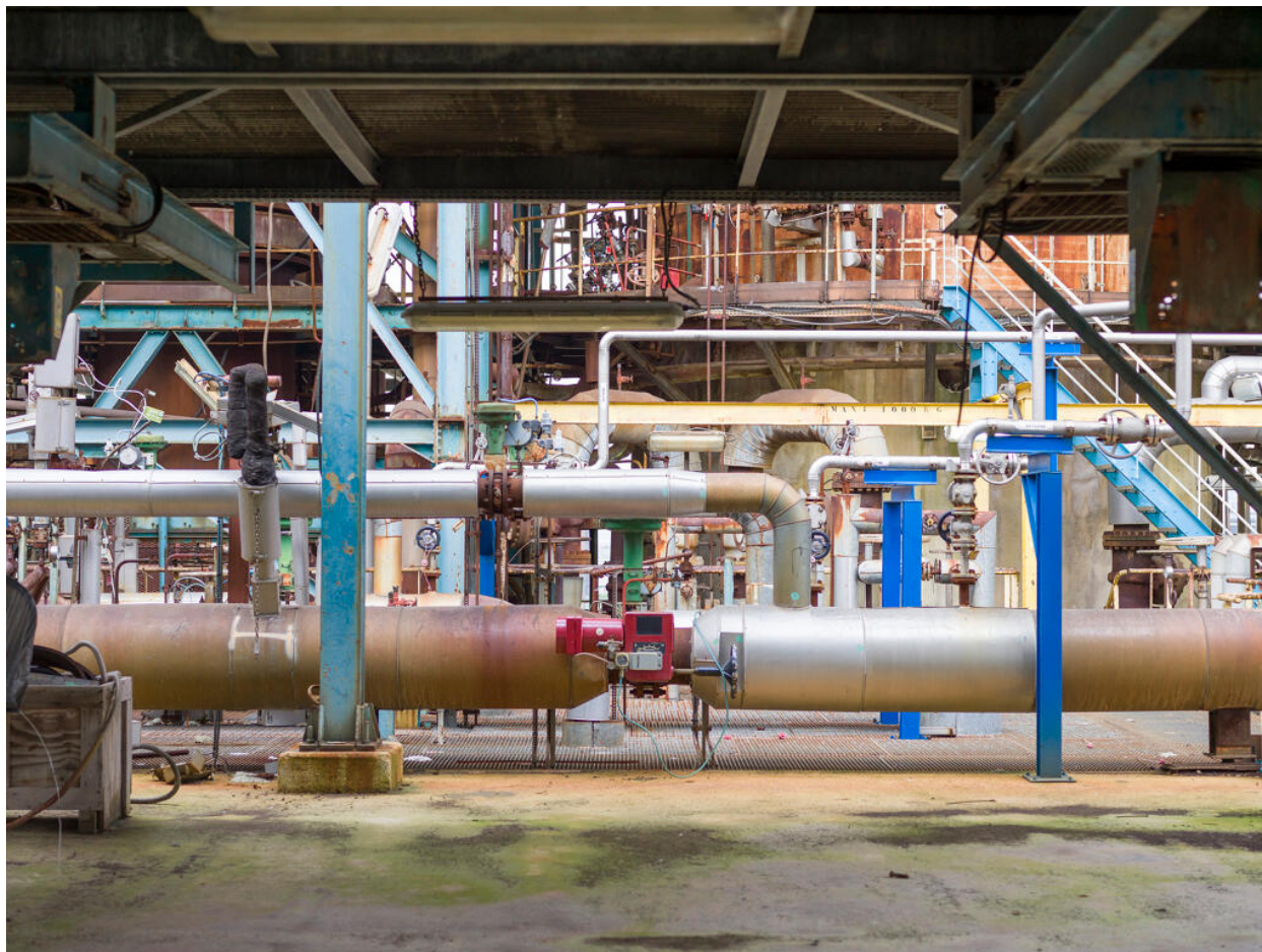
Unités Est - Zone FCC (Unité 651). Vanne automatique du circuit d'air de combustion du régénérateur du FCC (Unité 651).
