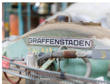
Unités Est - Zone FCC (Unité 651). Compresseur turbo-alternateur, autrement dit compresseur à récupération d'énergie. Plaque du fabricant Graffenstaden du coupleur. Phot. Hourdebaigt Cindy IVR11_20237700216NUC4A
