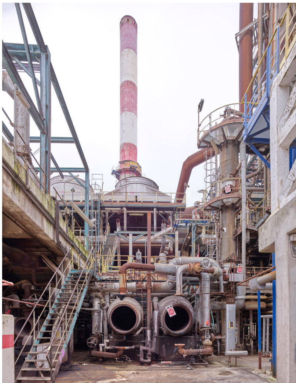
Unités Est - Zone FCC (Unité 651). Echangeurs "mis à zéro énergie", avant démantèlement.
