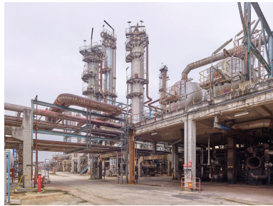
Unités Est - Zone FCC (Unité 651). Allée de cheminement entre le FCC l'Unité Mercox (oxydation des essences et GPL).
