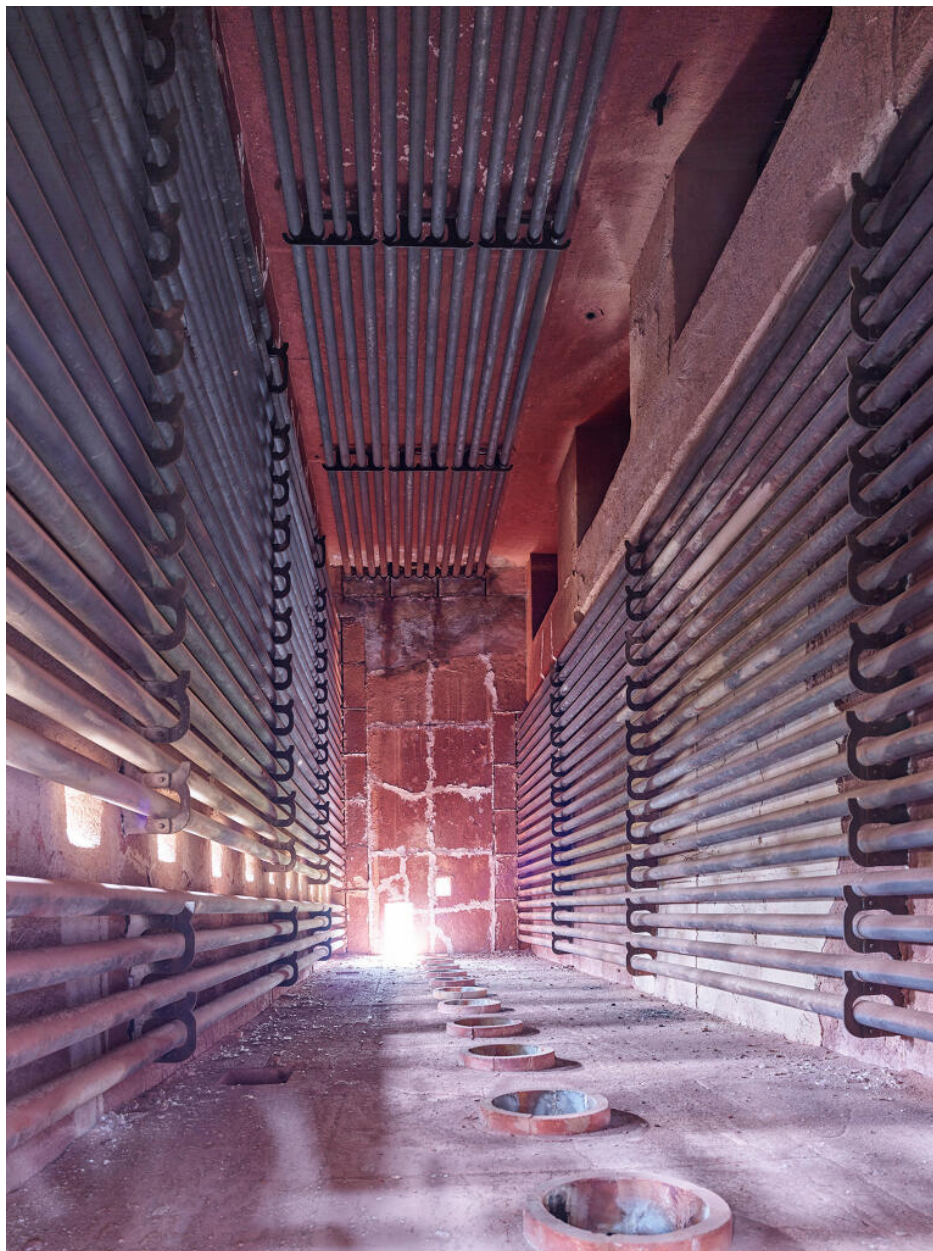
Unités Est - Zone du viscoréducteur (Unité 691). Vue intérieure du four de l'unité. Le produit à réchauffer circule dans les tubes, les brûleurs sont en bas.
