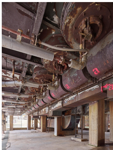
Unités Est - Zone du viscoréducteur (Unité 691). Vue globale du four de l'unité. Vue d'une partie (11 sur 24) des brûleurs du four du viscoréducteur. Phot. Stéphane Asseline, Phot. Stéphane Asseline IVR11_20237700289NUC4A
