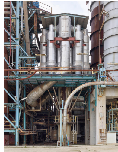
Vue globale des cyclones de récupération du catalyseur. (Unité FCC, 651). Les fumées chargées en catalyseur proviennent de la zone réactionnelle.
