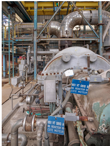
Unités Est - Zone FCC (Unité 651). Compresseur turbo-alternateur, autrement dit compresseur à récupération d'énergie. Phot. Stéphane Asseline, Phot. Stéphane Asseline IVR11_20237700212NUC4A
