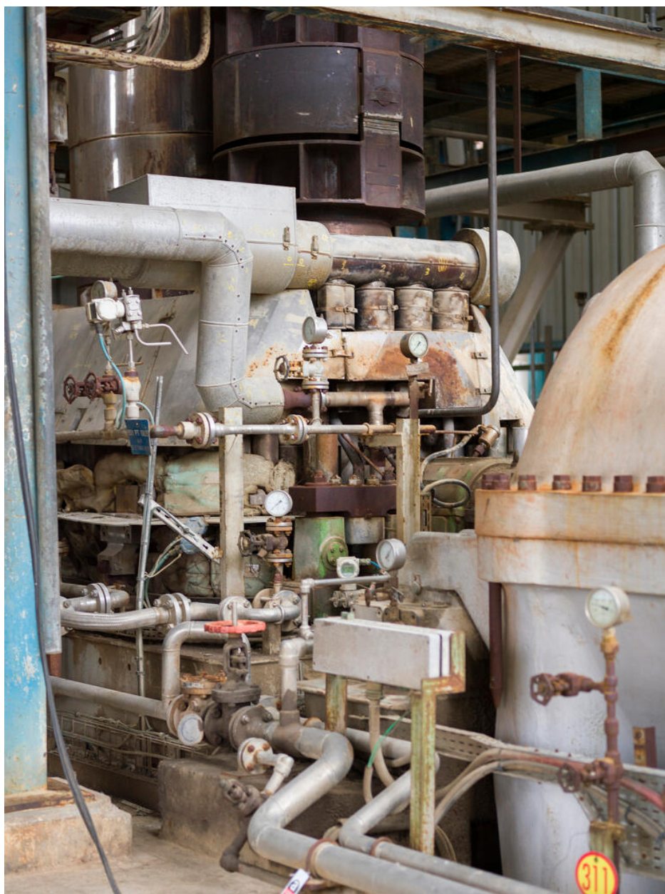
Unités Est - Zone FCC (Unité 651). Compresseur turbo-alternateur, autrement dit compresseur à récupération d'énergie. Vue de la turbine de récupération d'énergie, à gauche.
