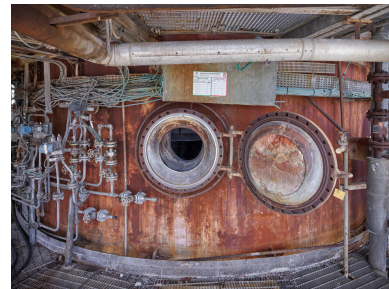
Unités Est - Zone FCC (Unité 651). Un des trous d'homme du régénérateur de FCC permettant la visite interne de l'équipement. Verrouillé en marche normale. Phot. Stéphane Asseline, Phot. Stéphane Asseline IVR11_20237700276NUC4A
