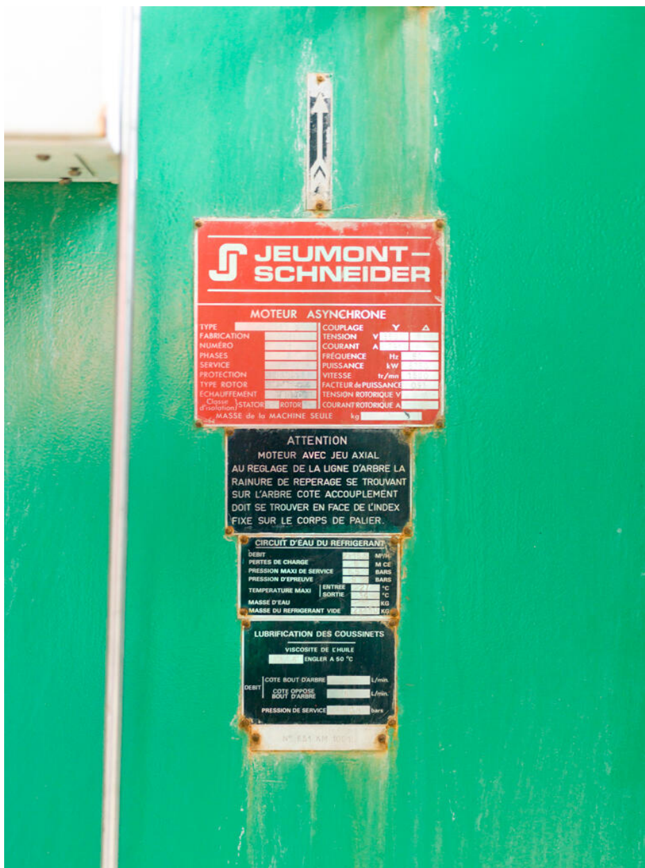
Unités Est - Zone FCC (Unité 651). Compresseur turbo-alternateur, autrement dit compresseur à récupération d'énergie. Plaque signalétique du moteur Jeumont-Schneider, utilisé pour le démarrage du compresseur.
