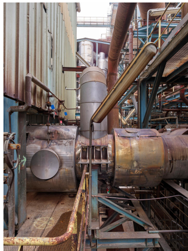
Unités Est - Zone FCC (Unité 651). Vanne "Adams" papillon servant à admettre les fumées dans la turbine du compresseur K1001. Phot. Stéphane Asseline, Phot. Stéphane Asseline IVR11_20237700228NUC4A
