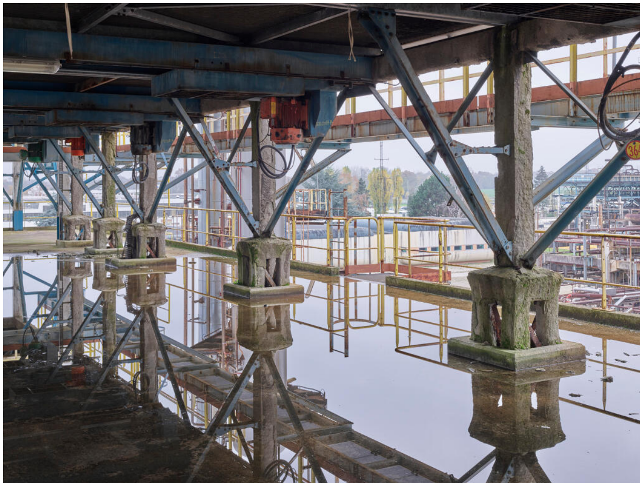
Unité Est - Plateforme des aéroréfrigérants EM 1001 sur l'unité 651. Vue par le dessous. En arrière plan, la salle de contrôle des unités.
