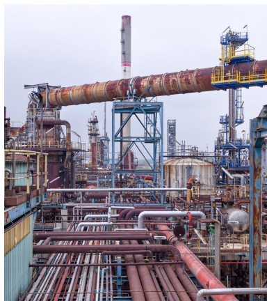
Unités Est - Zone FCC (Unité 651). Vue globale. À droite, entrée du compresseur K1001. Phot. Stéphane Asseline, Phot. Stéphane Asseline IVR11_20237700245NUC4A
