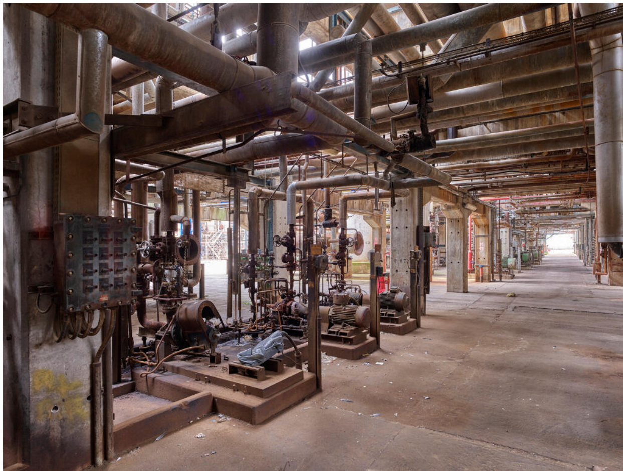
Unités Est - Zone FCC (Unité 651). Allée centrale du FCC avec vue sur les racks et à gauche, les pompes. En cours de démontage.
