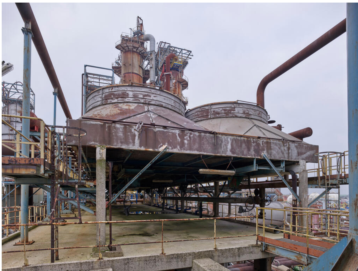
Unités Est - Zone FCC (Unité 651). Batterie complète des aéroréfrigérants EM 1001 sur l'unité FCC (Unité 651).
