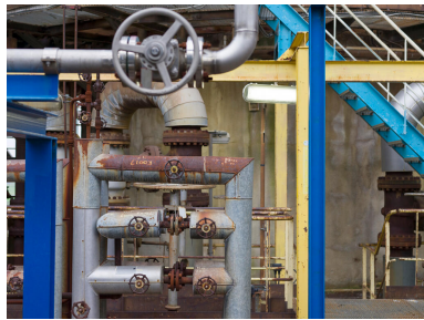
Unités Est - Zone FCC (Unité 651). Système de fluidisation et d'apport en oxygène pur pour le régénérateur du FCC (Unité 651) Phot. Hourdebaigt Cindy IVR11_20237700260NUC4A
