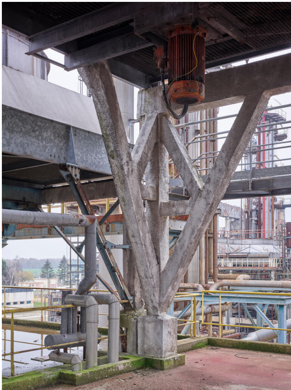
Unité Est - Vue du viscoréducteur (Unité 691) depuis la plateforme des aéroréfrigérants EM 1001 de l'unité 651.
