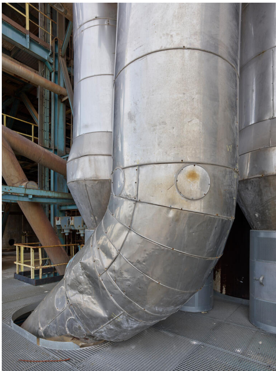
Unités Est - Zone FCC (Unité 651). Conduite de fumées alimentant les cyclones de récupération du catalyseur.
