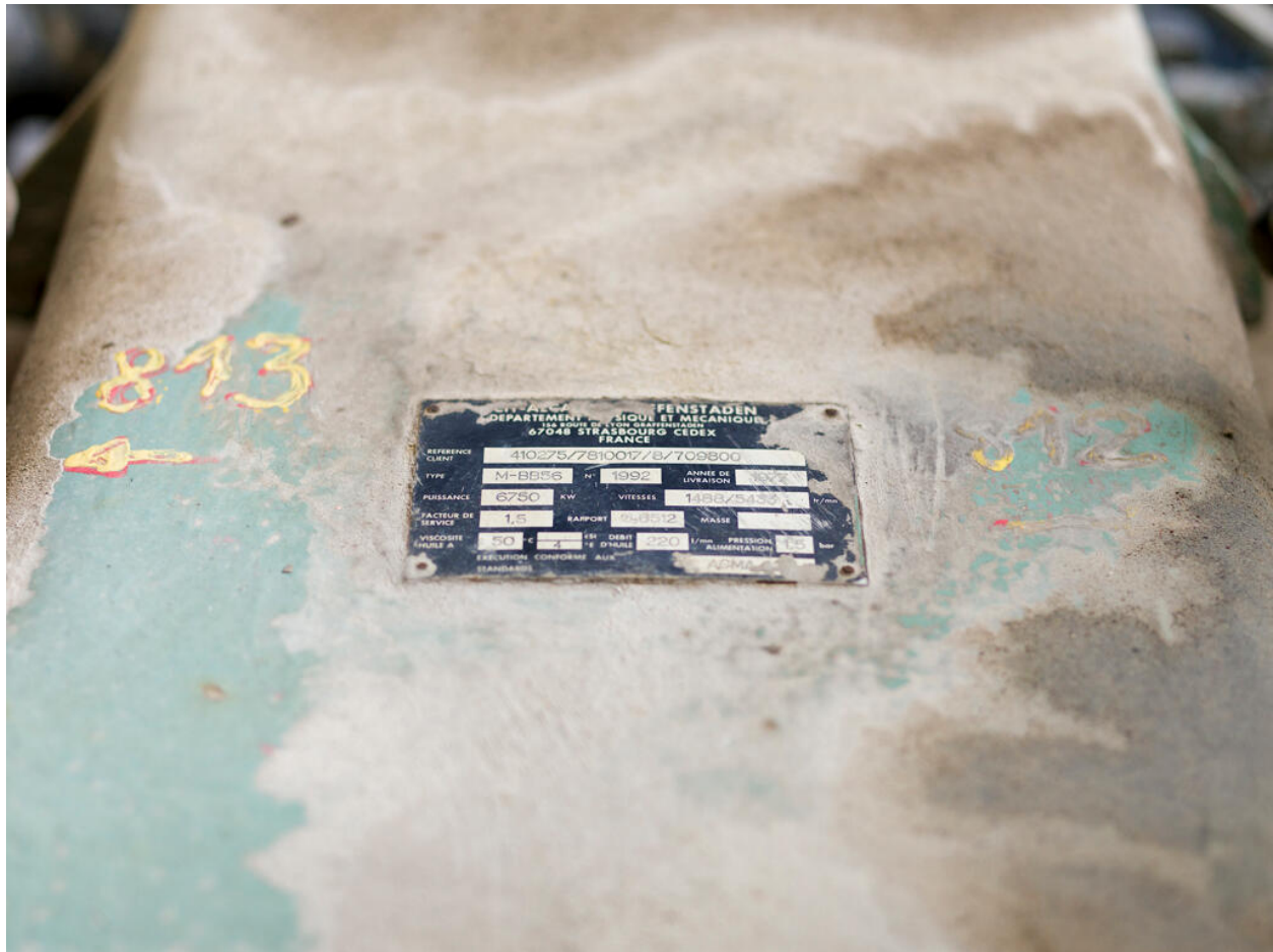
Unités Est - Zone FCC (Unité 651). Compresseur turbo-alternateur, autrement dit compresseur à récupération d'énergie. Plaque signalétique du réducteur Graffenstaden.
