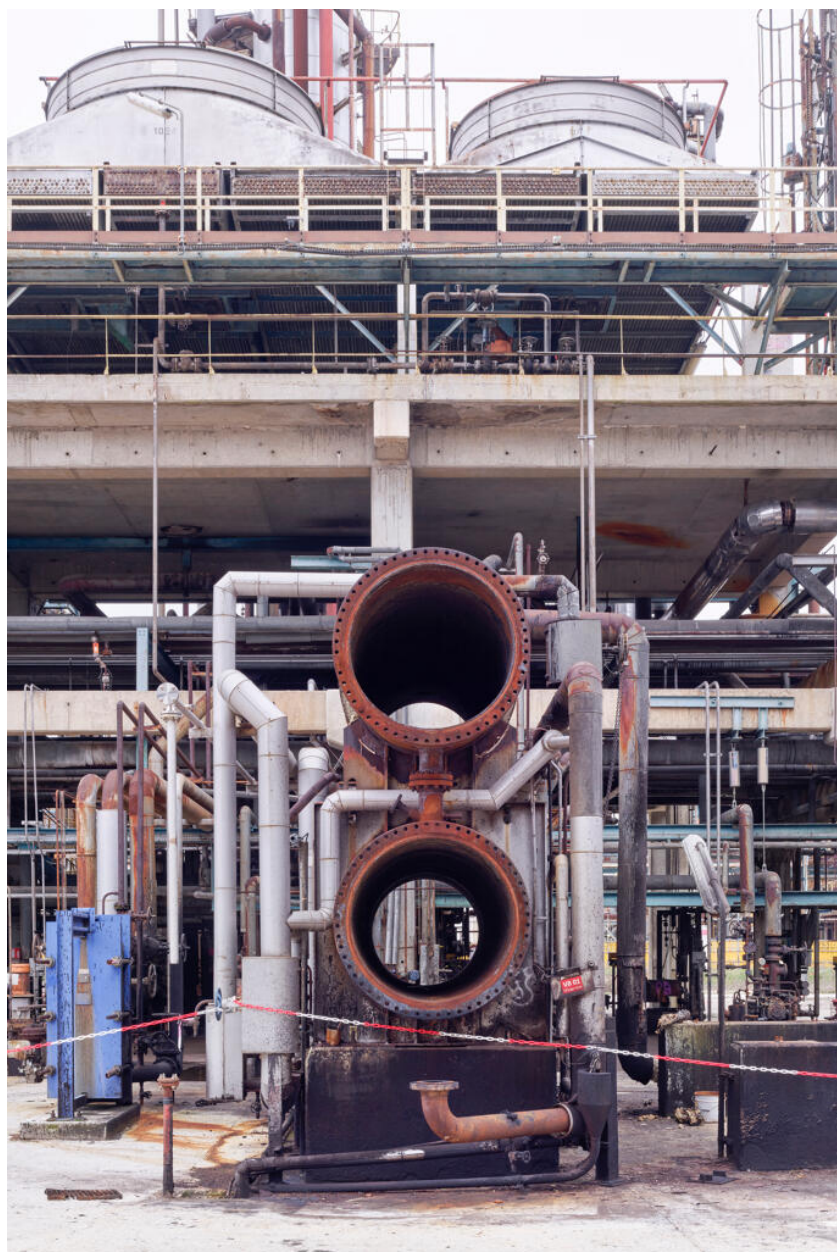
Unités Est - Zone FCC (Unité 651). Echangeurs "mis à zéro énergie", avant démantèlement.
