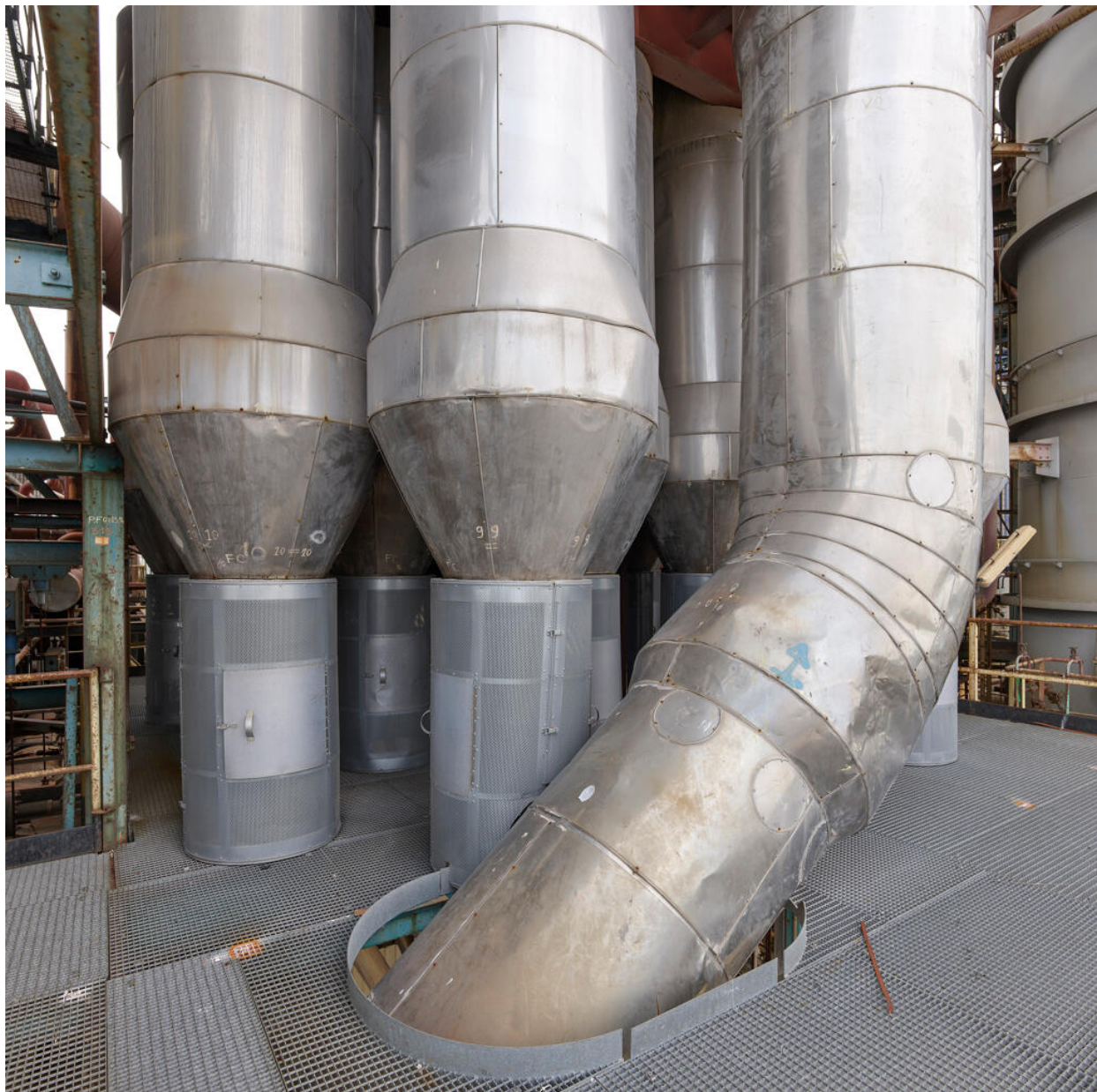
Unités Est - Zone FCC (Unité 651). Cyclones de récupération du catalyseur. Les fumées chargées en catalyseur proviennent de la zone réactionnelle.
