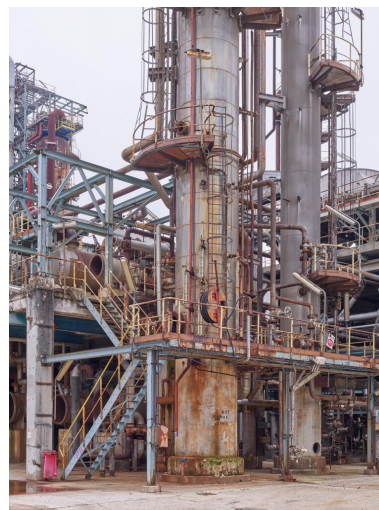
Unités Est - Zone FCC (Unité 651). Colonnes C2001 et C2002 (l'une sur l'autre) à gauche, et à droite, la C2003 : les "absorbants". Les C2001 et C2002 sont des colonnes de séparation essence-gaz ; avec "stripage" d'H 2 S (séparation de l'H 2 S des hydrocarbures). La C2003 est un absorbeur secondaire (séparation gaz-hydrocarbures). Phot. Stéphane Asseline, Phot. Stéphane Asseline IVR11_20237700203NUC4A
