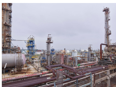
Unités Est - Zone FCC (Unité 651). Vue générale. Phot. Stéphane Asseline, Phot. Stéphane Asseline IVR11_20237700239NUC4A
