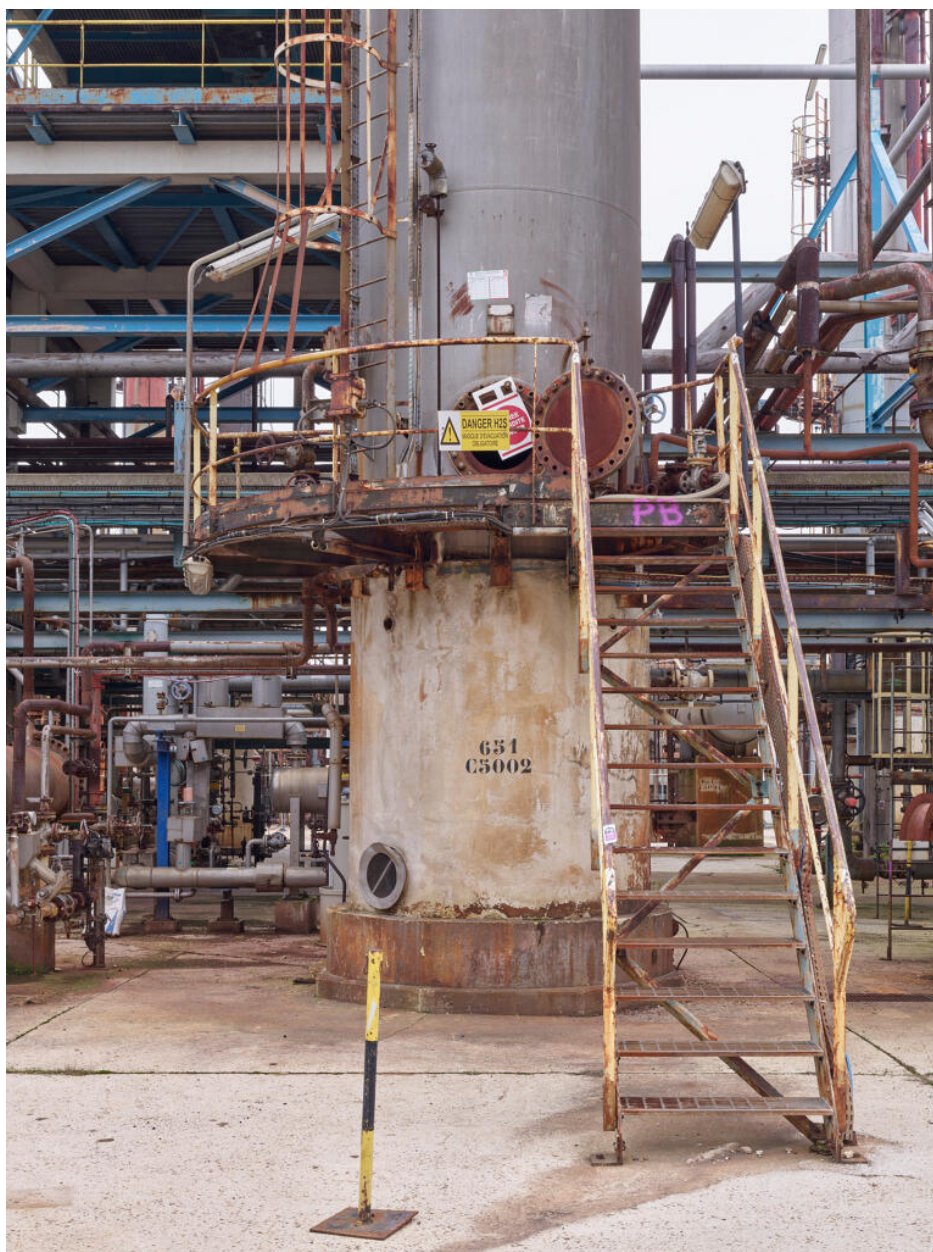
Unités Est - Zone FCC (Unité 651). C50002, colonne de lavage à la DEA des GPL.
