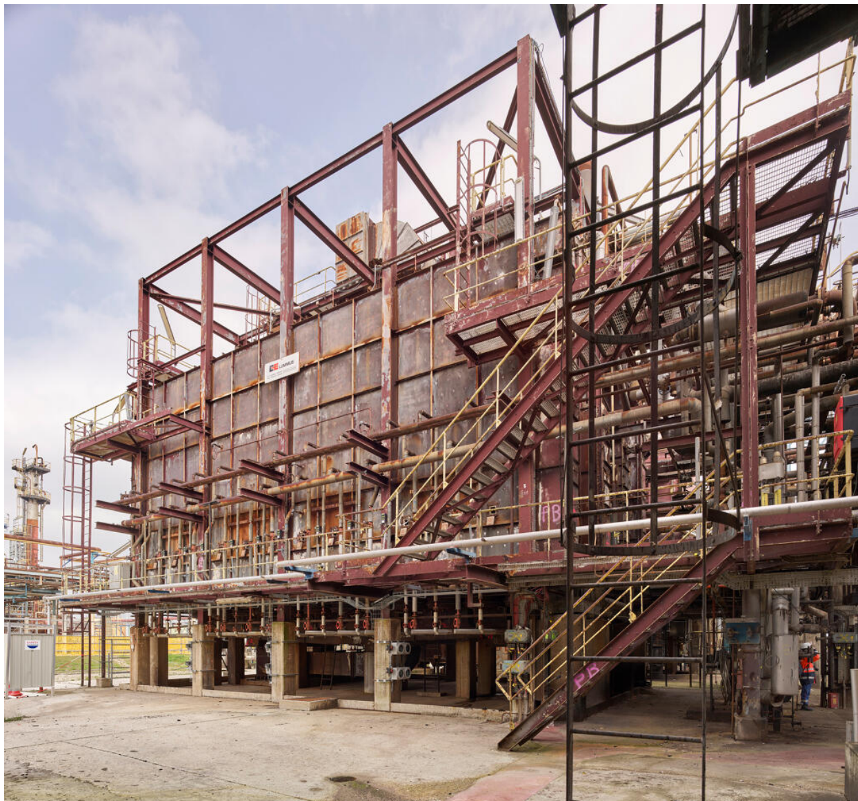
Unités Est - Zone du viscoréducteur (Unité 691). Vue globale du four de l'unité depuis le sud-ouest.
