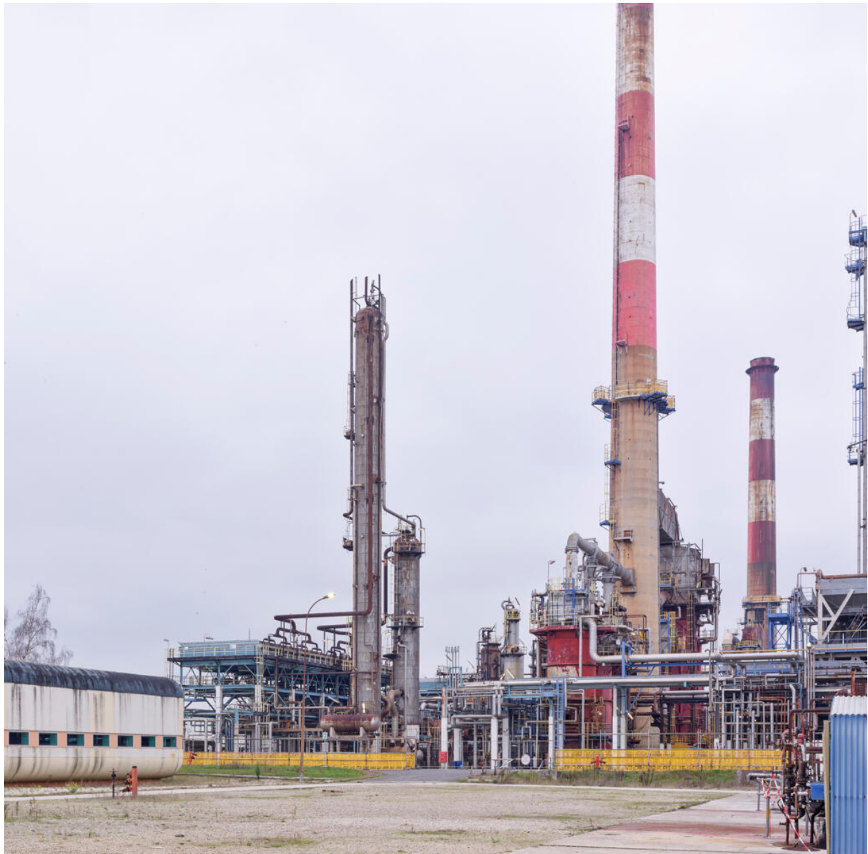
Unités Est - Zone viscoréducteur (Unité 691). Vue générale du viscoréducteur à droite. Au fond, les Unités Ouest. À gauche, la salle de contrôles.
