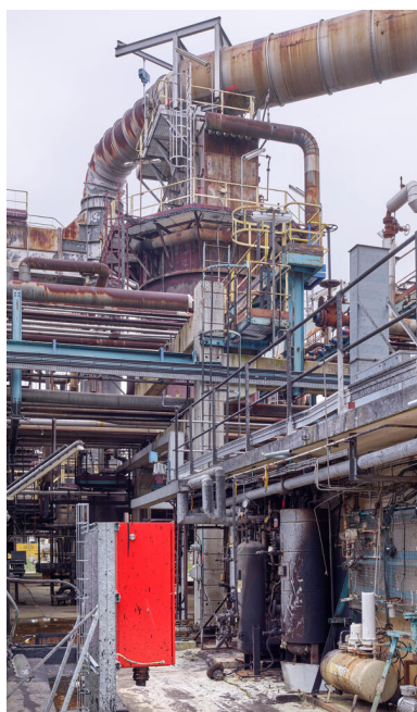
Unités Est - Zone FCC (Unité 651). Vue du four de l'alkylation situé sur la zone viscoréducteur.
