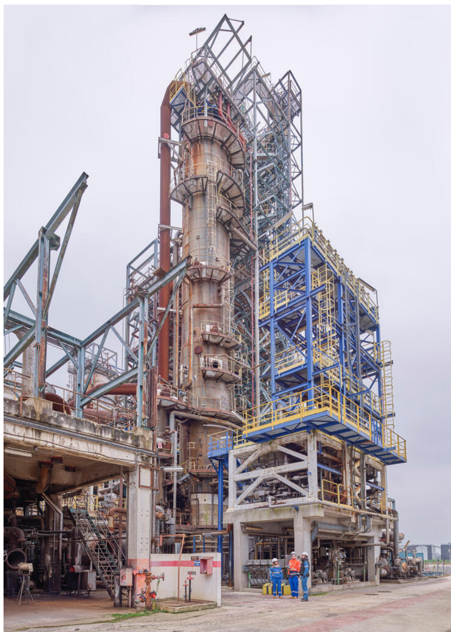
Unités Est - Zone FCC (Unité 651). Colonne de fractionnement primaire au centre, filtre PALL à droite qui permet d'enlever les particules fines liées au process.
