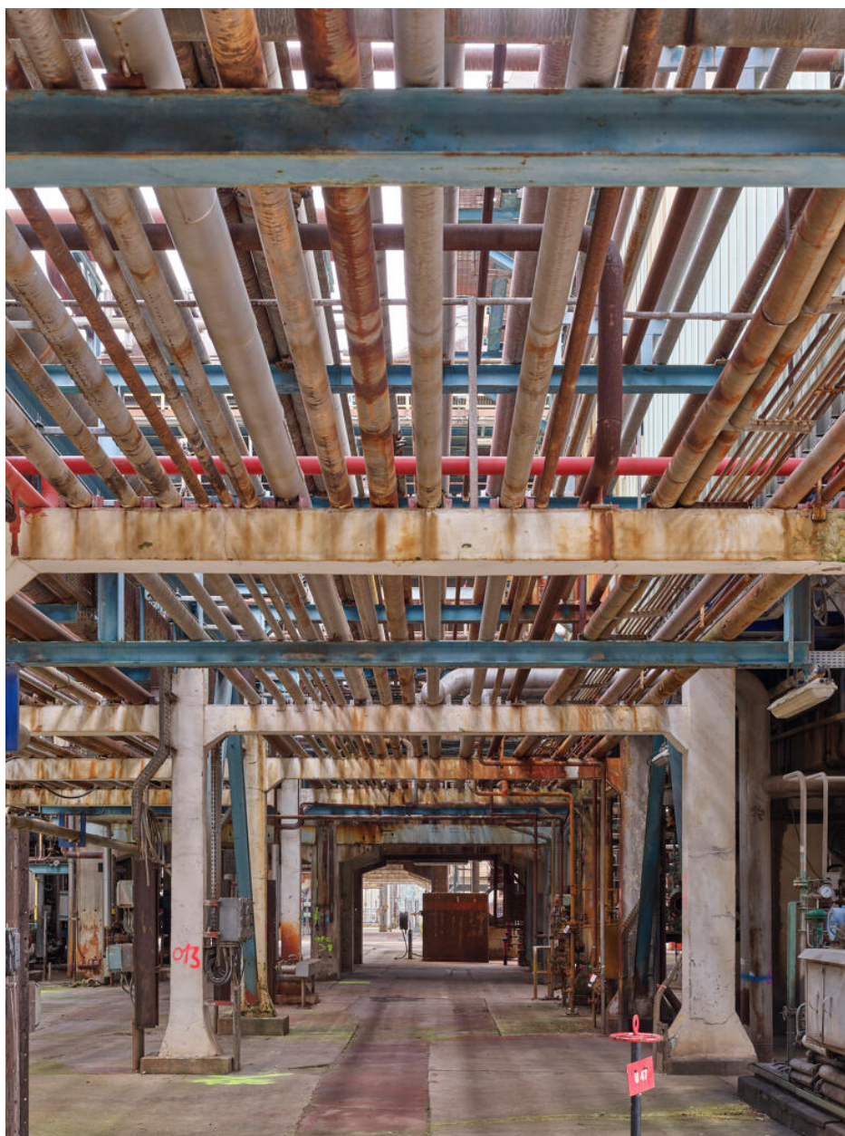
Unités Est - Zone FCC (Unité 651). Allée centrale. Racks de tuyaux permettant le transfert des différents produits au sein de l'Unité ou entre les Unités.
