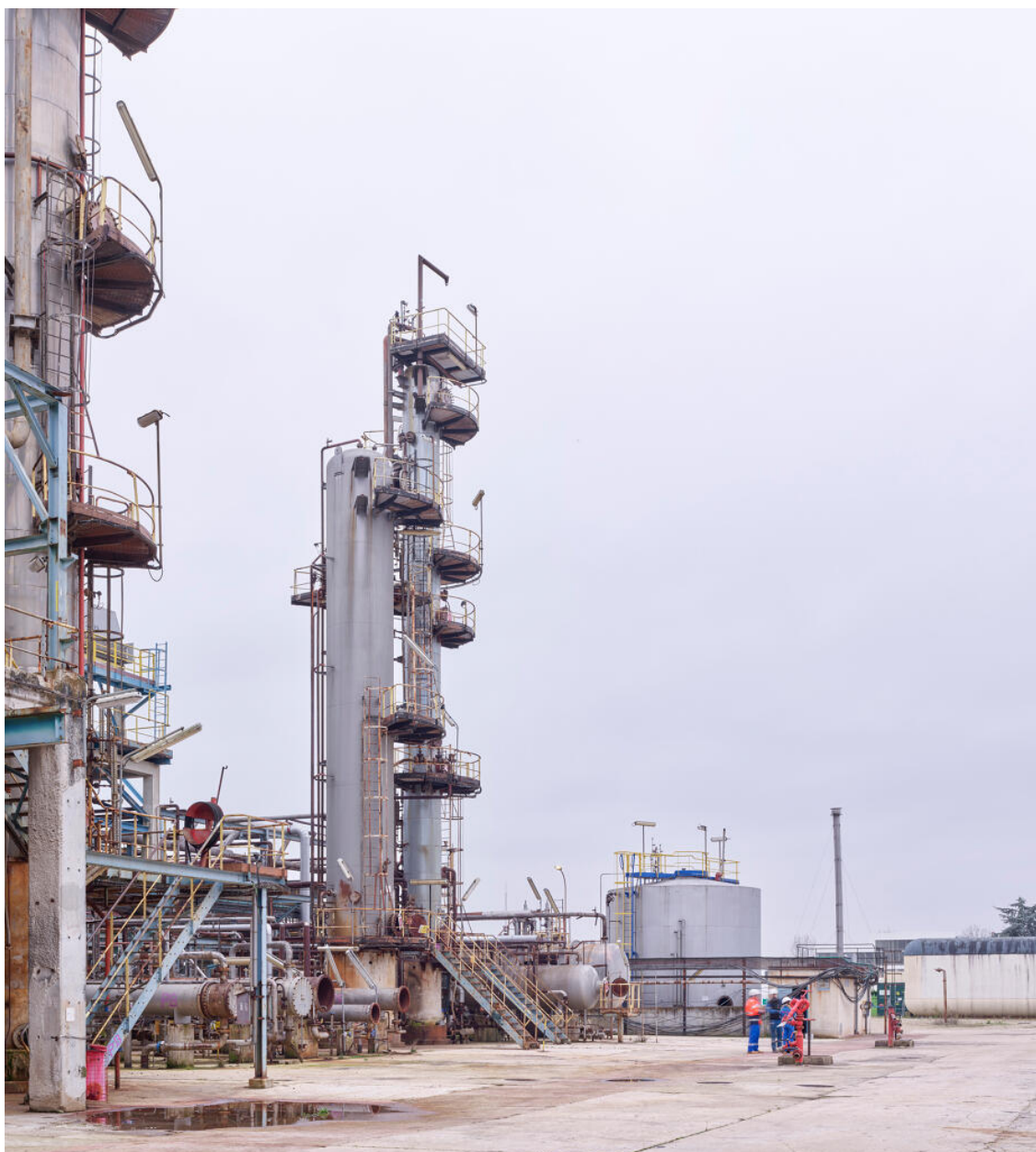
Unités Est - Zone FCC (Unité 651). Colonnes de lavage de la DEA. À l'arrière D6003, ballon de stockage.
