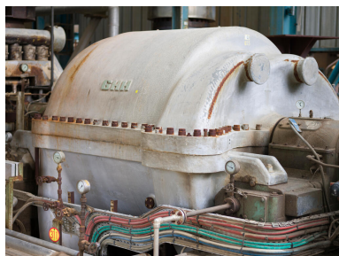
Unités Est - Zone FCC (Unité 651). Compresseur turbo-alternateur, autrement dit compresseur à récupération d'énergie. Vue du compresseur. Les manomètres permettent de vérifier la pression du circuit d'huile de lubrification. Phot. Hourdebaigt Cindy IVR11_20237700221NUC4A
