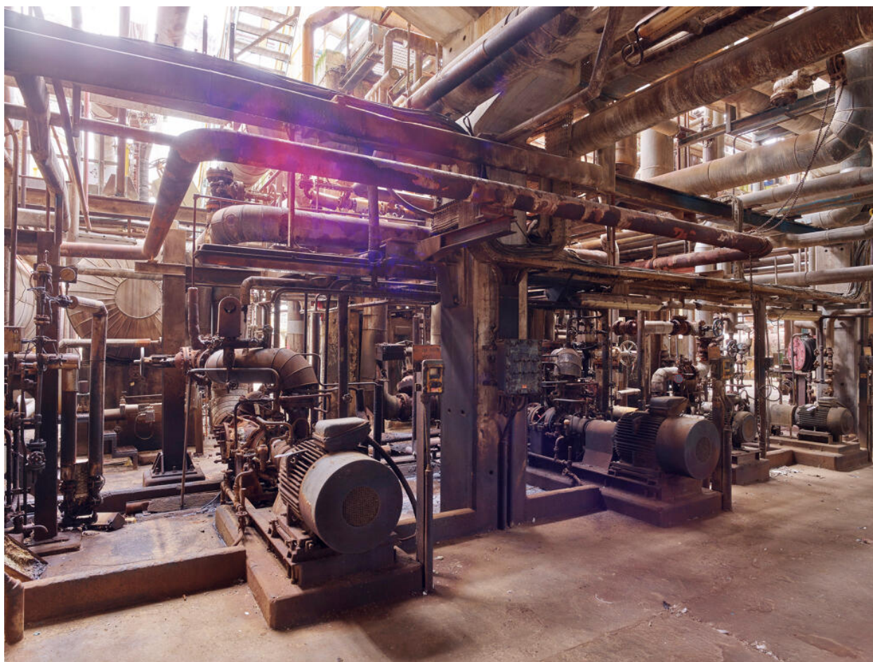
Unités Est - Zone FCC (Unité 651). Pompes utilisées pour transférer un produit d'une capacité à une autre.
