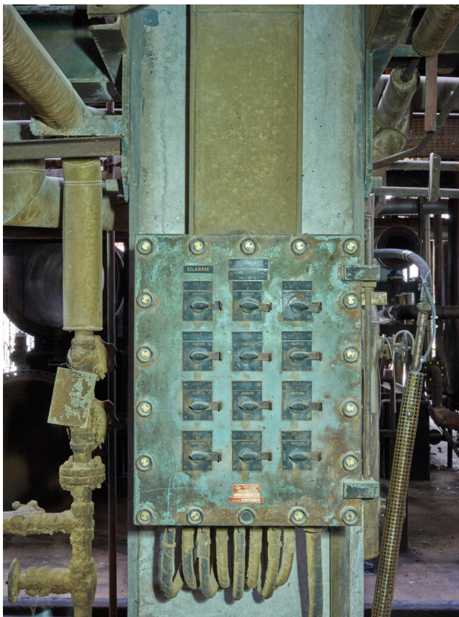
Unités Est - Zone FCC (Unité 651). Tableau de commandes des éclairages.
