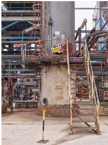
Unités Est - Zone FCC (Unité 651). C50002, colonne de lavage à la DEA des GPL. Phot. Stéphane Asseline, Phot. Stéphane Asseline IVR11_20237700202NUC4A
