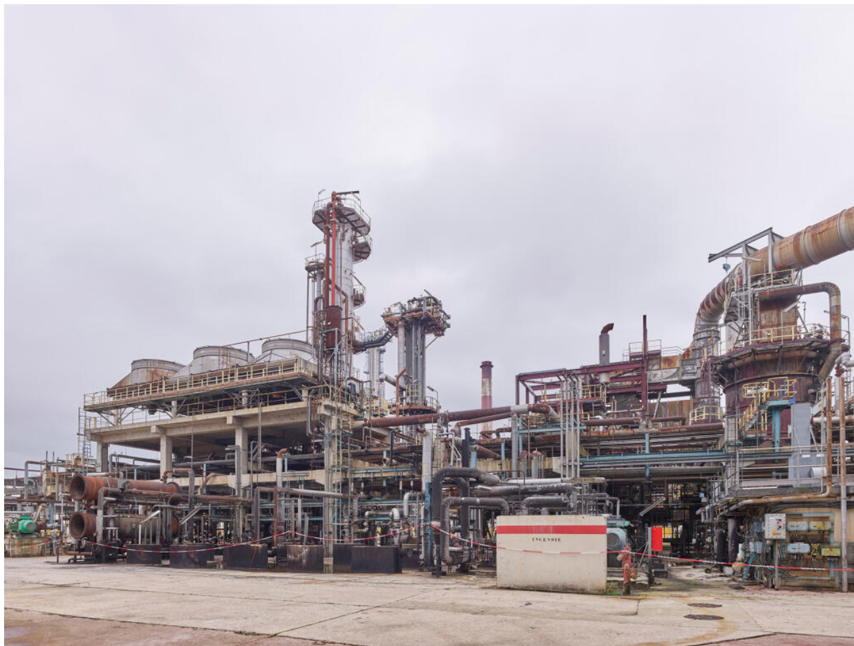
Unités Est - Zone viscoréducteur (Unité 691). Vue générale du viscoréducteur avec à gauche, les aéroréfrigérants et à droite, les fours.
