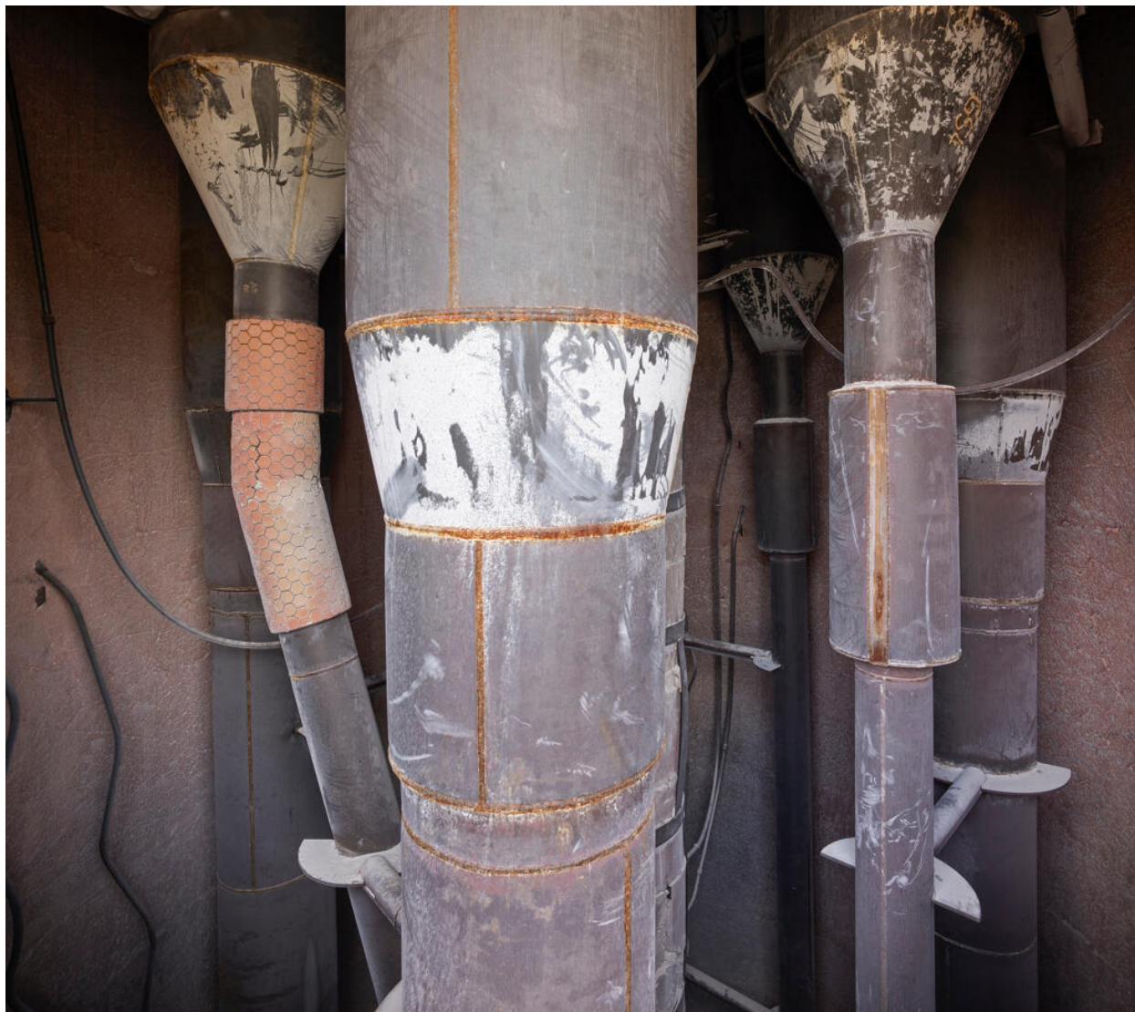
Unités Est - Zone FCC (Unité 651). Jambes de circulation du catalyseur à l'intérieur de la zone réactionnelle.
