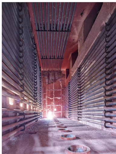
Unités Est - Zone du viscoréducteur (Unité 691). Vue intérieure du four de l'unité. Le produit à réchauffer circule dans les tubes, les brûleurs sont en bas. Phot. Stéphane Asseline, Phot. Stéphane Asseline IVR11_20237700292NUC4A
