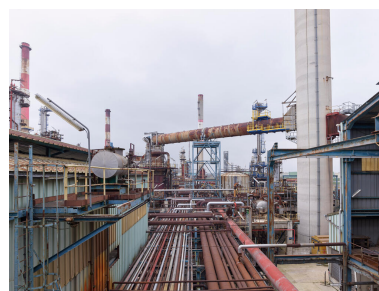
Unités Est - Zone FCC (Unité 651). Vue globale. À droite, entrée du compresseur K1001. Phot. Stéphane Asseline, Phot. Stéphane Asseline IVR11_20237700244NUC4A
