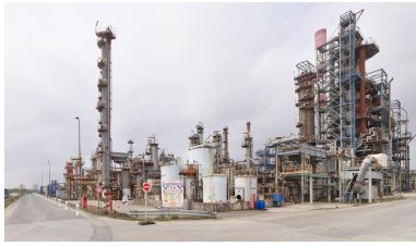
Vue de l'unité alkylation depuis l'angle nord-est de l'avenue 3 bis. Au premier plan , le préfractionneur de l'unité alkylation (traitement à la soude), au second plan l'alkylation (Unité 761), et à droite le FCC (Unité 651).
