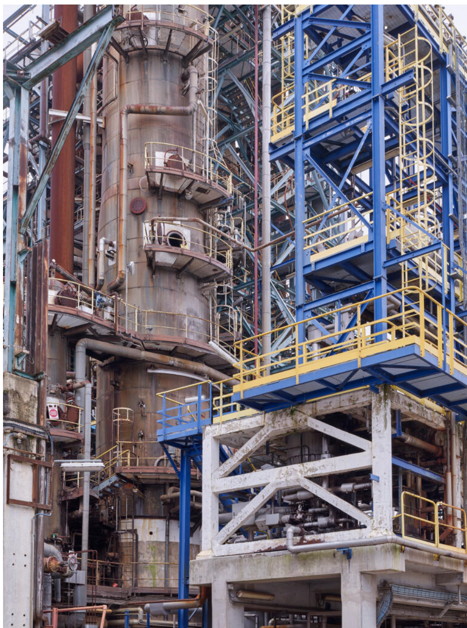
Unités Est - Zone FCC (Unité 651). Colonne de fractionnement primaire au centre, filtre PALL à droite qui permet d'enlever les particules fines liées au process.
