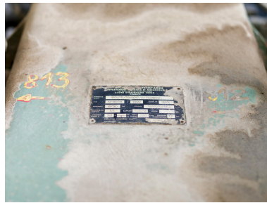
Unités Est - Zone FCC (Unité 651). Compresseur turbo- alternateur, autrement dit compresseur à récupération d'énergie. Plaque signalétique du réducteur Graffenstaden. Phot. Hourdebaigt Cindy IVR11_20237700219NUC4A
