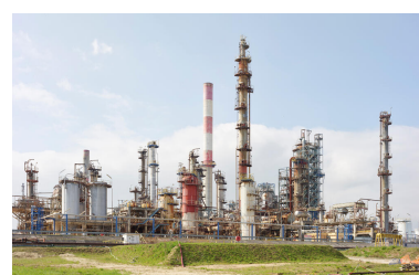
Unités Est - Zone alkylation (Unité 761). Vue générale. Transformation des GPL à l'aide d'un acide en essence à très haut indice d'octane. Phot. Stéphane Asseline IVR11_20237700185NUC4A
