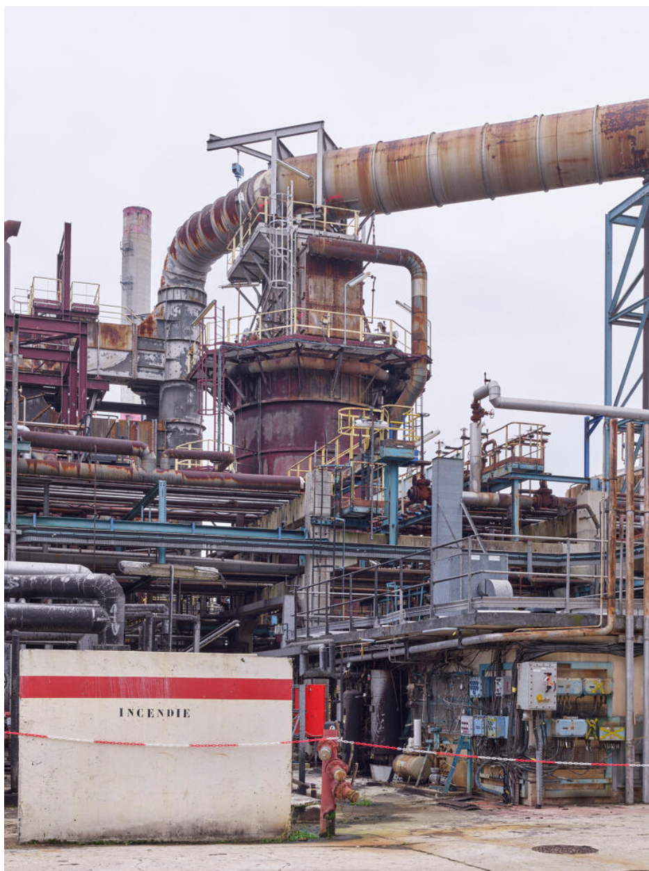
Unités Est - Zone FCC (Unité 651). Vue du four de l'alkylation situé sur la zone viscoréducteur.
