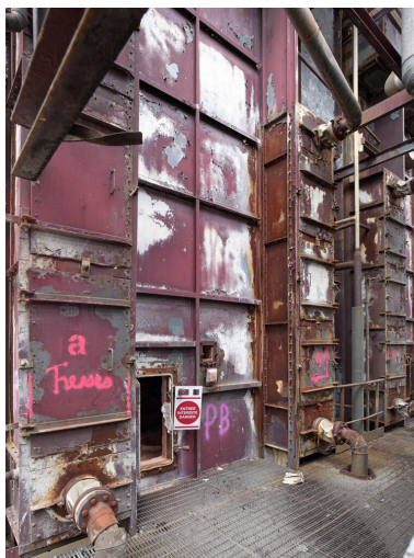
Unités Est - Zone du viscoréducteur (Unité 691). Porte d'entrée vers une cellule du four de l'unité. Phot. Stéphane Asseline, Phot. Stéphane Asseline IVR11_20237700290NUC4A
