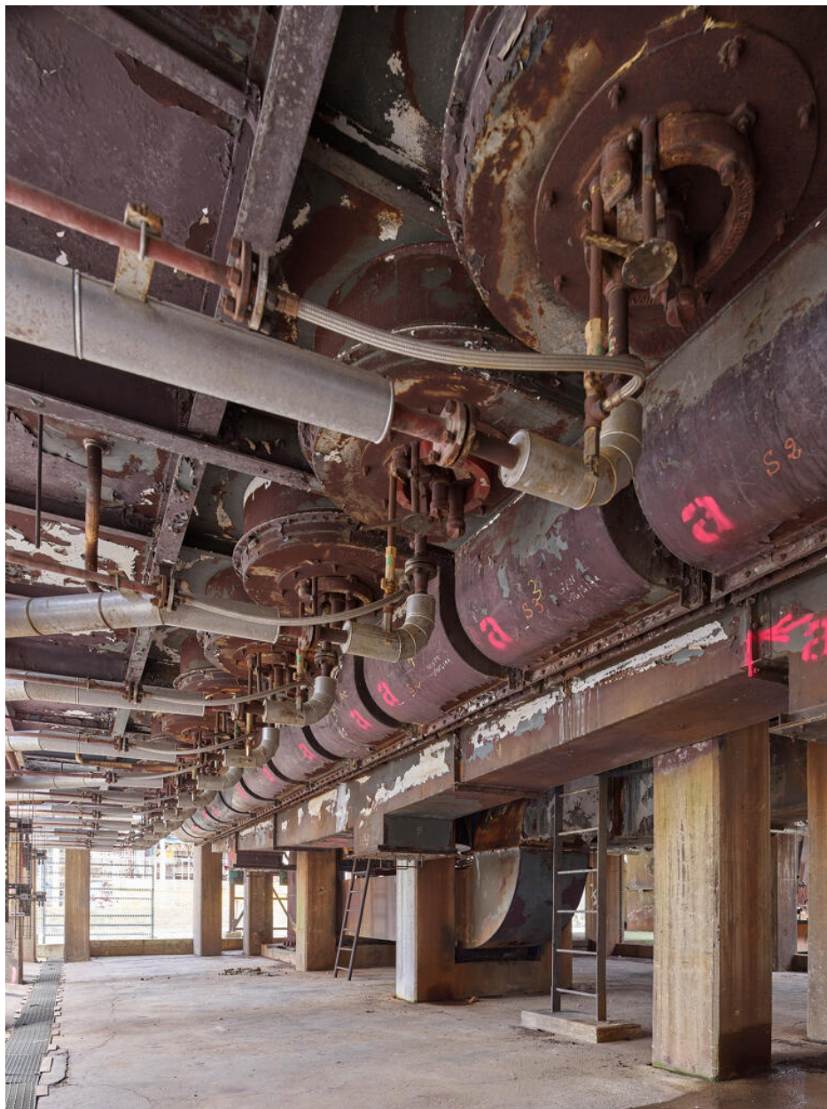
Unités Est - Zone du viscoréducteur (Unité 691). Vue globale du four de l'unité. Vue d'une partie (11 sur 24) des brûleurs du four du viscoréducteur.
