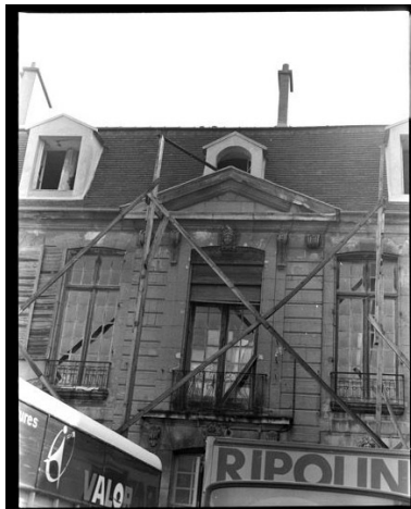
Vue de la façade sur cour alors en travaux. Phot. Pascal Corbière IVR11_19777800845X
