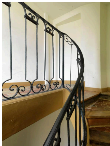
L'escalier secondaire qui se trouve dans l'aile droite a conservé partiellement ses balustres en ferronnerie. Les balustres de bois ont été remplacés. Phot. Laurent Kruszyk IVR11_20177800840NUC4A
