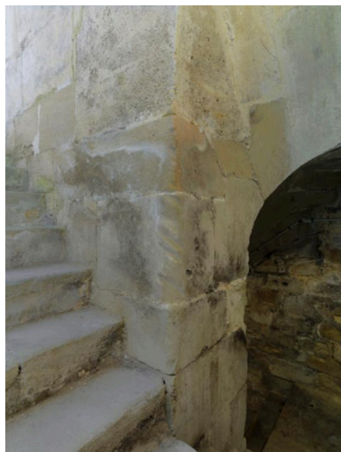
Premier demi-palier de la descente de cave. On distingue l'usure faite par les cordes à l'angle du mur. Phot. Laurent Kruszyk IVR11_20177800837NUC4A
