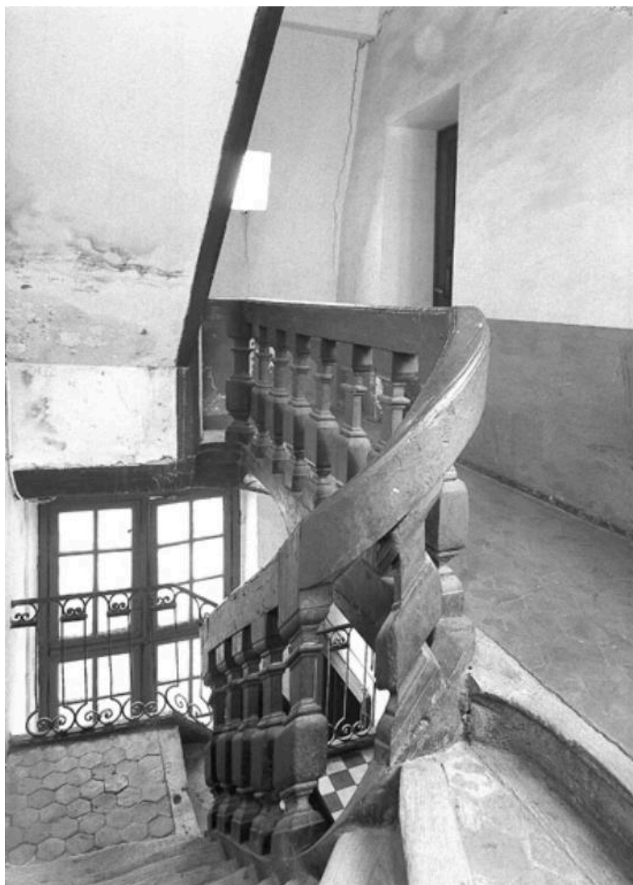
L'escalier secondaire comportait des gardes-corps en ferronnerie du côté du vide des fenêtres. (Fonds Bertin).
