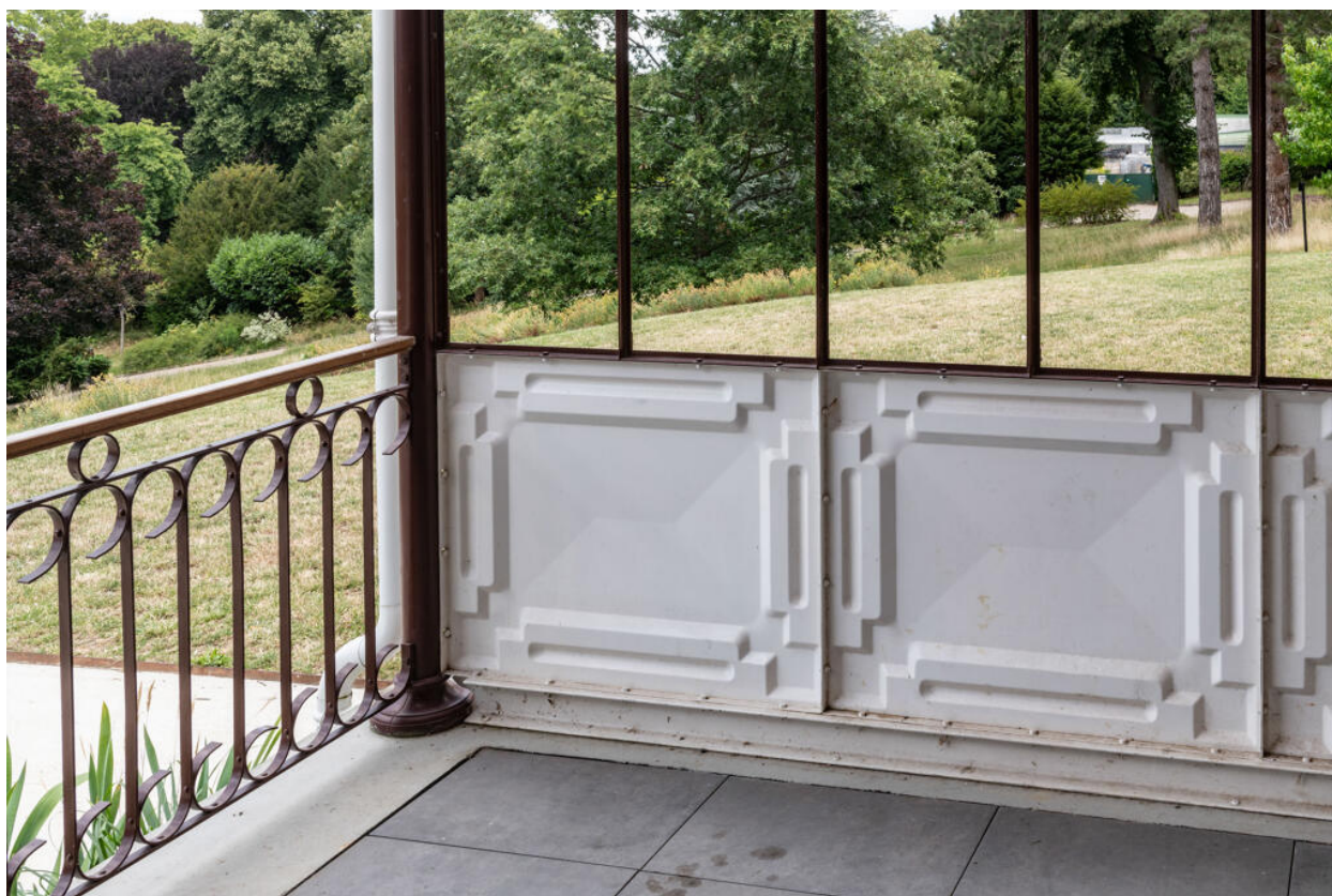
Détail des panneaux de fer de la terrasse, ici non doublés.
