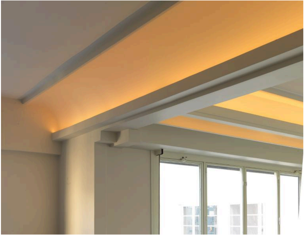
Détail des sources de lumière savamment dissimulées dans le plafond de l'atelier
