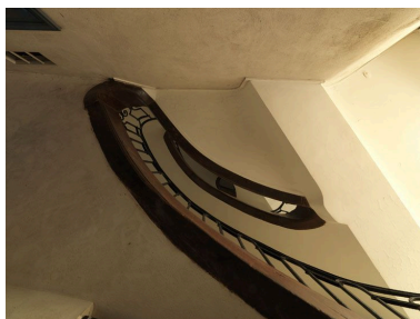
L'escalier vu en contre-plongée. Le vide central a une forme en ""haricot"" très particulière. Phot. Laurent Kruszyk IVR11_20097501087NUC4A
