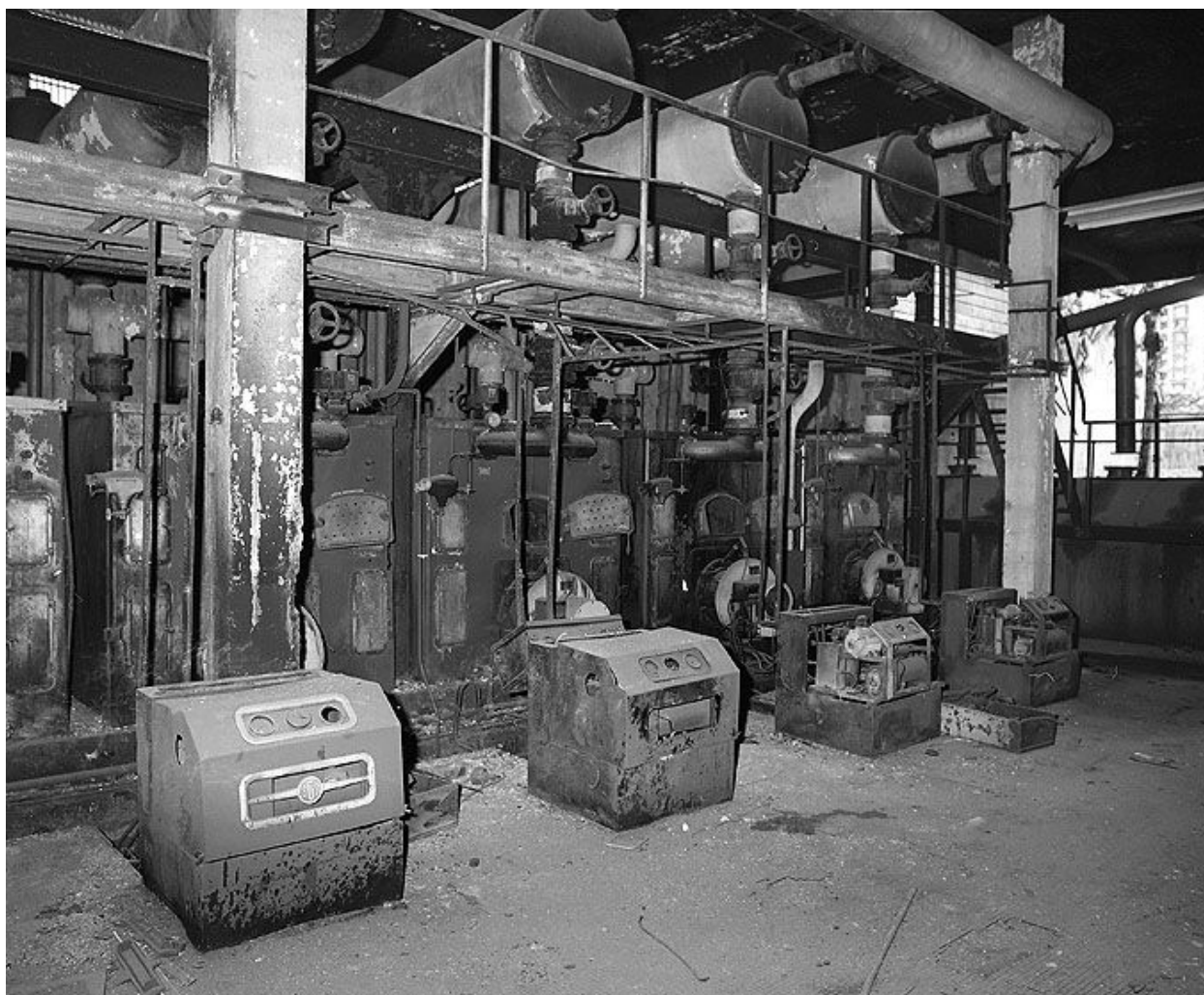
Chaufferie - Vue d'ensemble des chaudières. Campagne photographique, lors de la destruction du bâtiment en 1976.
