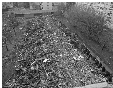
Restes du peigne P1 et des galeries techniques menant de la Tour 1 à la Chaufferie. Campagne photographique, lors de la destruction du bâtiment en 1976. Phot. Pascal Corbière IVR11_19769300031X
