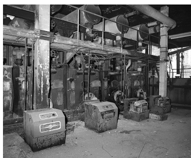
Chaufferie - Vue d'ensemble des chaudières. Campagne photographique, lors de la destruction du bâtiment en 1976. Phot. Pascal Corbière IVR11_19769300062X
