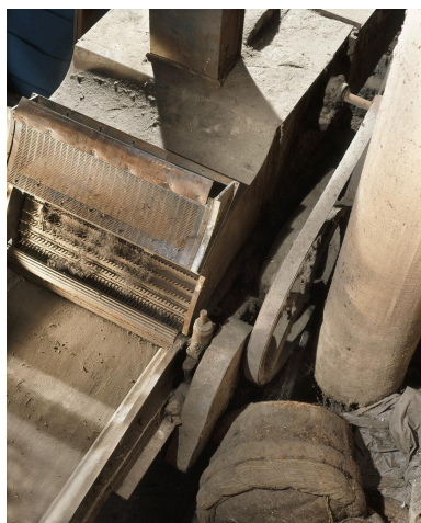
Tambour cardant et courroie de transmission. IVR11_20059300666XA
