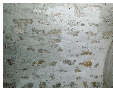
Graffitis sur les murs de la crypte. Phot. Jean-Bernard Vialles IVR11_20109300020NUC4A
