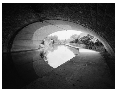
L'arche unique du pont de 1905 en direction de la Seine. Phot. Philippe Ayrault IVR11_20029101078X
