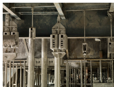
Générateur de vapeur 250 MW. Chaudière. Phot. Philippe Ayrault IVR11_20087700501NUC4A
