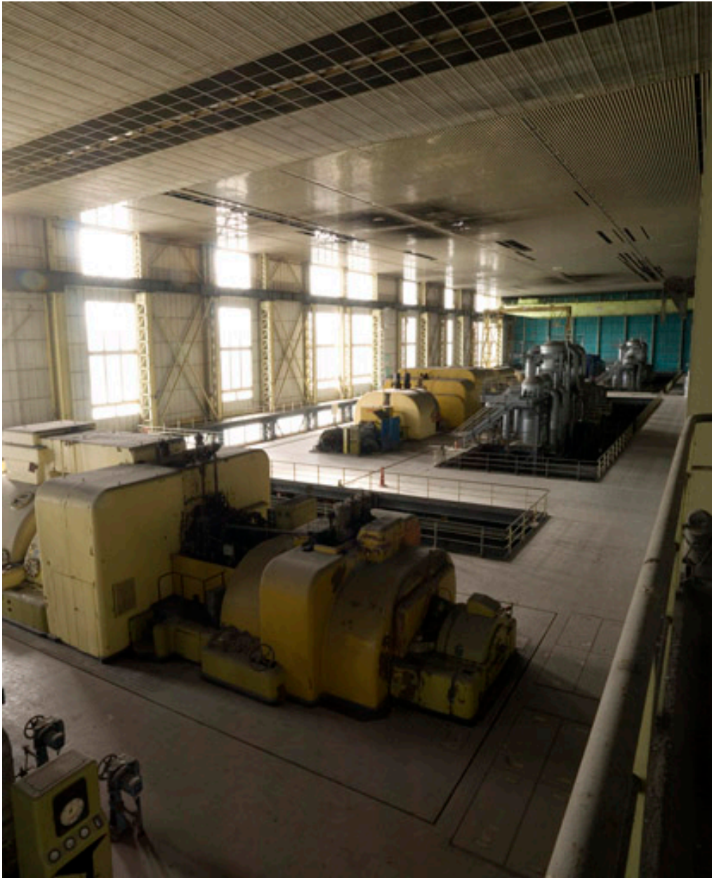
Poste d'eau de 125 MW. Pompe alimentaire.
