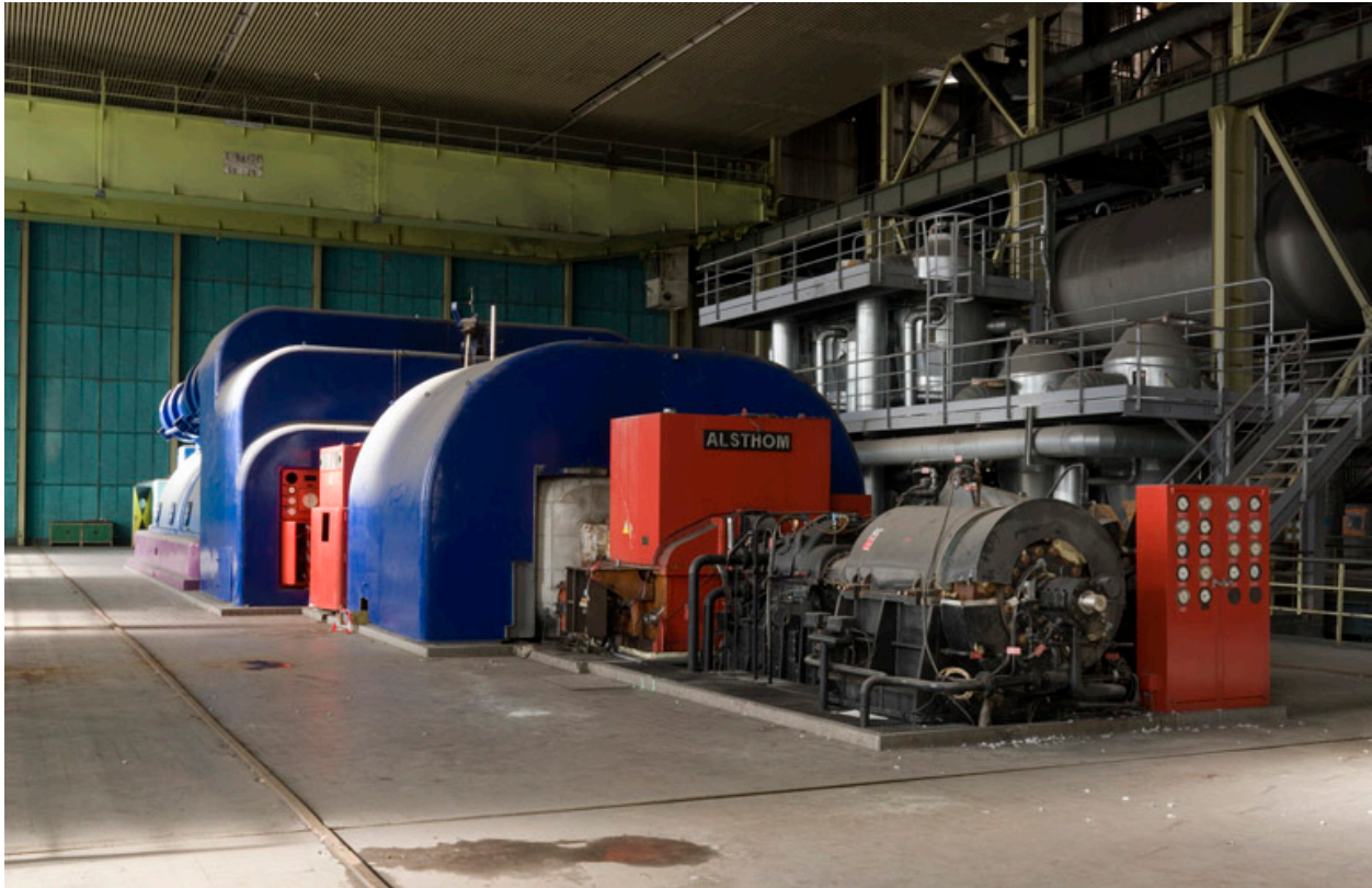
Poste d'eau. Pompe alimentaire principale.
