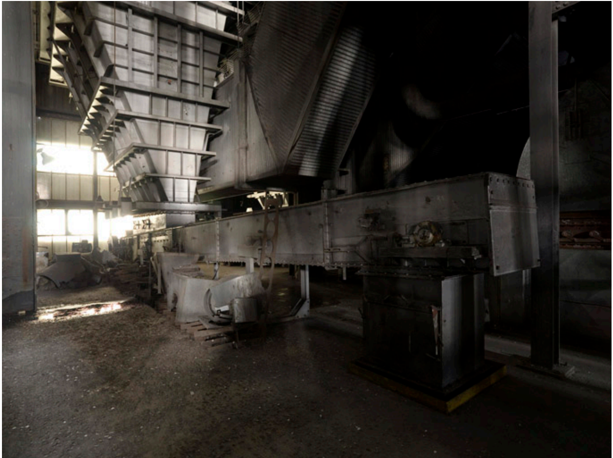
Générateur de vapeur groupe 125MW. Tremie a charbon.
