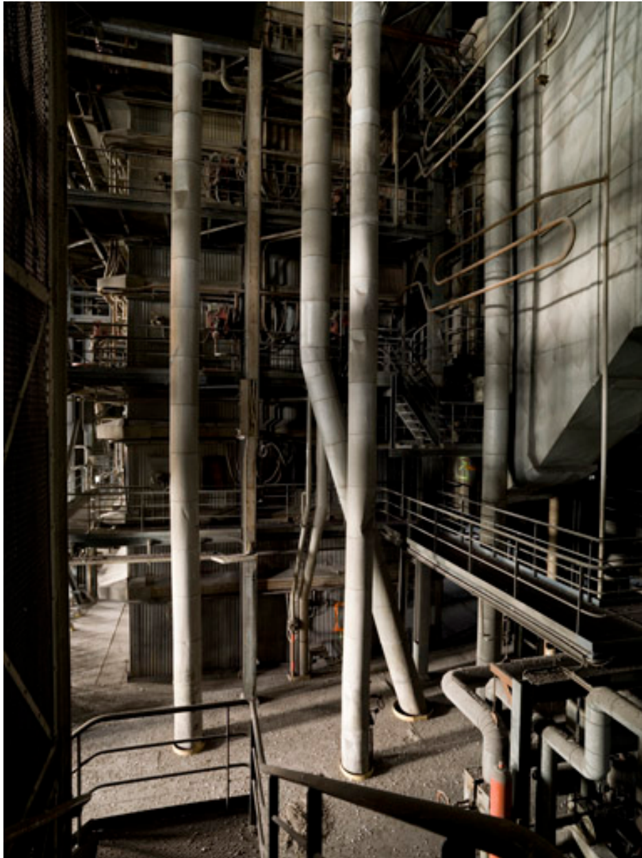
Générateur de vapeur 250 MW.
