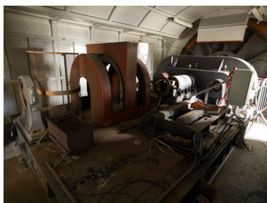
Poste d'eau groupe de 250 MW. Pompe alimentaire principale. Phot. Philippe Ayrault IVR11_20087700522NUC4A
