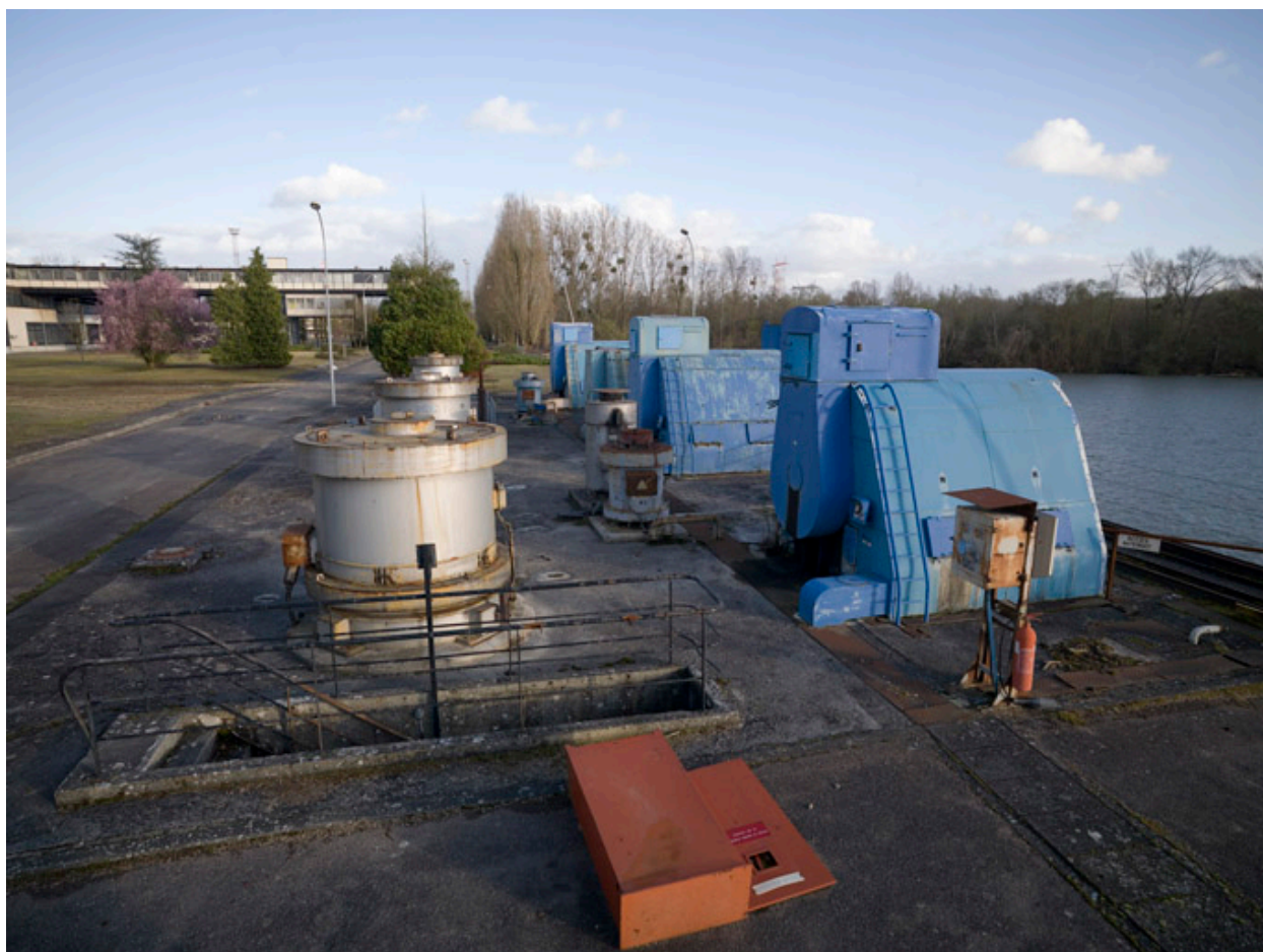
Stations de pompage.
