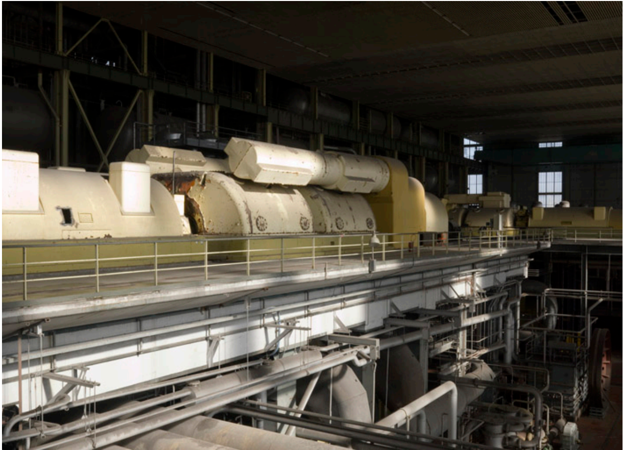
Poste d'eau groupe de 250 MW. Pompe alimentaire principale.
