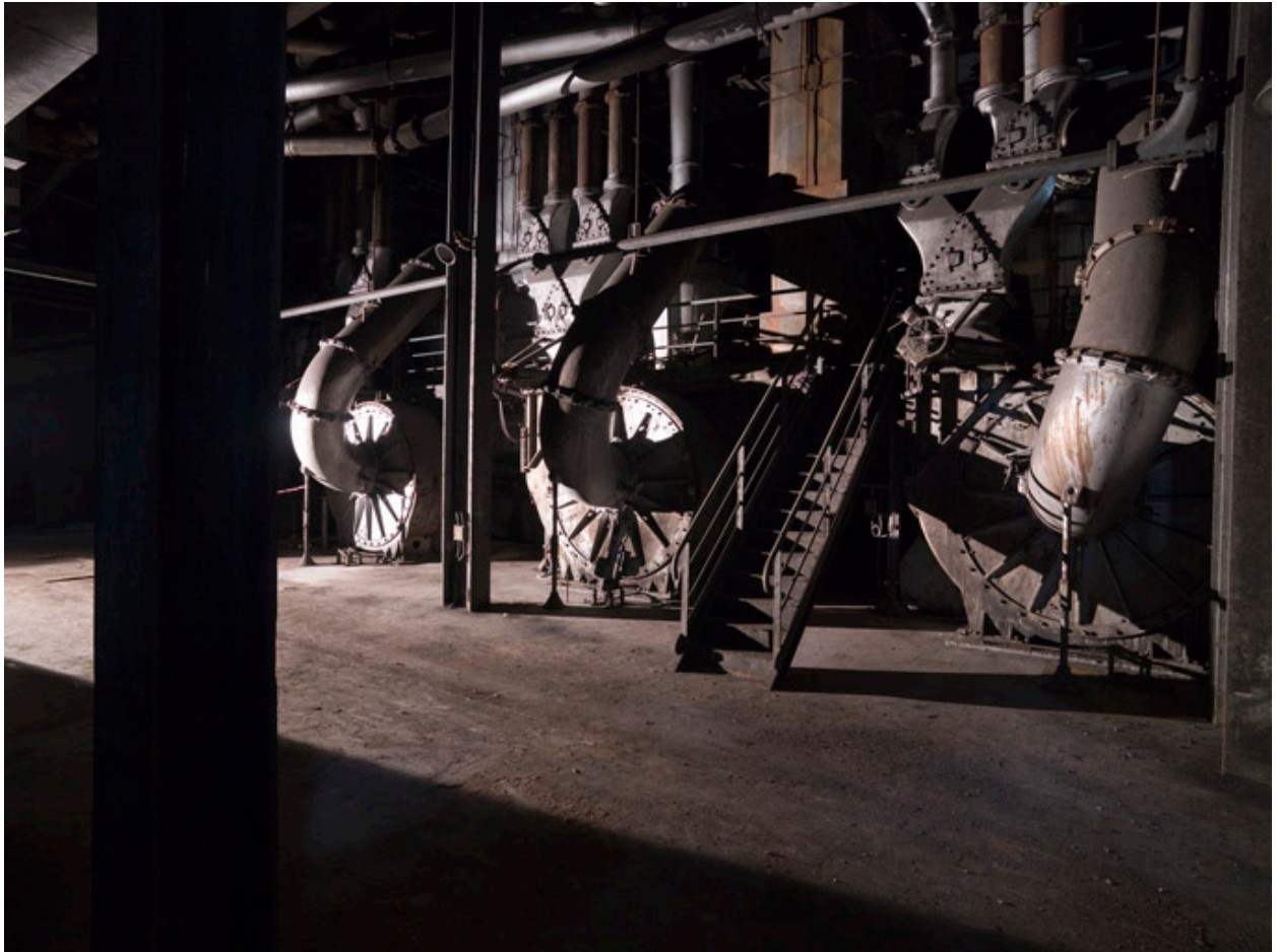
Générateur de vapeur groupe 125MW. Broyeur.
