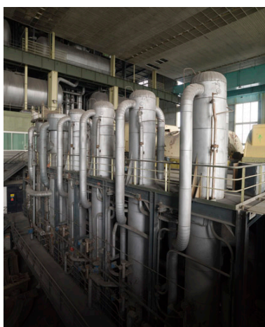
Poste d'eau tranche 125 MW. Turbines Phot. Philippe Ayrault IVR11_20087700518NUC4A
