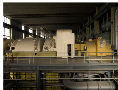
Poste d'eau tranche 125 MW. Turbine de construction Alsthom. Phot. Philippe Ayrault IVR11_20087700514NUC4A
