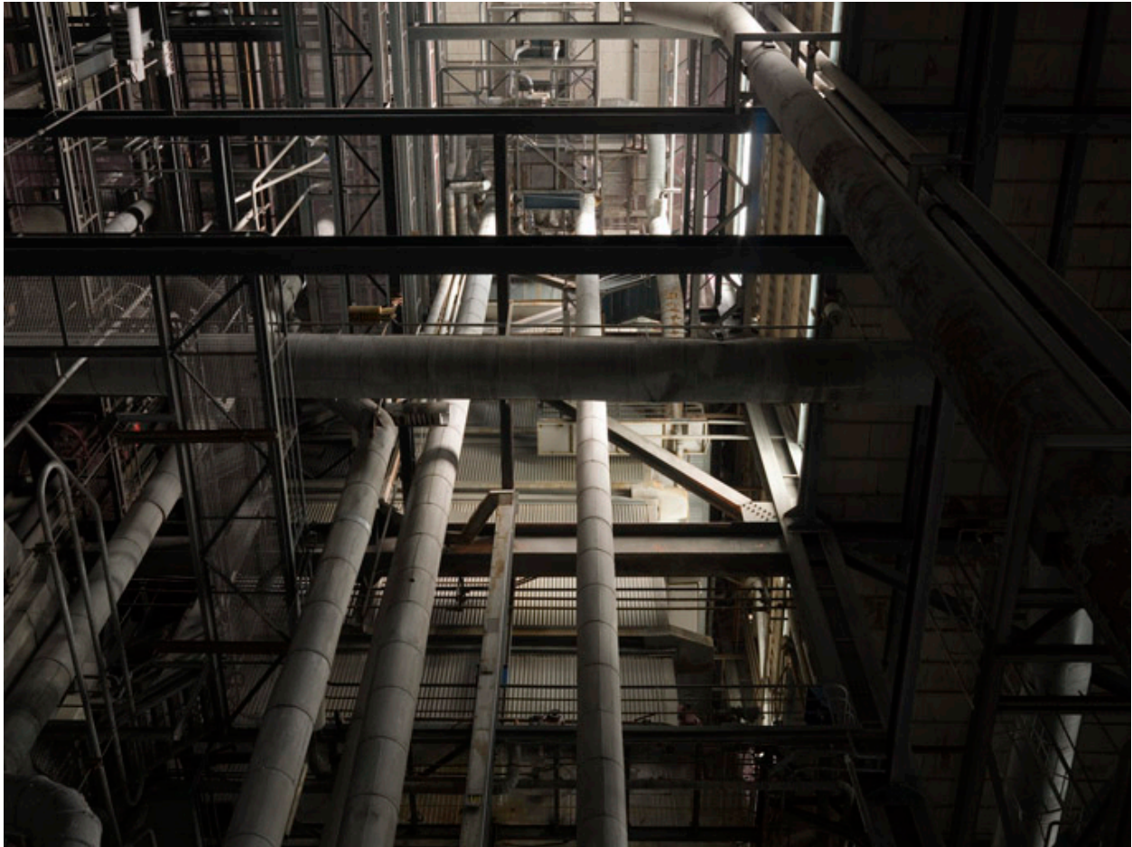
Générateur de vapeur 250 MW.
