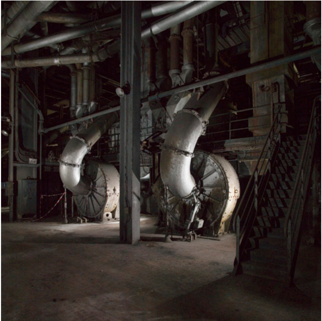
Générateur de vapeur groupe 125MW. Broyeur.
