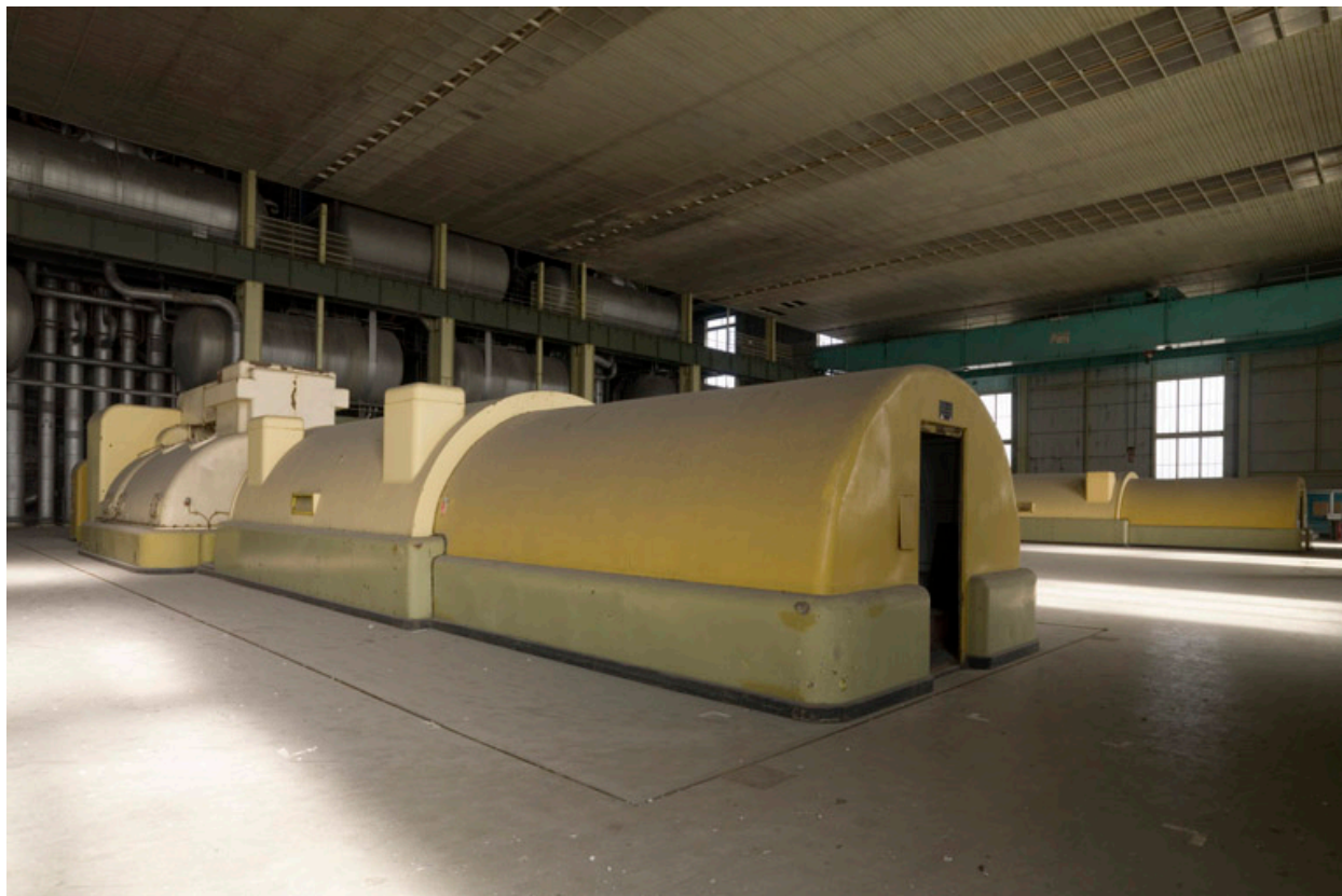
Poste d'eau tranche 125 MW. Turbine de construction Alsthom.
