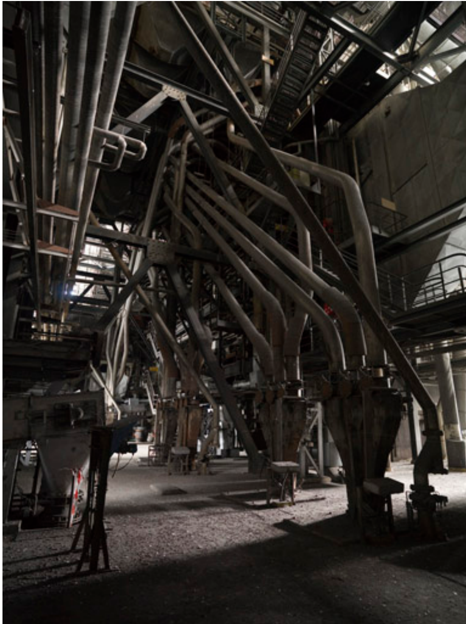
Générateur de vapeur groupe 125MW. Broyeur.
