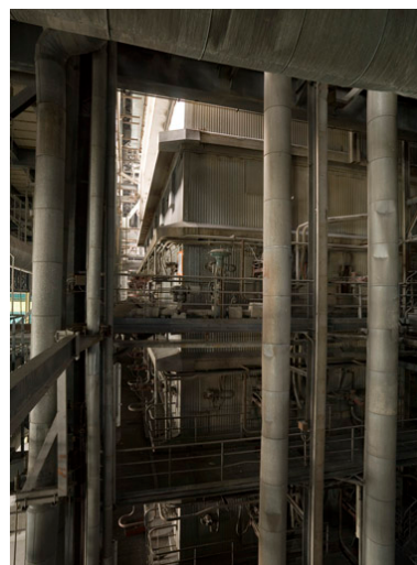
Générateur de vapeur 250 MW. Phot. Philippe Ayrault IVR11_20087700508NUC4A
