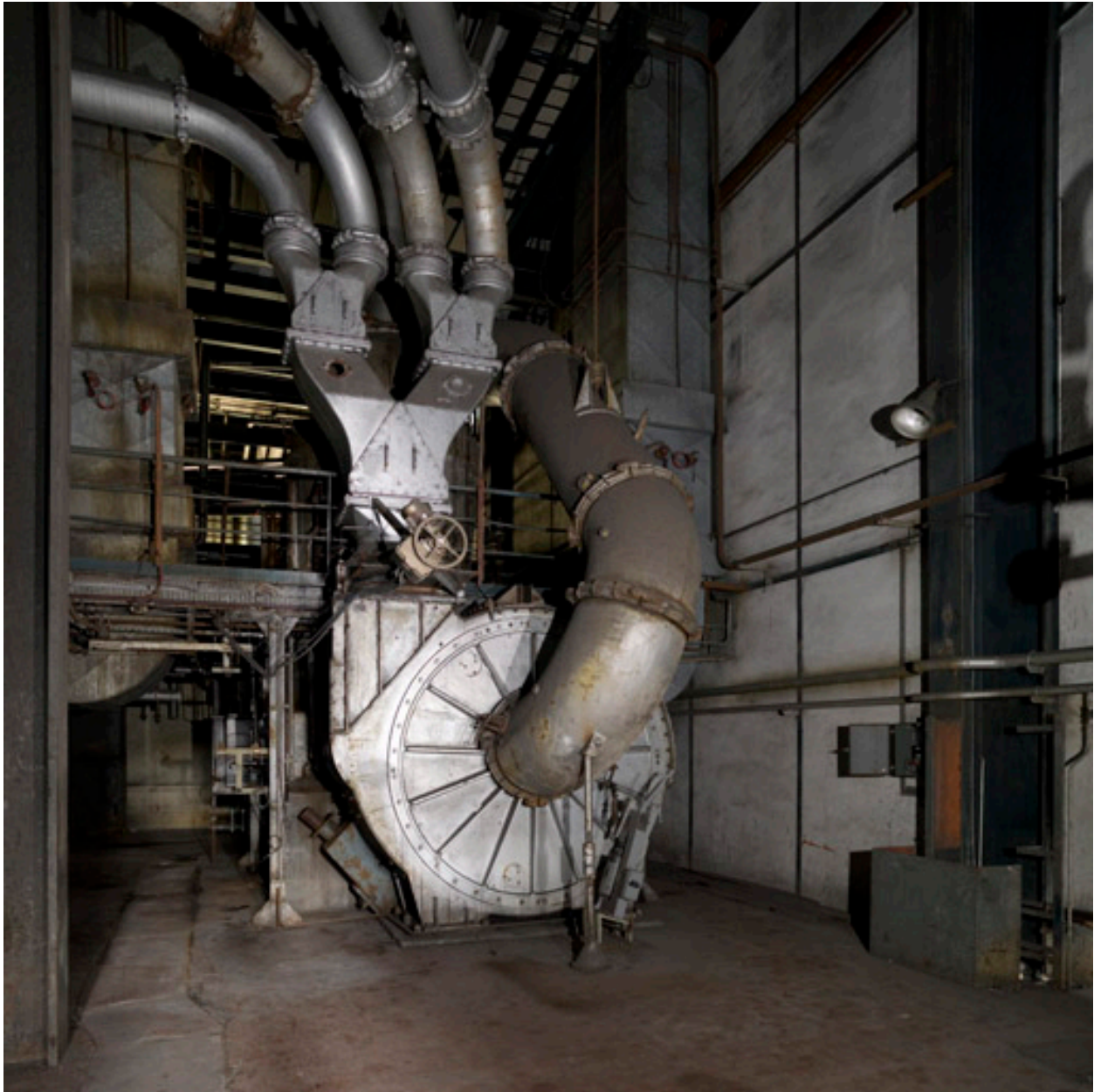
Générateur de vapeur groupe 125MW. Broyeur.
