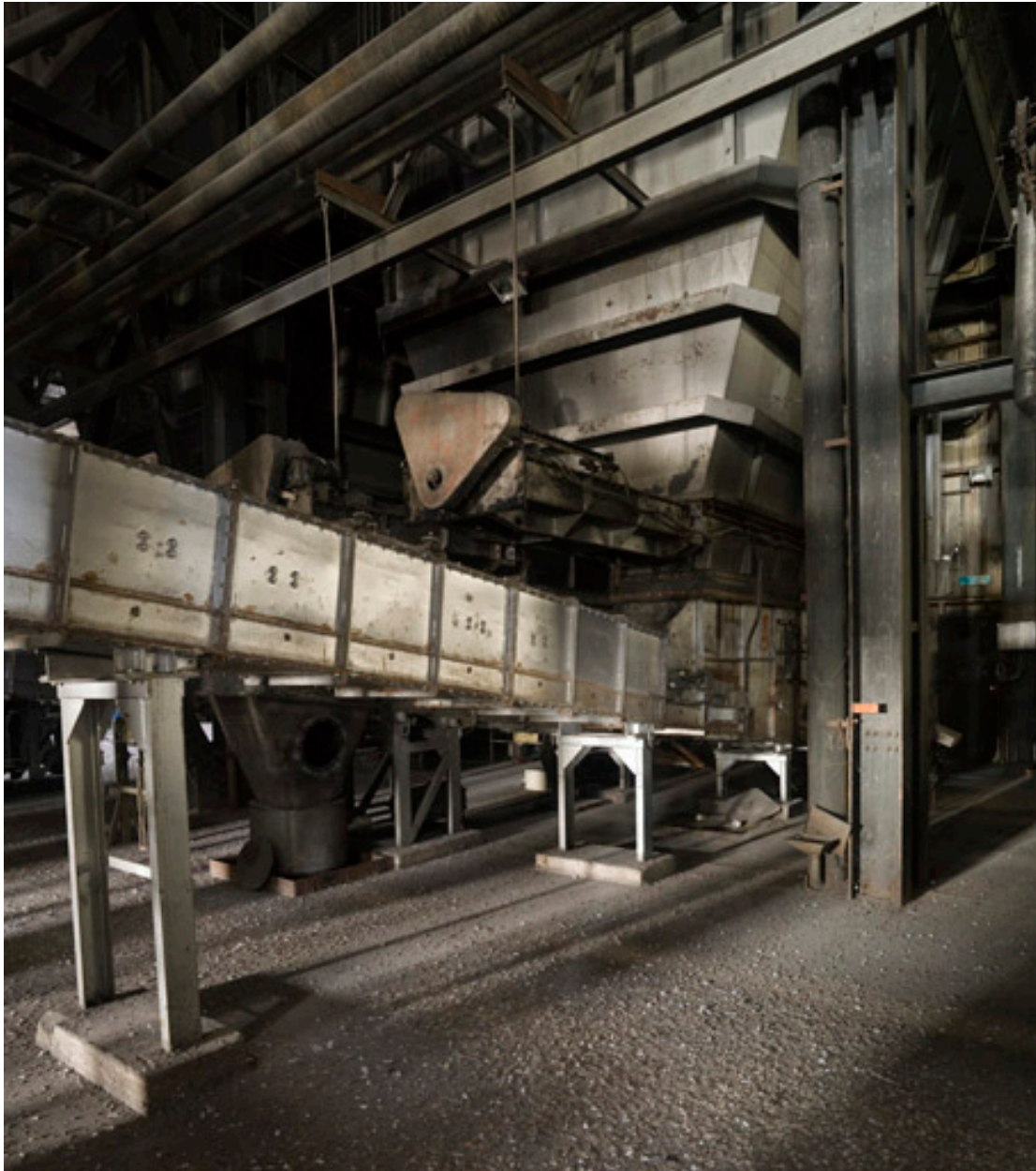
Générateur de vapeur groupe 125MW. Tremie a charbon.
