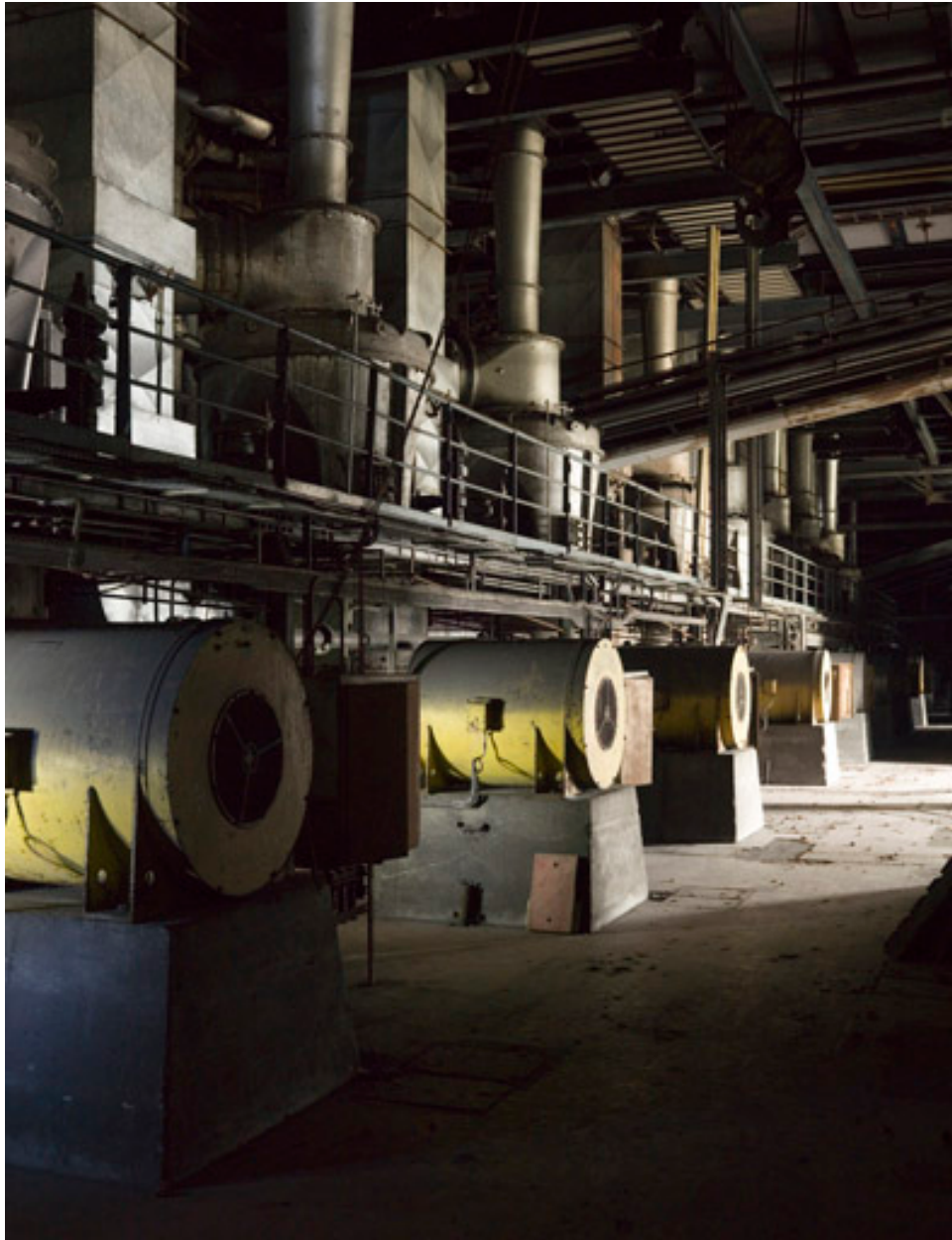
Générateur de vapeur groupe 125MW. Broyeur
