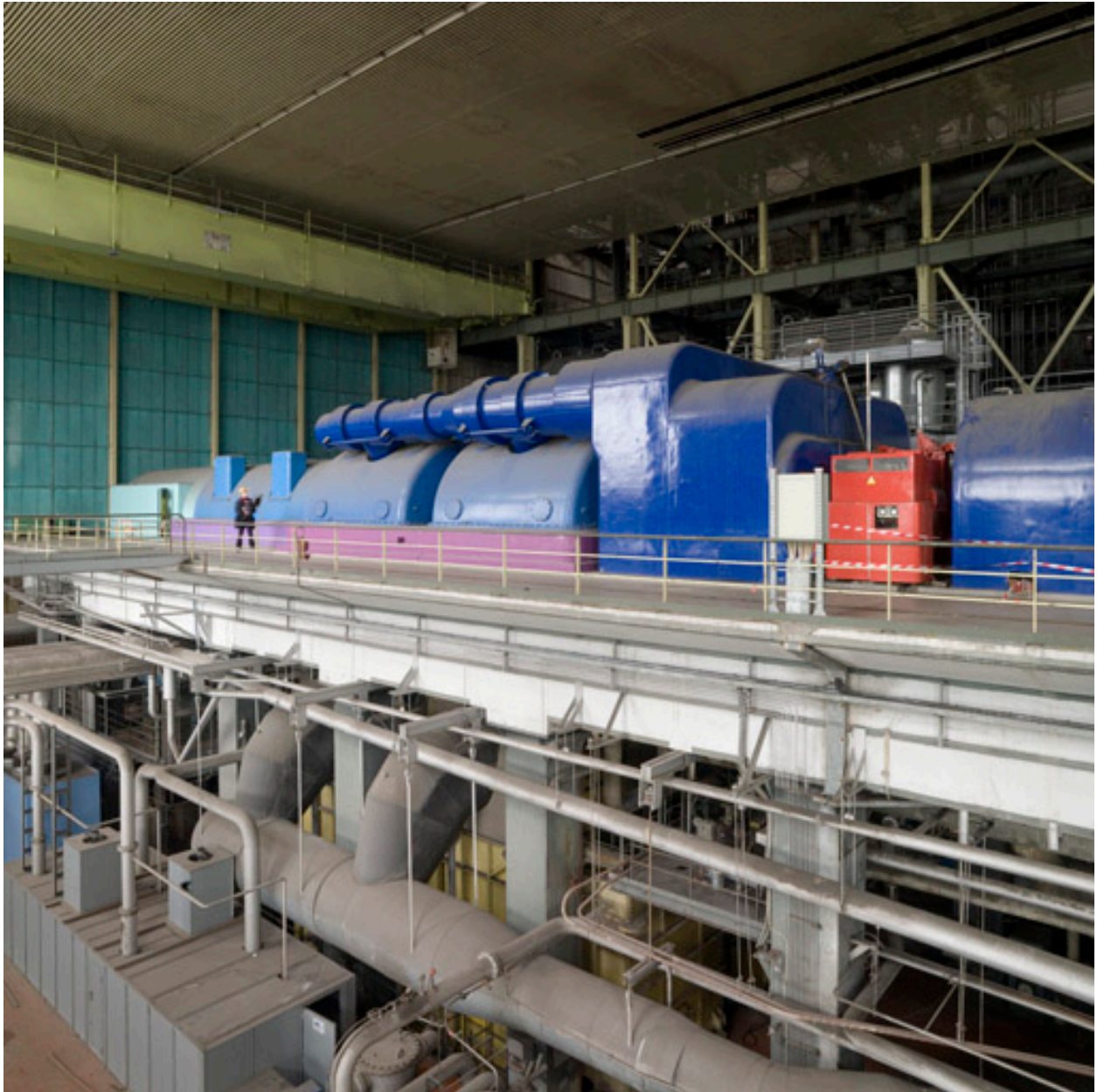
Poste d'eau. Pompe alimentaire principale.
