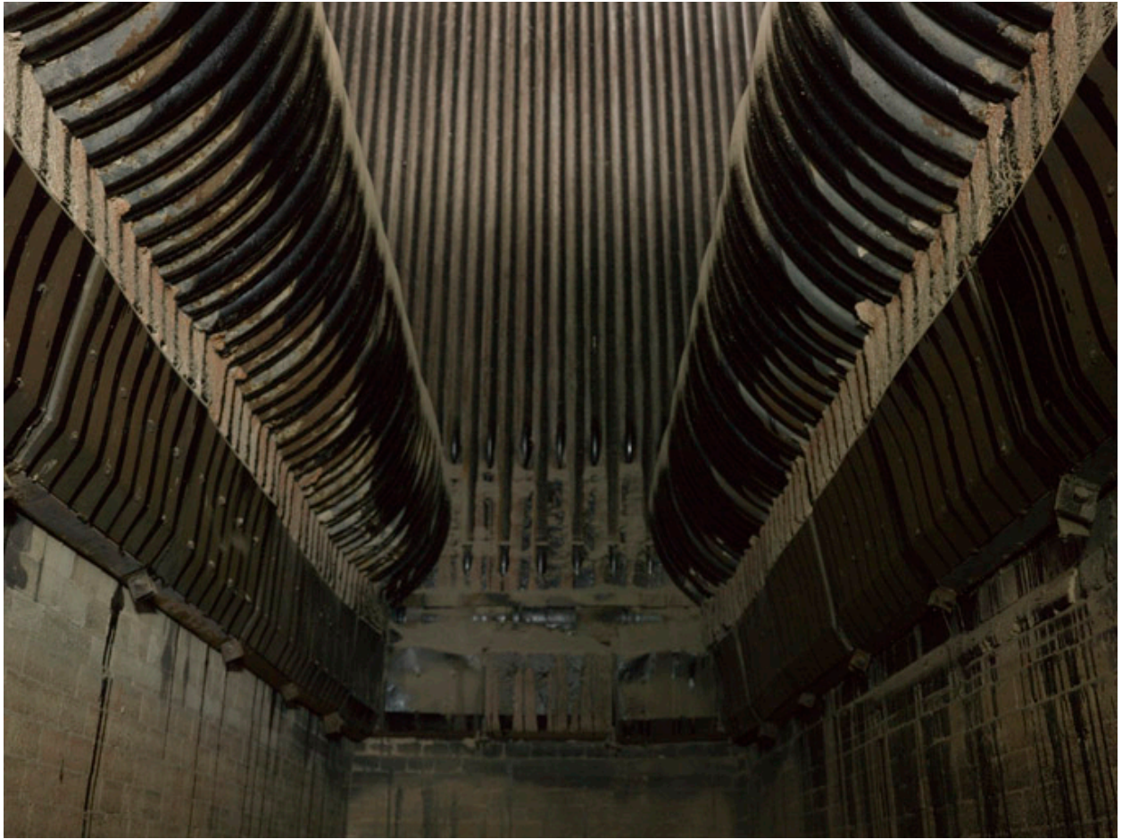
Générateur de vapeur 250 MW. Cendrier de la chaudière.
