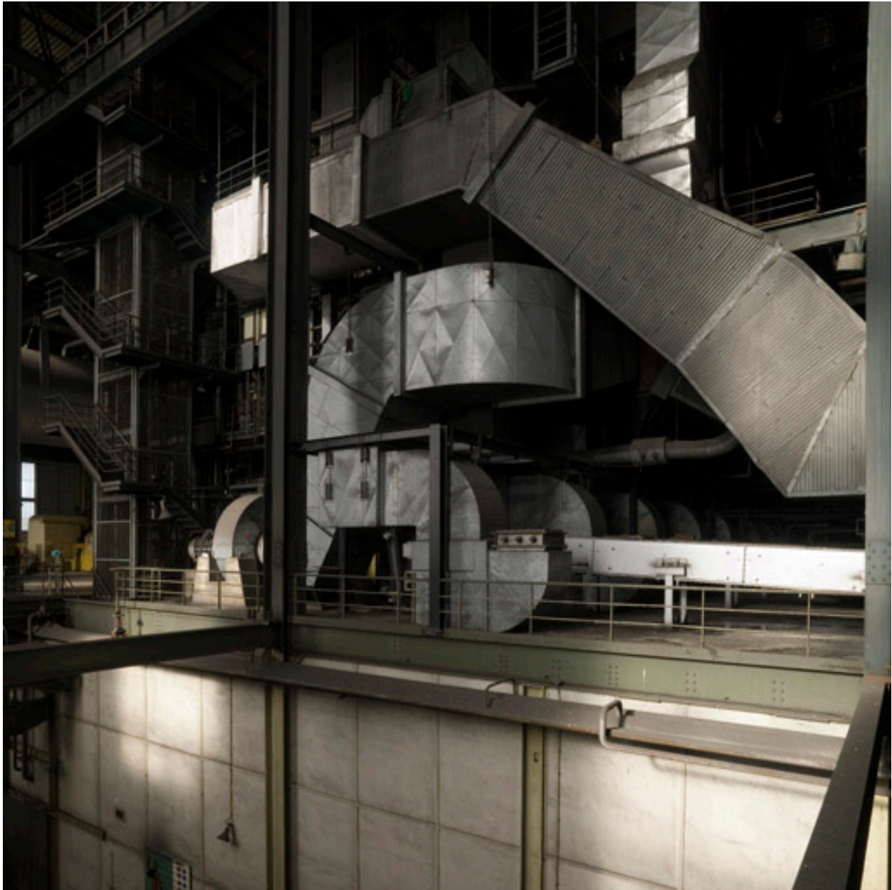
Générateur de vapeur 250 MW.
