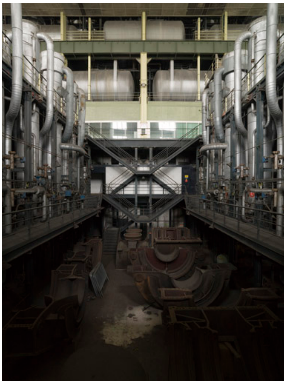
Poste d'eau tranche 125 MW. Turbines
