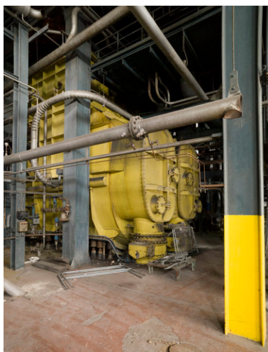
Condenseur de la tranche 125 MW. Phot. Philippe Ayrault IVR11_20087700531NUC4A
