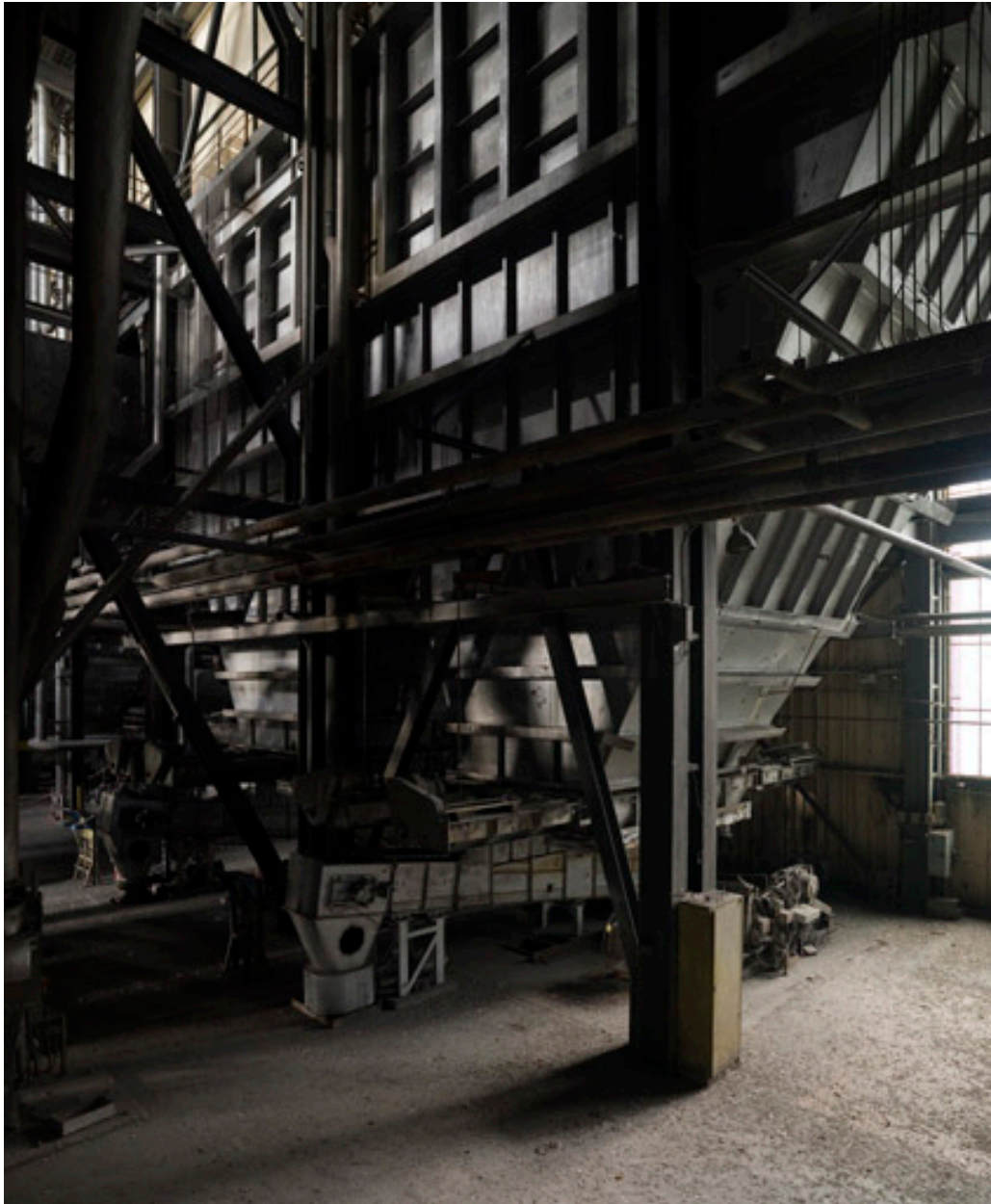
Générateur de vapeur groupe 125MW. Tremie a charbon.
