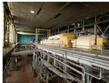
Poste d'eau groupe de 250 MW. Pompe alimentaire principale. Phot. Philippe Ayrault IVR11_20087700520NUC4A
