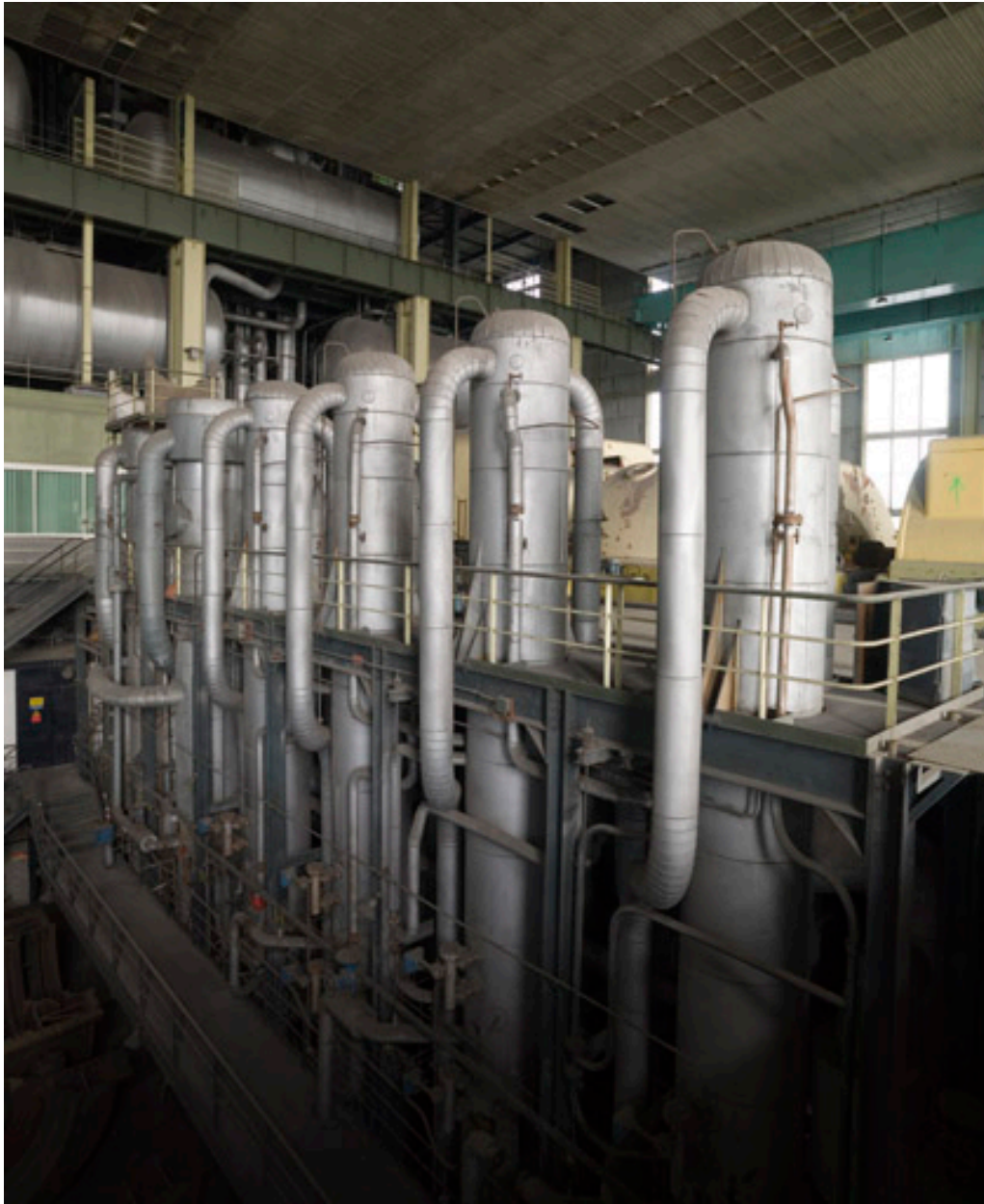
Poste d'eau tranche 125 MW. Turbines
