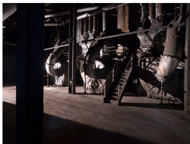
Générateur de vapeur groupe 125MW. Broyeur. Phot. Philippe Ayrault IVR11_20087700492NUC4A
