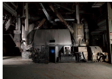
Générateur de vapeur 250 MW. Broyeur. Phot. Philippe Ayrault IVR11_20087700496NUC4A
