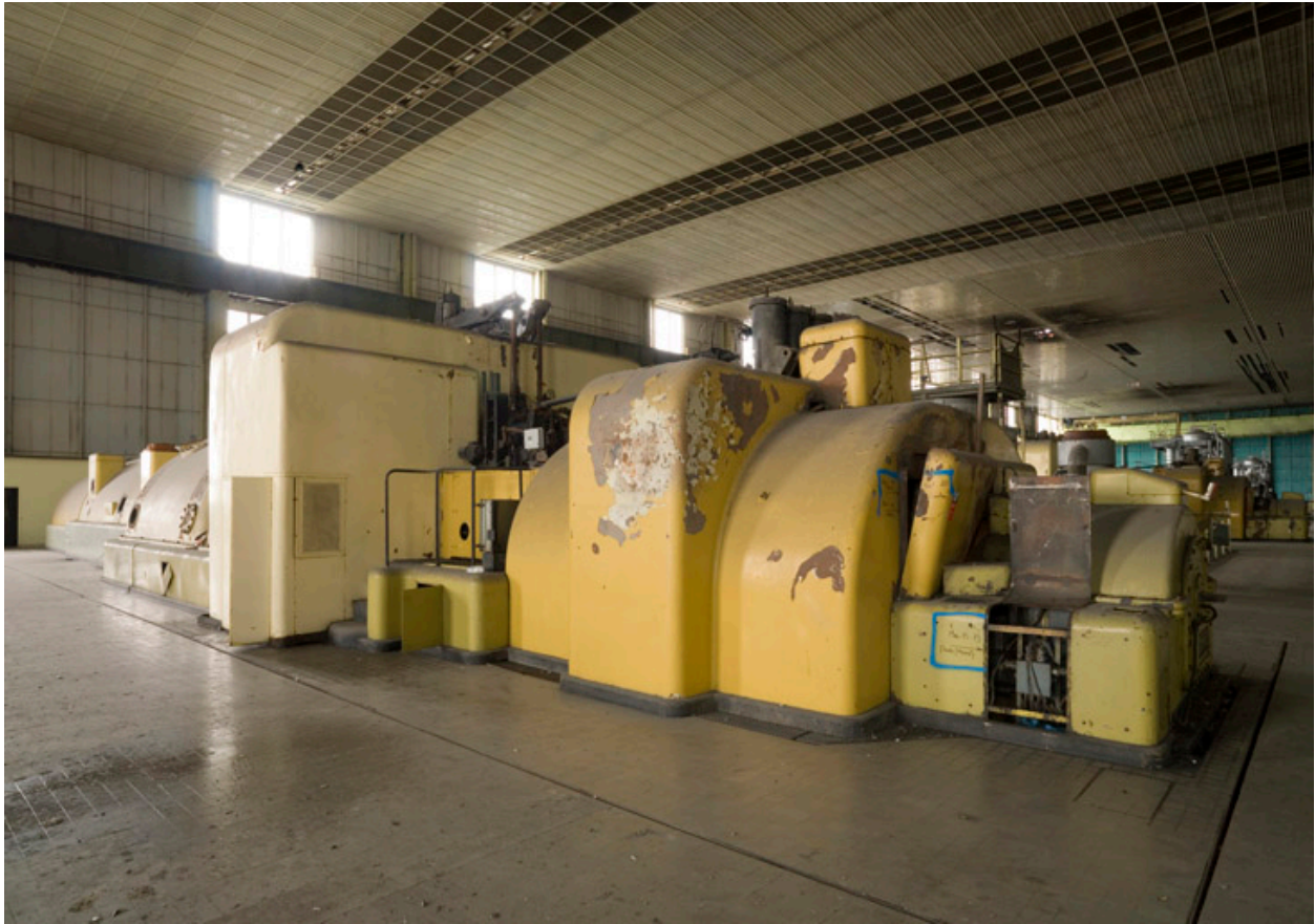
Poste d'eau tranche 125 MW. Turbine de construction Alsthom.
