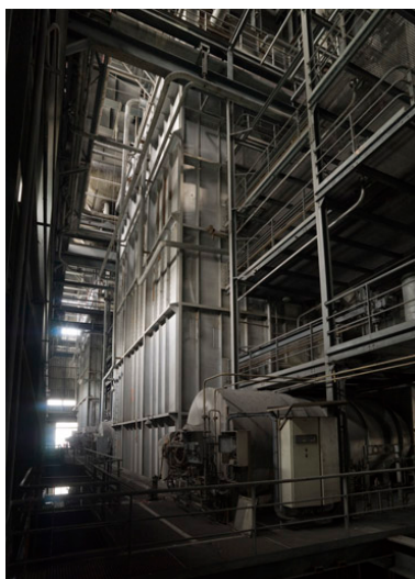
Générateur de vapeur 250 MW. Chaudière Phot. Philippe Ayrault IVR11_20087700498NUC4A
