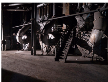
Générateur de vapeur groupe 125MW. Broyeur. Phot. Philippe Ayrault IVR11_20087700491NUC4A
