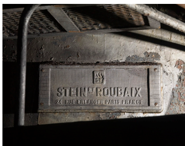
Plaque "Stein et Roubaix" sur la chaudière. Phot. Philippe Ayrault IVR11_20087700495NUC4A
