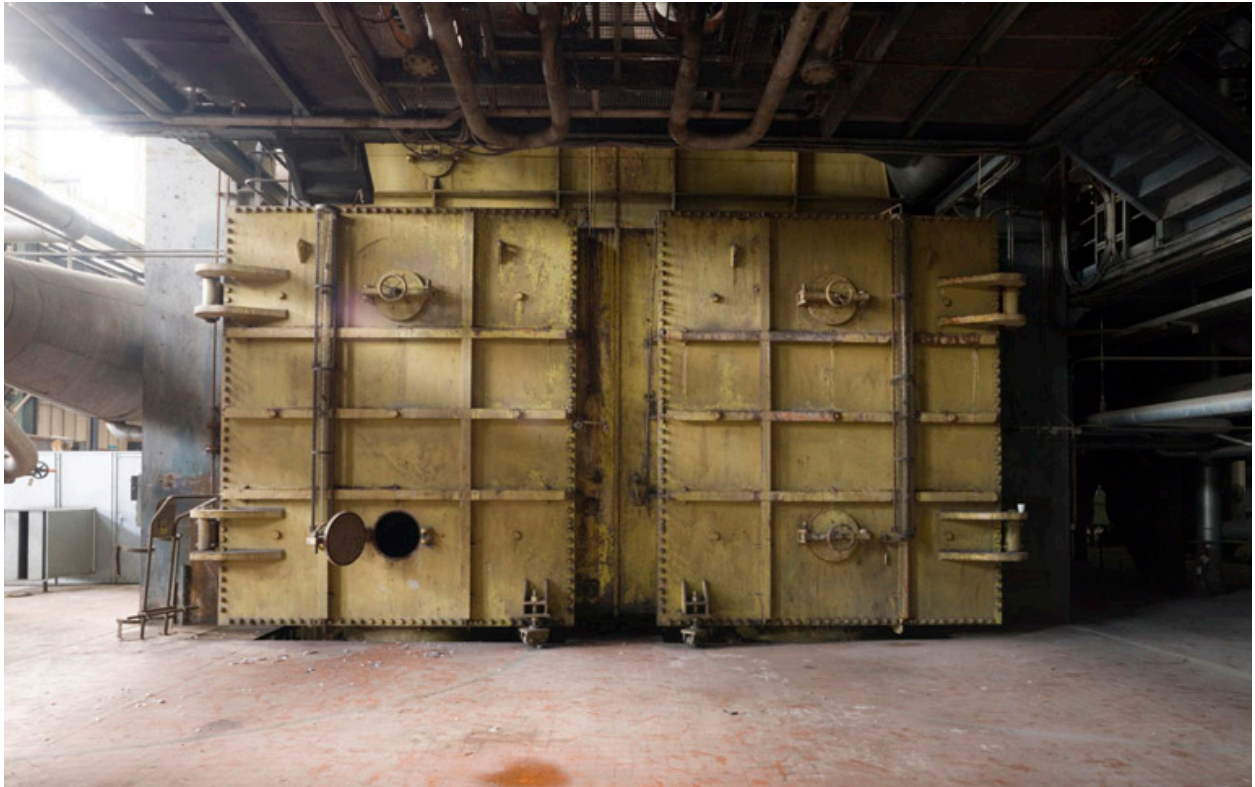
Condenseur de la tranche 250 MW.
