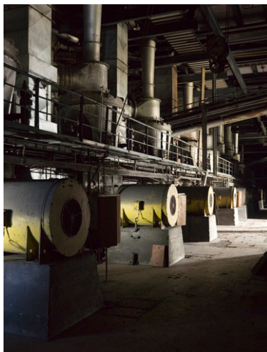
Générateur de vapeur groupe 125MW. Broyeur Phot. Philippe Ayrault IVR11_20087700490NUC4A
