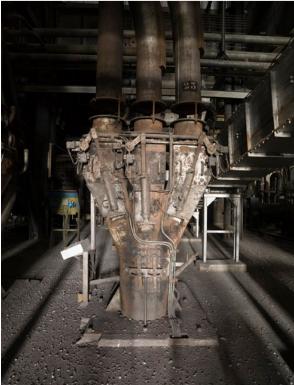
Générateur de vapeur groupe 125MW. Broyeur
