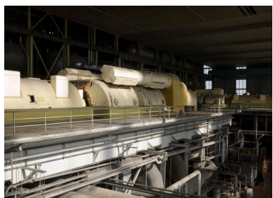
Poste d'eau groupe de 250 MW. Pompe alimentaire principale. Phot. Philippe Ayrault IVR11_20087700521NUC4A
