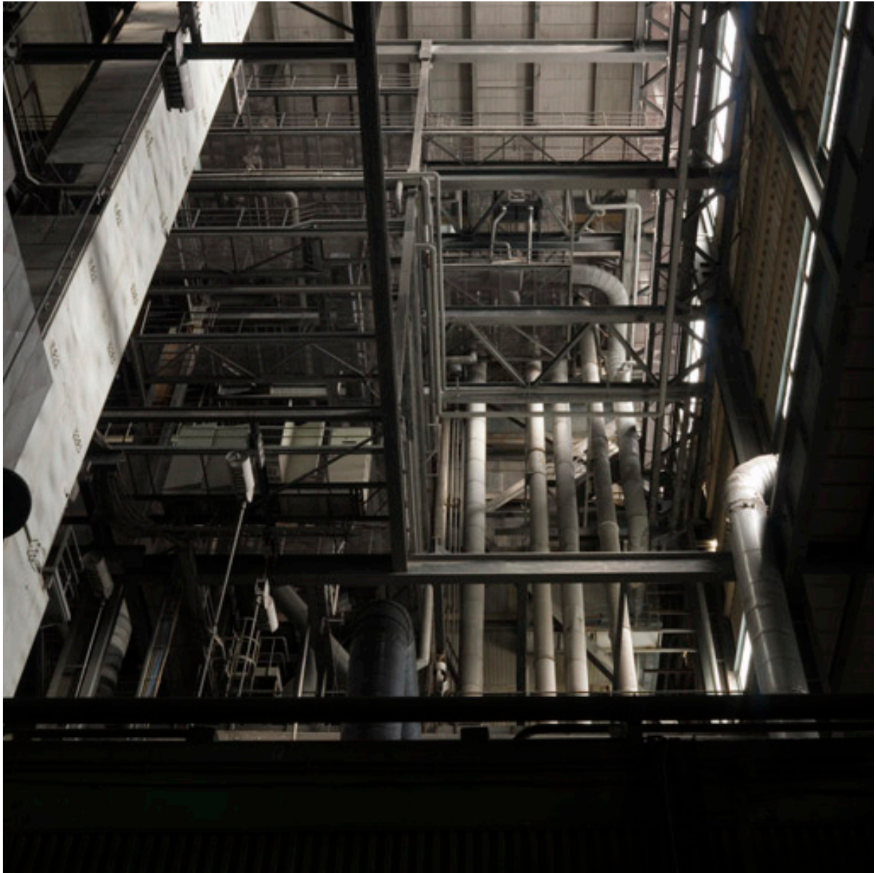
Générateur de vapeur 250 MW.
