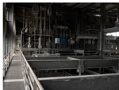
Générateur de vapeur 250 MW. Chaudière Phot. Philippe Ayrault IVR11_20087700499NUC4A
