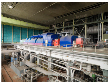
Poste d'eau. Pompe alimentaire principale. Phot. Philippe Ayrault IVR11_20087700525NUC4A
