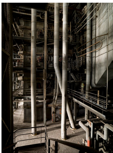
Générateur de vapeur 250 MW. Phot. Philippe Ayrault IVR11_20087700507NUC4A
