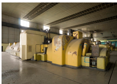
Poste d'eau tranche 125 MW. Turbine de construction Alsthom. Phot. Philippe Ayrault IVR11_20087700513NUC4A
