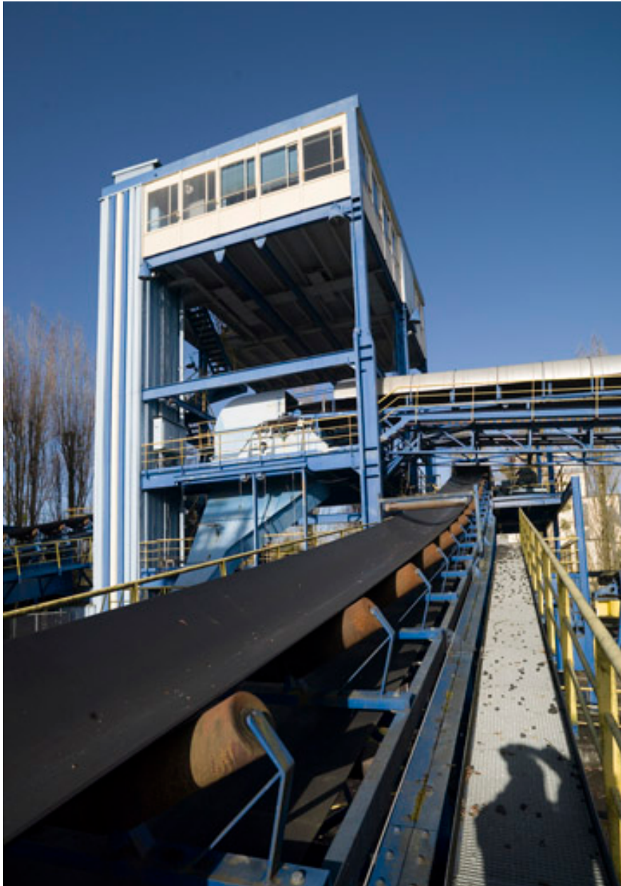
Parc a charbon. Manutention. Tapis-jeteur.
