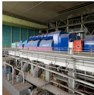
Poste d'eau. Pompe alimentaire principale. Phot. Philippe Ayrault IVR11_20087700526NUC4A
