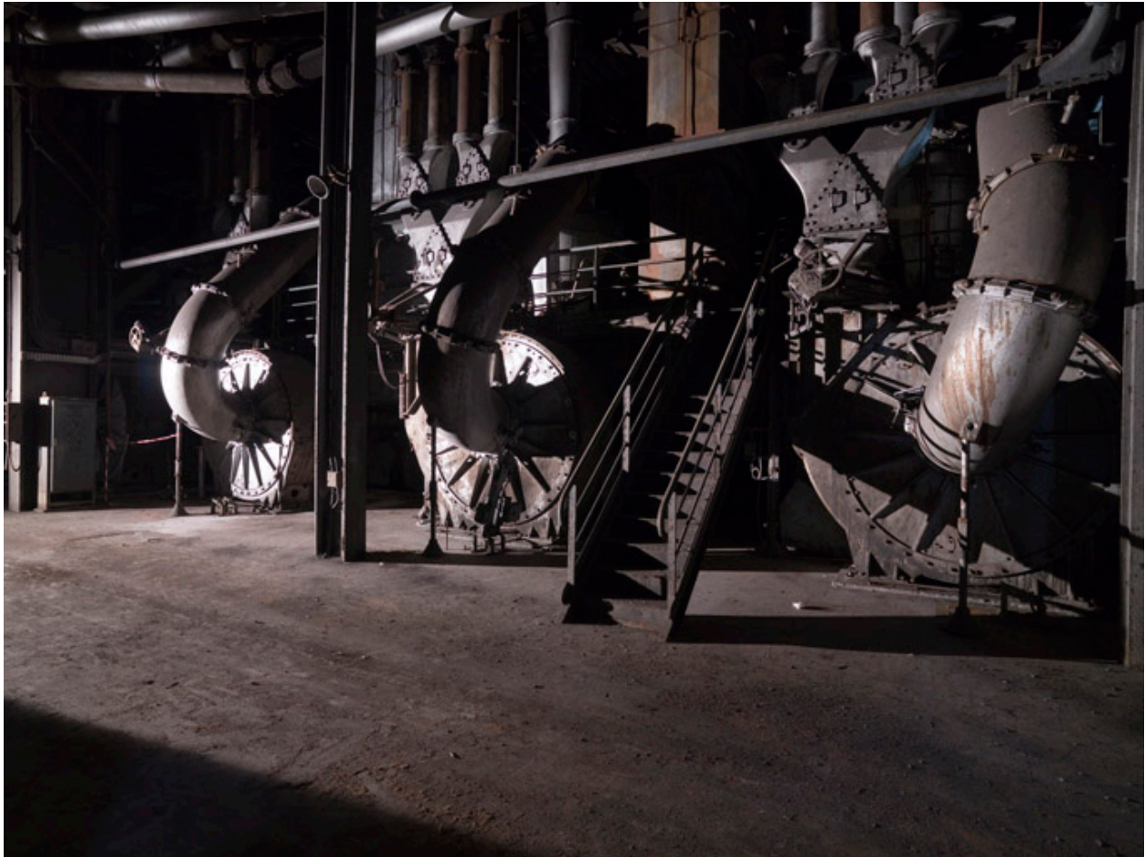
Générateur de vapeur groupe 125MW. Broyeur.
