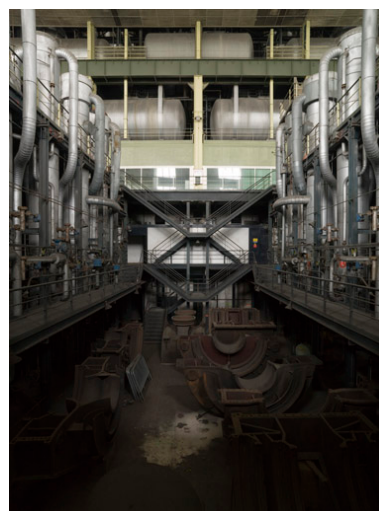
Poste d'eau tranche 125 MW. Turbines Phot. Philippe Ayrault IVR11_20087700517NUC4A
