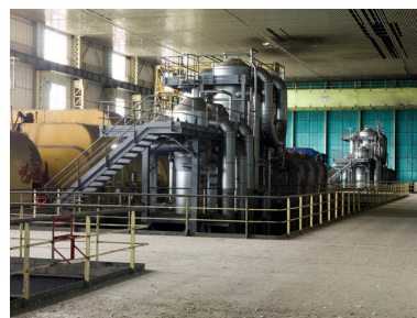
Poste d'eau groupe de 250 MW. Pompe alimentaire principale. Phot. Philippe Ayrault IVR11_20087700523NUC4A
