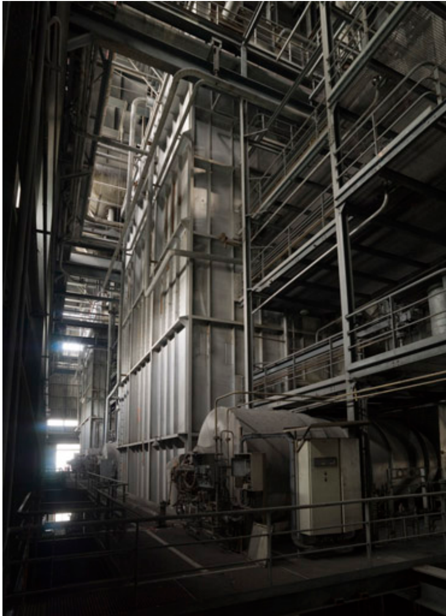
Générateur de vapeur 250 MW. Chaudière
