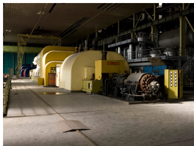
Poste d'eau groupe de 250 MW. Pompe alimentaire principale. Phot. Philippe Ayrault IVR11_20087700519NUC4A
