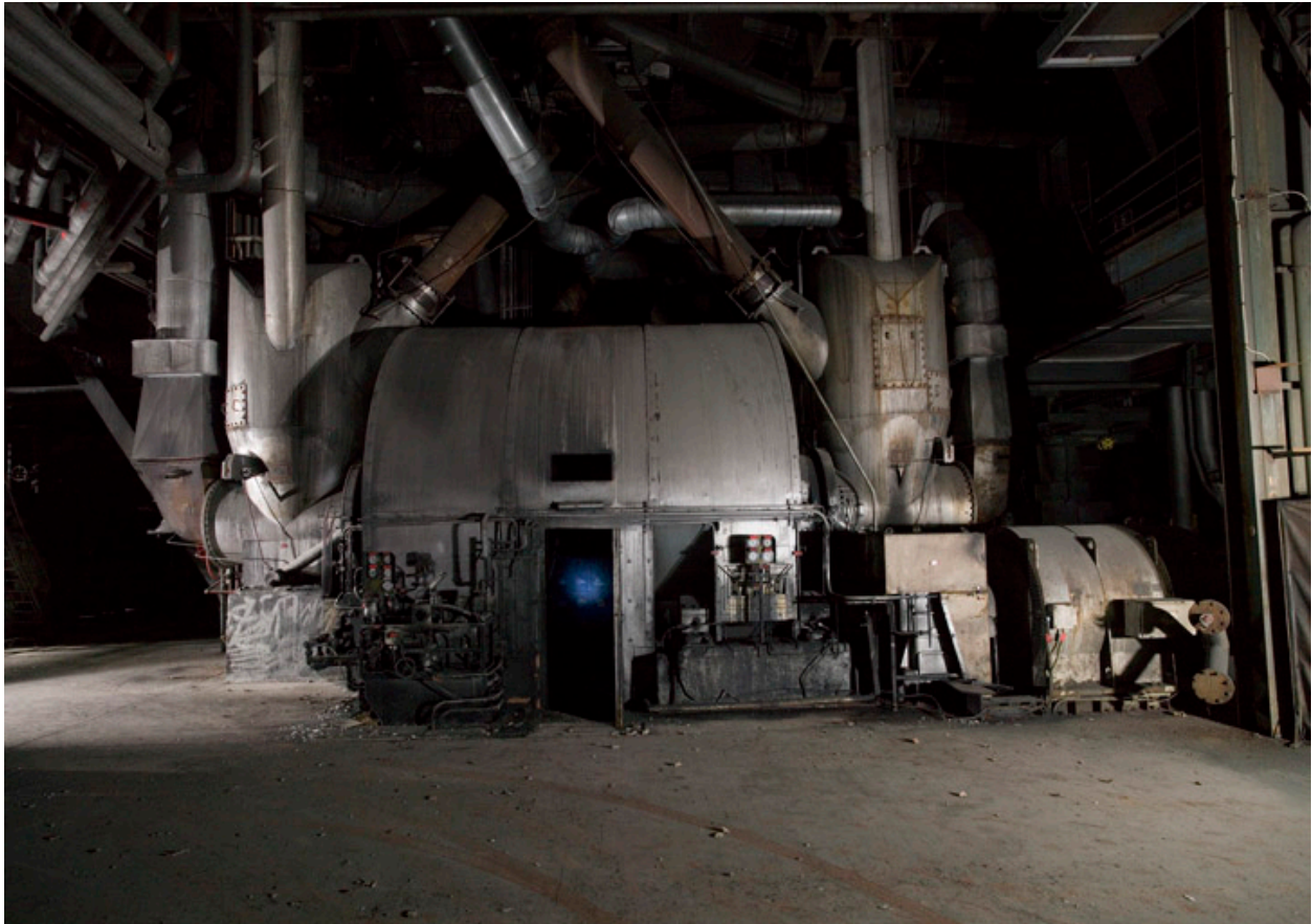
Générateur de vapeur 250 MW. Broyeur.
