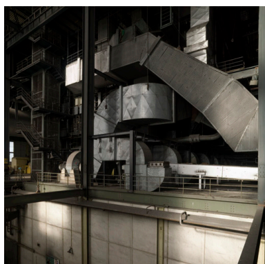
Générateur de vapeur 250 MW. Phot. Philippe Ayrault IVR11_20087700506NUC4A
