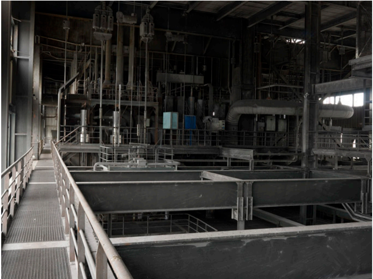
Générateur de vapeur 250 MW. Chaudière
