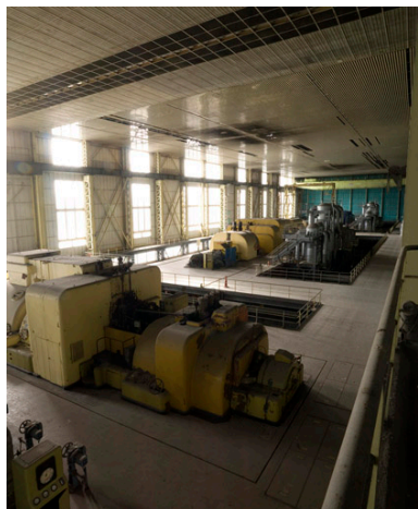
Poste d'eau de 125 MW. Pompe alimentaire. Phot. Philippe Ayrault IVR11_20087700476NUC4A
