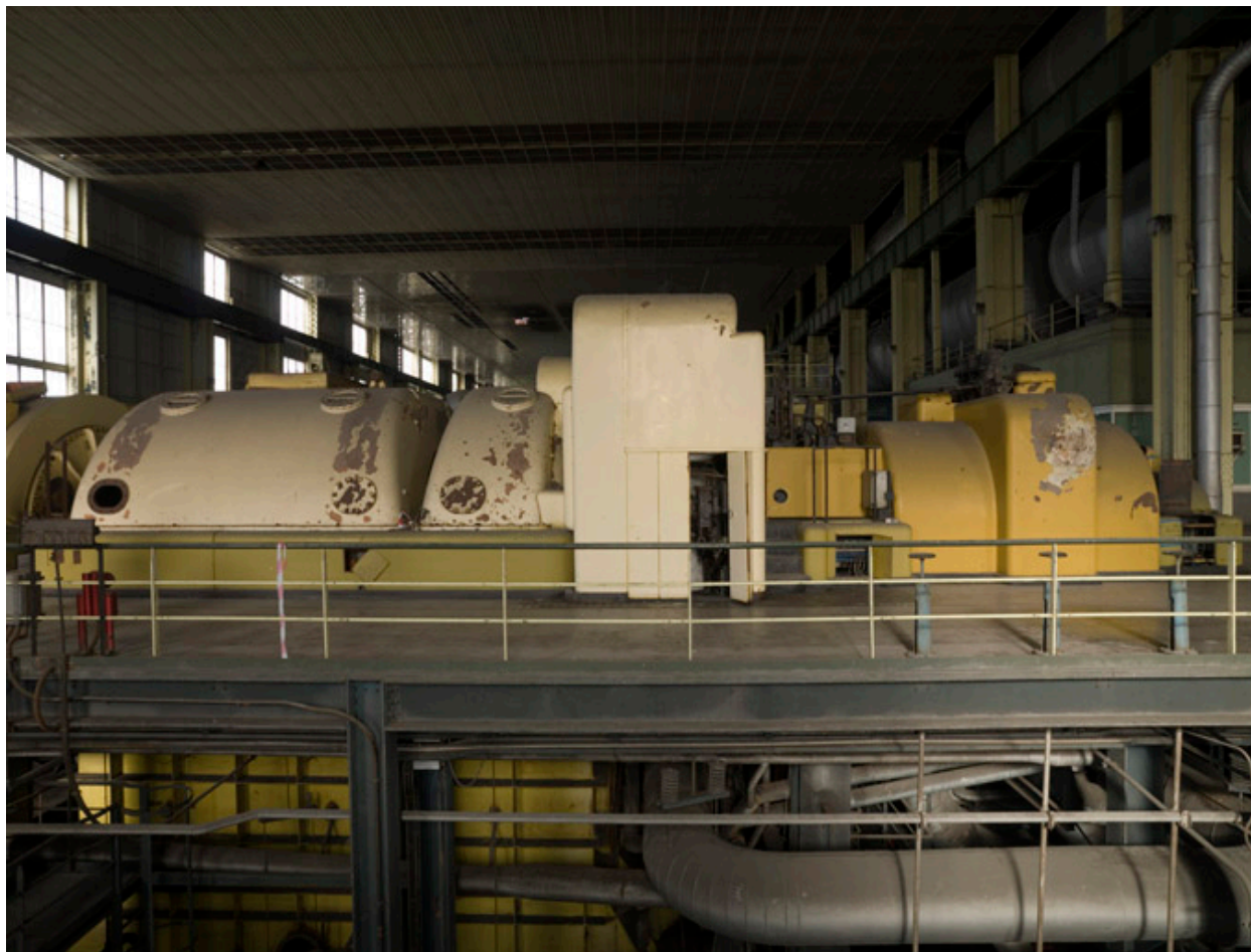
Poste d'eau tranche 125 MW. Turbine de construction Alsthom.
