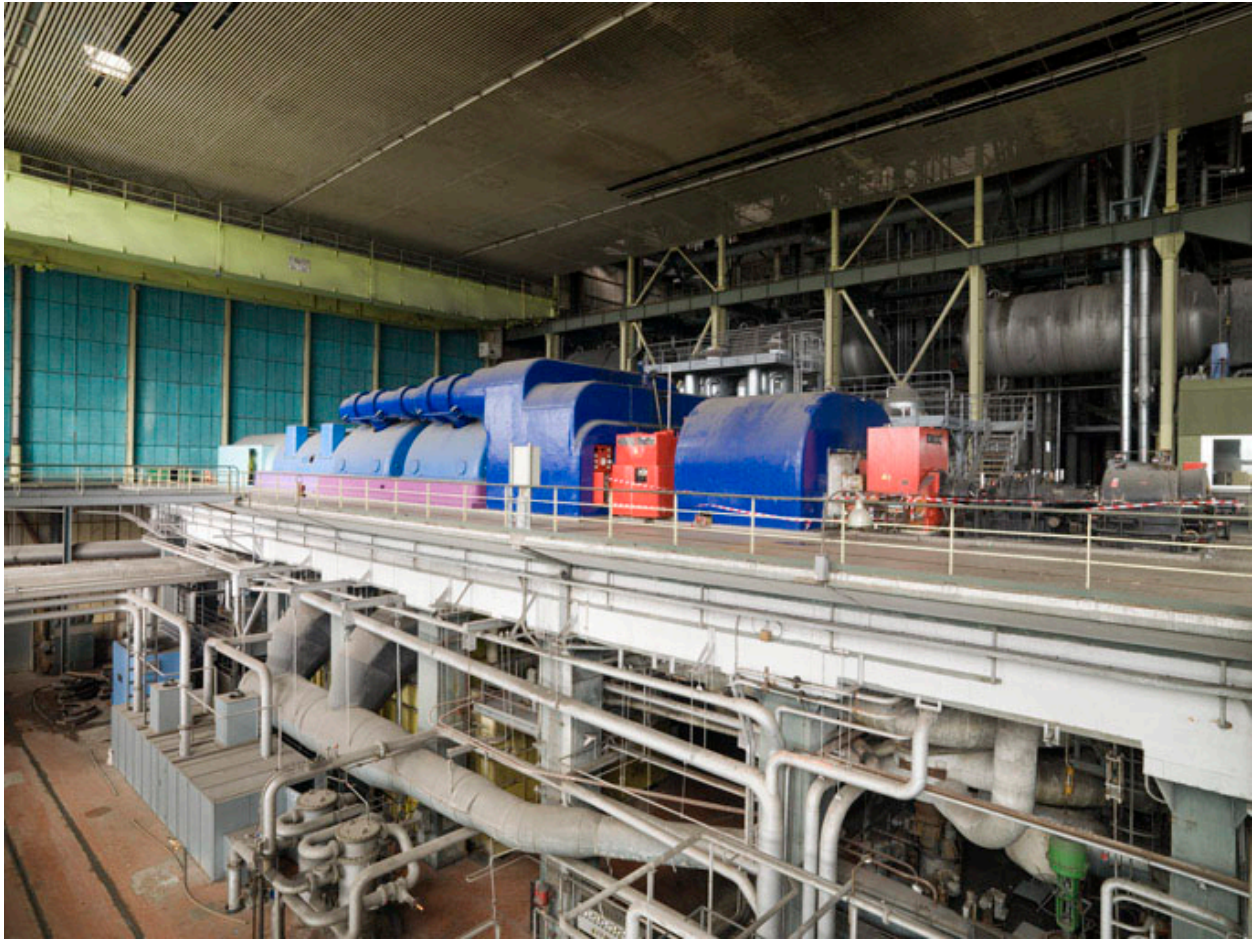
Poste d'eau. Pompe alimentaire principale.
