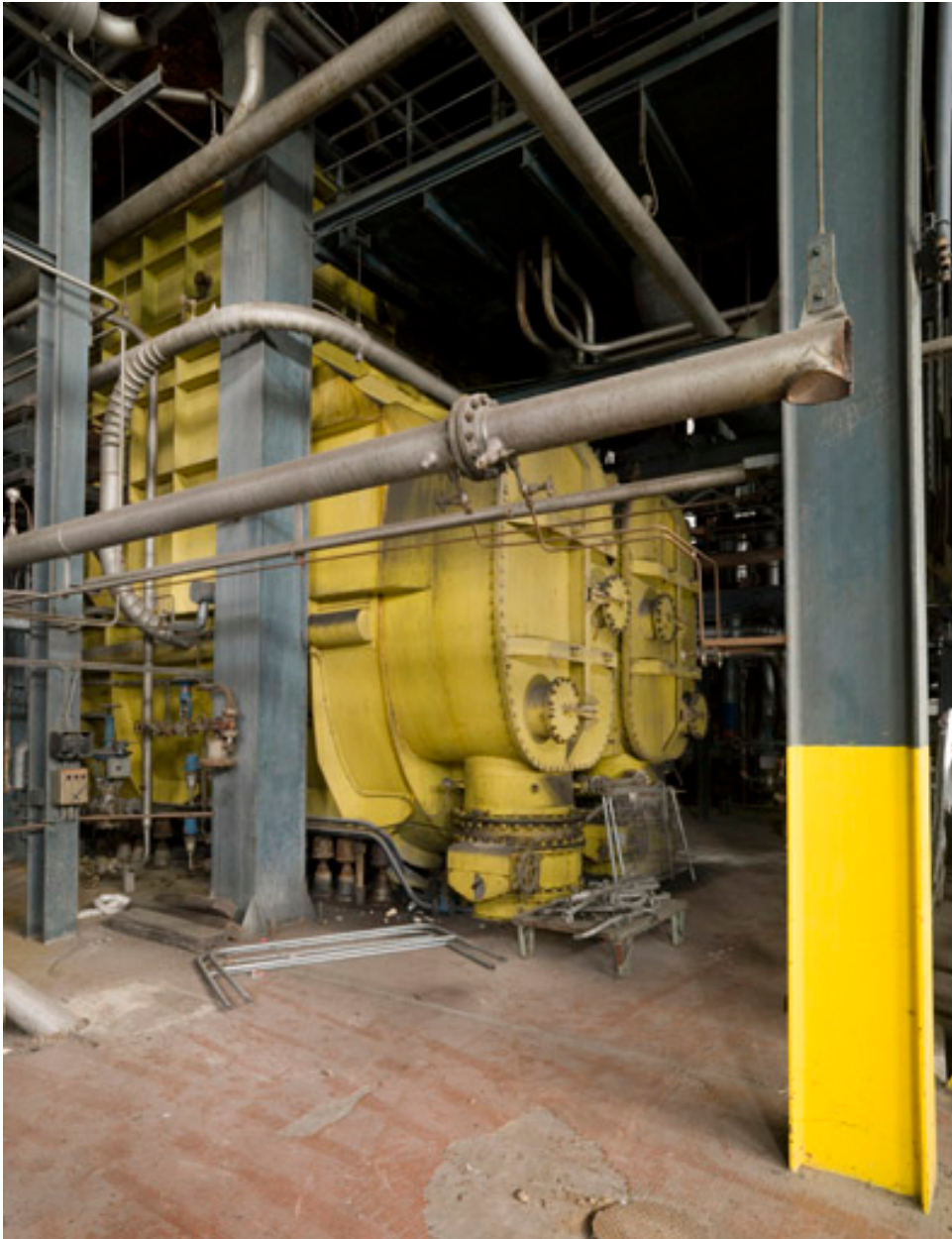
Condenseur de la tranche 125 MW.
