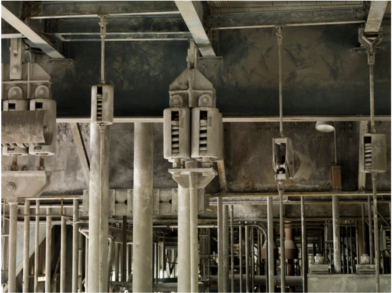
Générateur de vapeur 250 MW. Chaudière.
