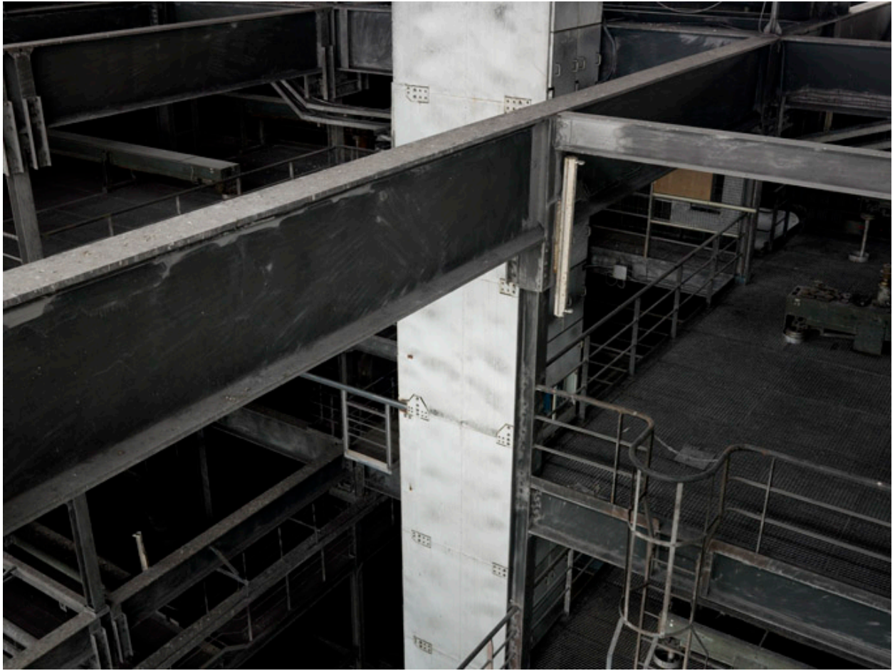
Générateur de vapeur 250 MW. Structure métallique.
