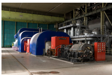
Poste d'eau. Pompe alimentaire principale. Phot. Philippe Ayrault IVR11_20087700524NUC4A
