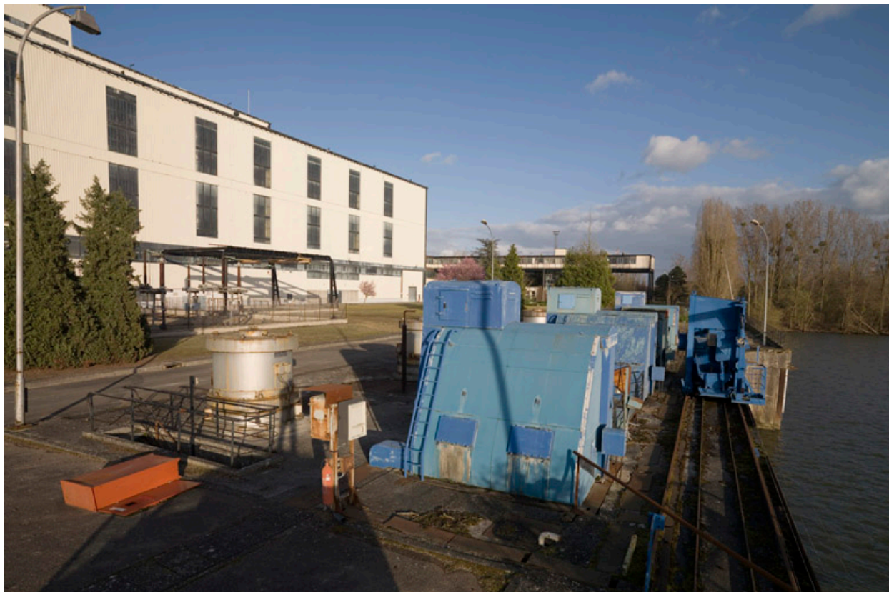
Stations de pompage.
