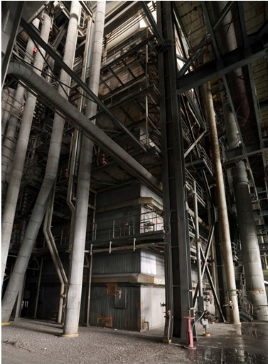
Générateur de vapeur 250 MW.
