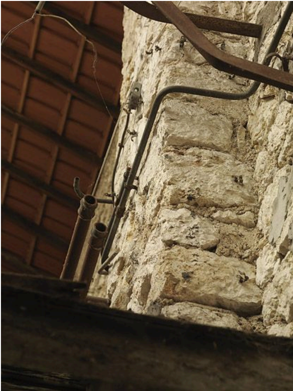
Contrefort du mur oriental de l'ancienne remise de voitures de la Compagnie des Tramways de Fontainebleau.
