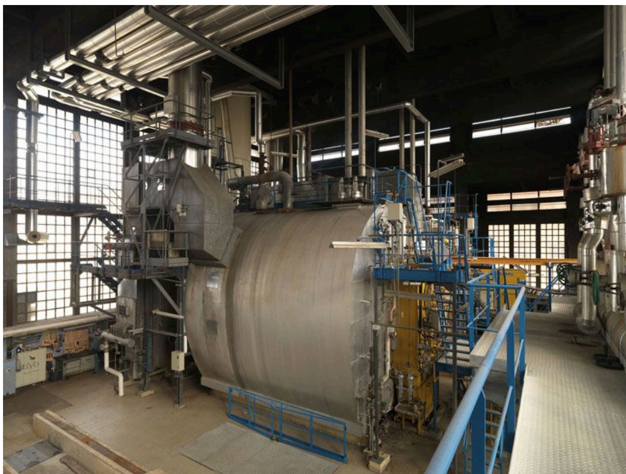
Site Sanofi. Vue intérieure bâtiment de la chaufferie.
