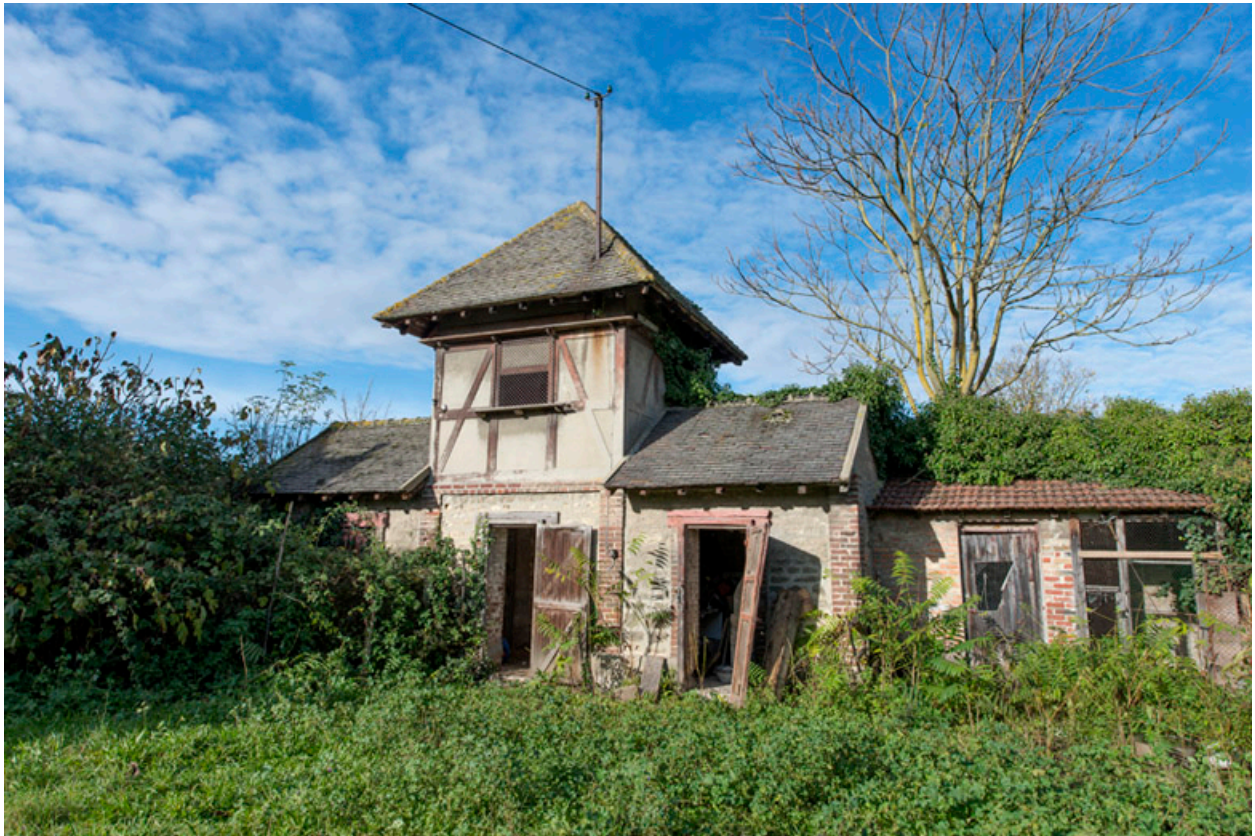
Vue du poulailler en mauvais état.
