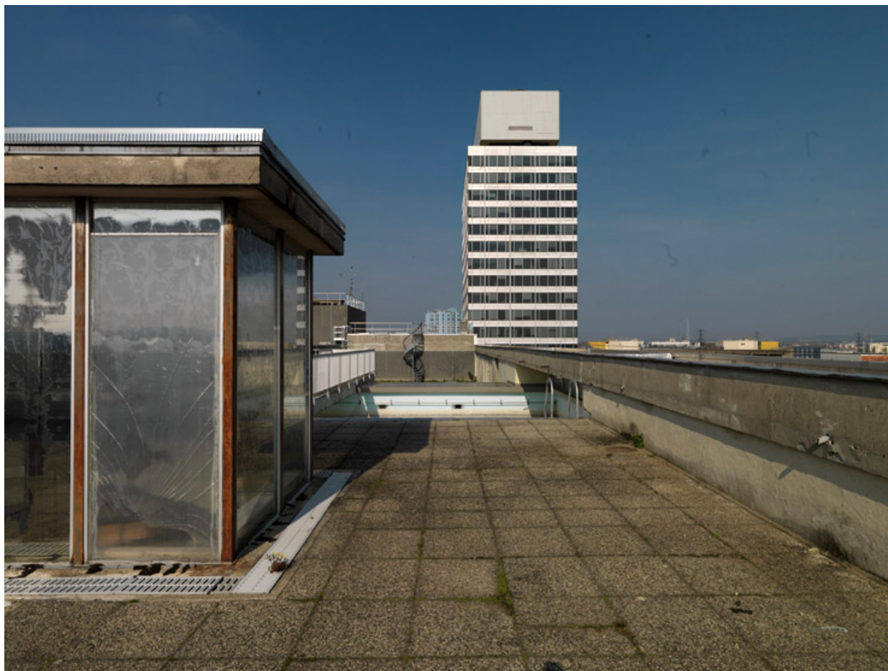
Vue générale du toit-terrasse de la préfecture, en direction de la dalle et de la tour EDF-GDF.
