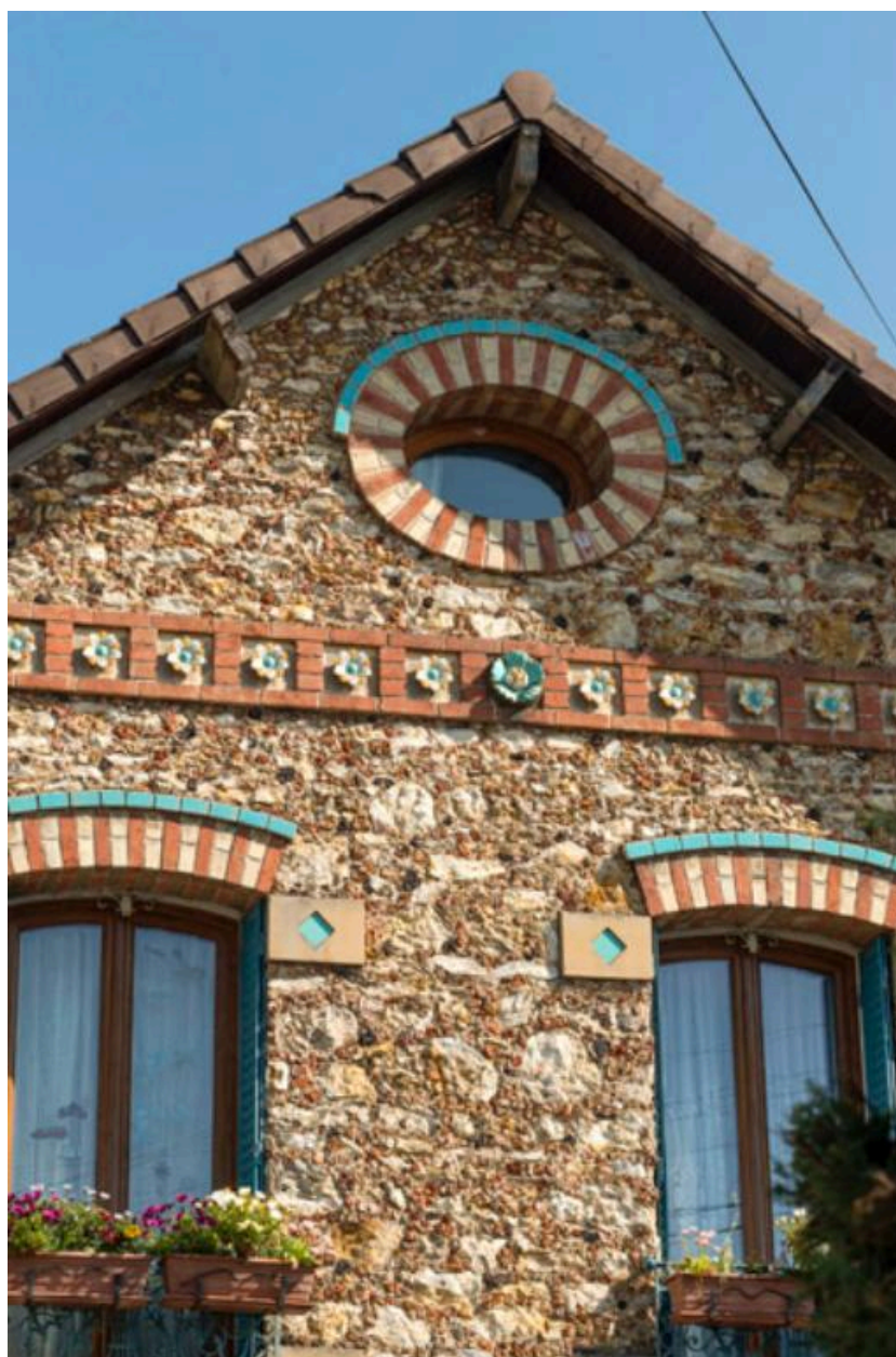
Les Mureaux. Maisons jumelles, 32-34, boulevard du Maréchal Foch. Détail du décor du pignon..
