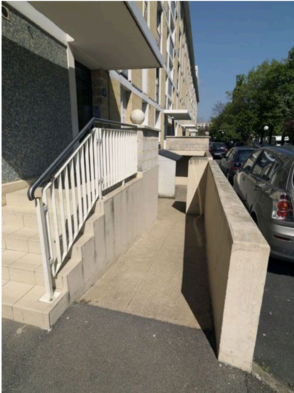
Rampe d'accès aux caves et escalier vers l'entrée de la barre D.
