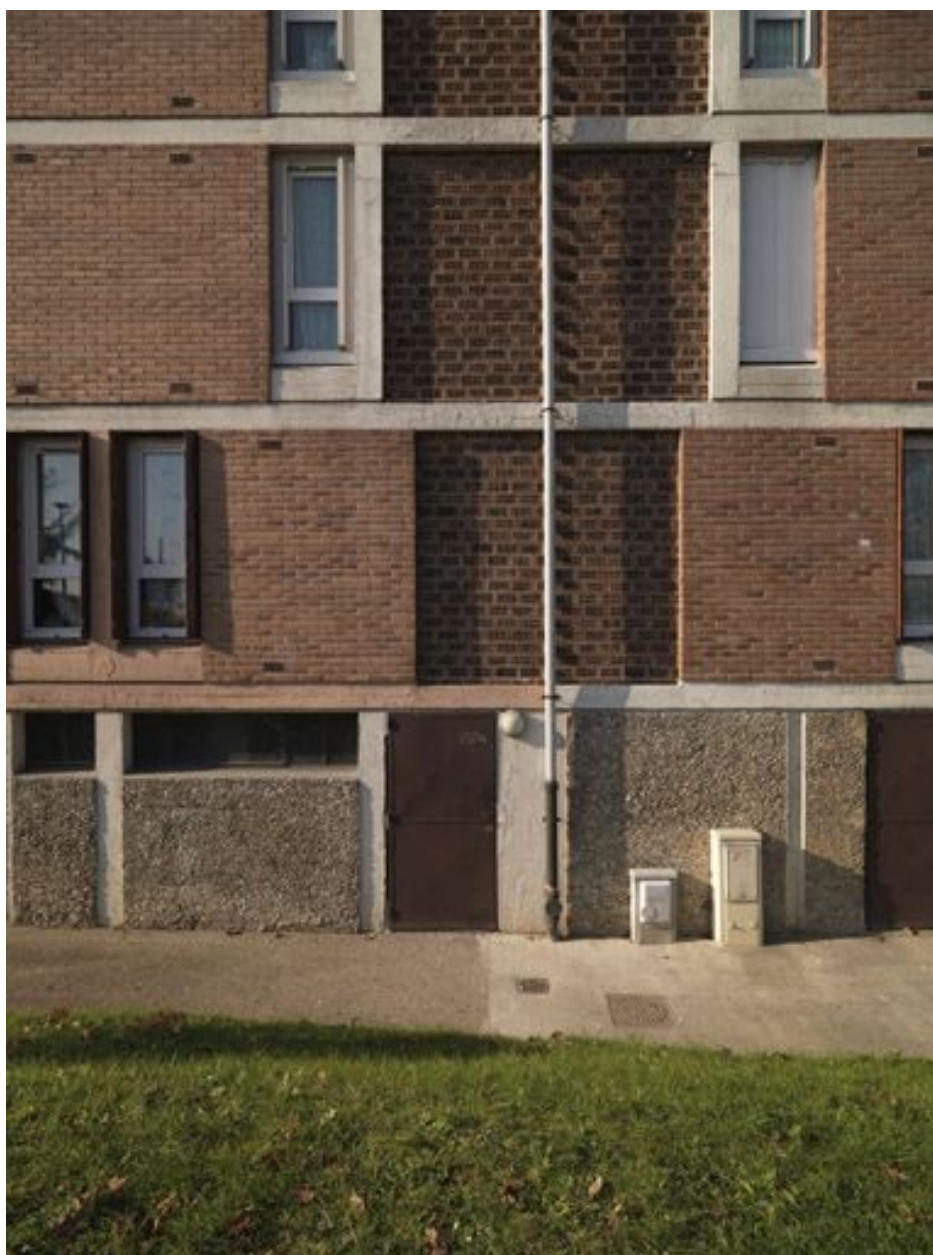
Détail de la façade de l'immeuble parallèle à la rue Henri-Barbusse (n° 155-163), animée par l'emploi de deux teintes de briques.
