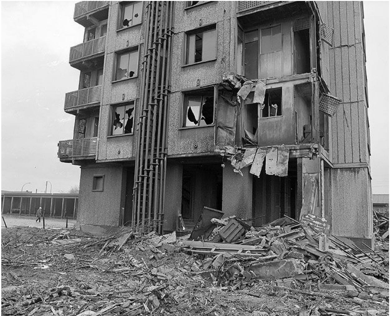
Tour 5, façade ouest. Campagne photographique, lors de la destruction du bâtiment en 1976.
