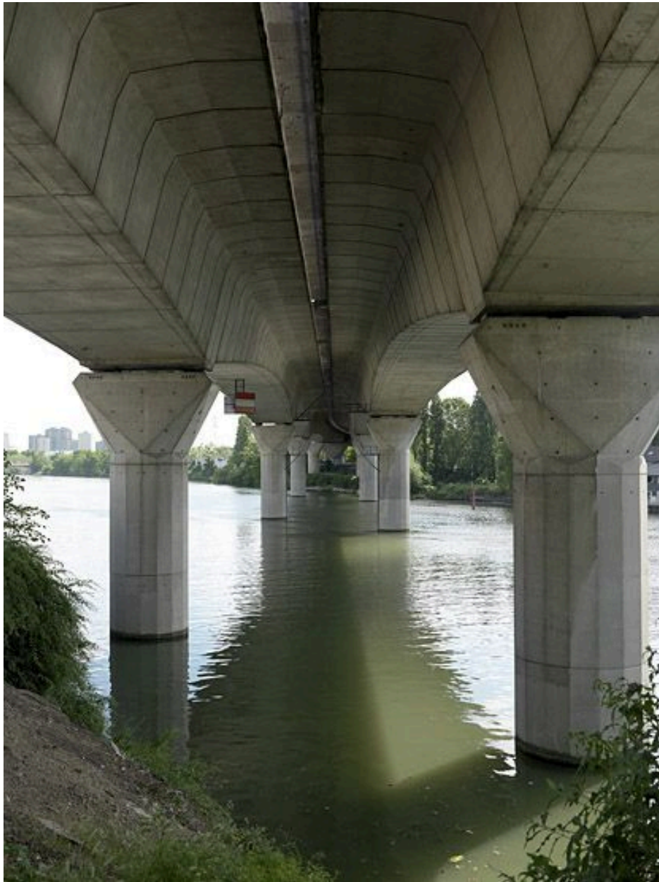
Choisy-le-Roi, Alfortville, Vitry-sur-Seine. Pont de Choisy de l'A86. Vue du dessous des tabliers.
