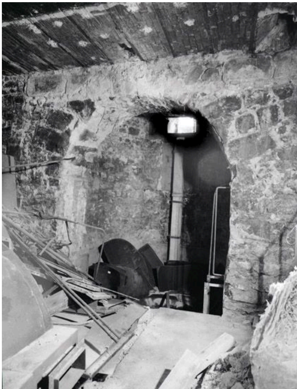
Vue du sous-sol accueillant la chaudière, sous la chapelle de semaine (ancienne sacristie néo-gothique).
