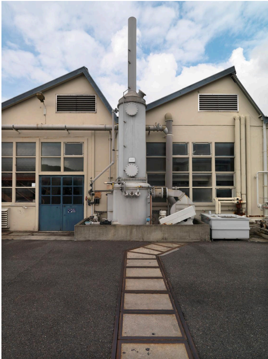
Site Biocitech, vue rapprochée d'un bâtiment de production et d'un équipement en façade.
