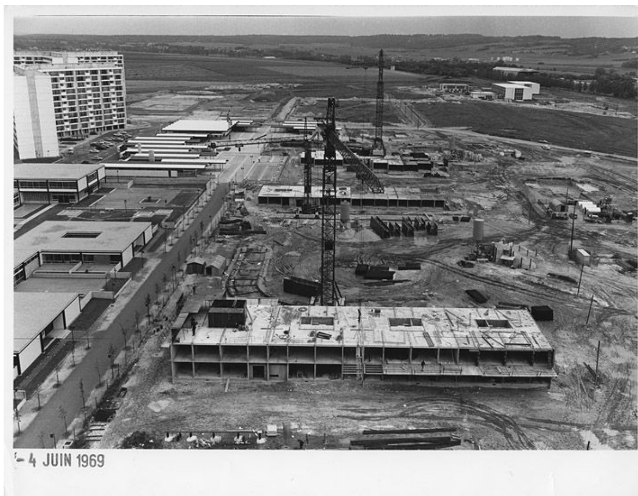
Chantier de la construction - Mise en place des grues sur rail et début de l'élévation de deux barres de Beauval. Vue de l'école primaire et du collège Camus- 4 juin 1969. (OPAC Meaux)
