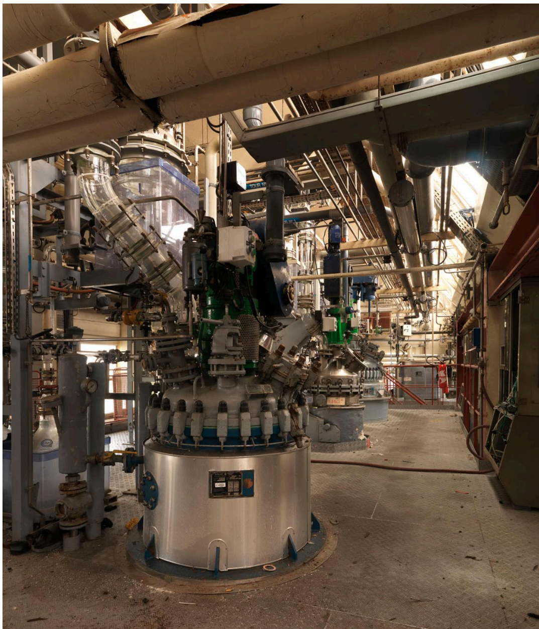
Site Biocitech, vue intérieure des équipements et machines.
