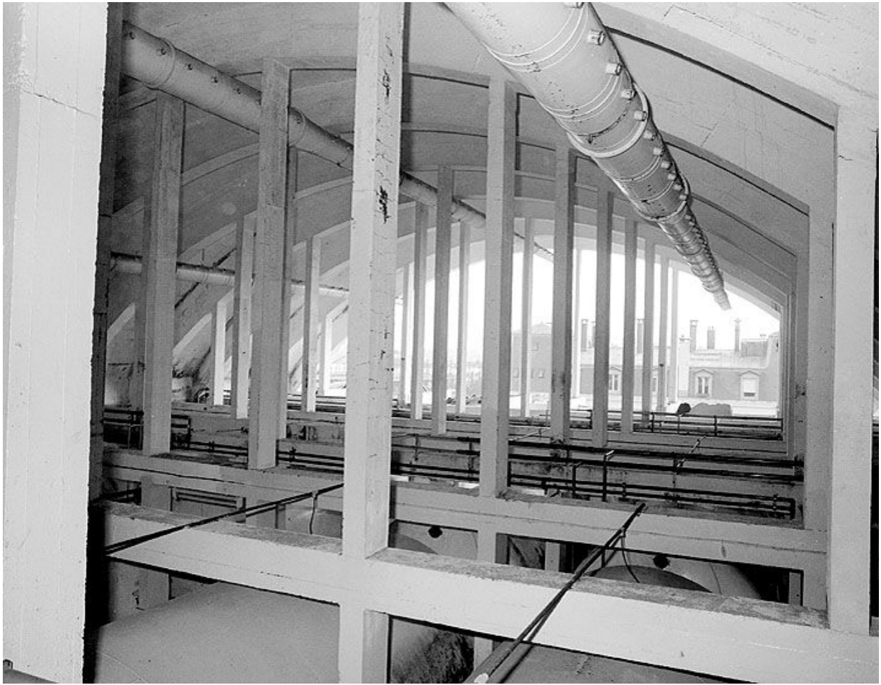
Intérieur du bâtiment de cuvage : structure des combles. Photographie avant destruction, 1989. (Ministère de la culture, Inventaire général. 89SG694X)
