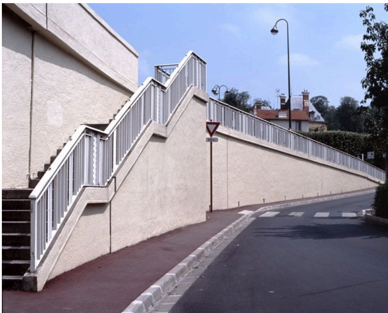
Détail des éléments du garde-corps d'origine du pont en béton construit en 1935-38.
