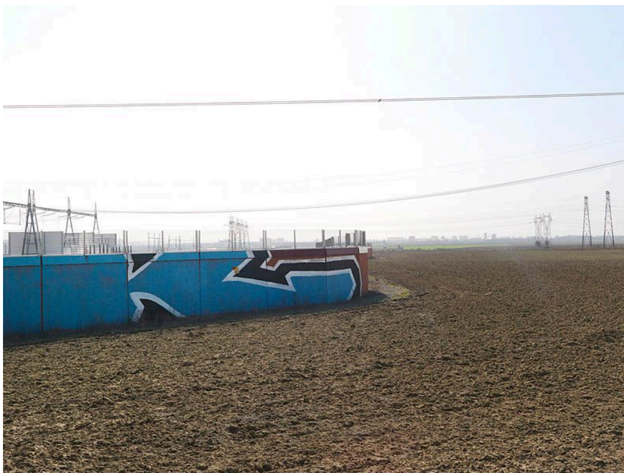
93, Tremblay-en-France. Champs et graffitis sur le mur d'un poste électrique.
