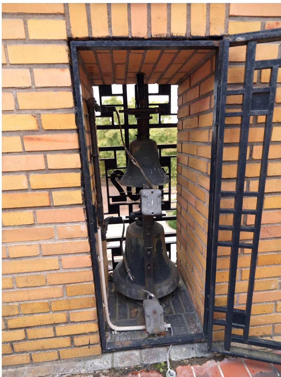
Détail du mécanisme des cloches du lycée, dissimulées de chaque côté de l'horloge.
