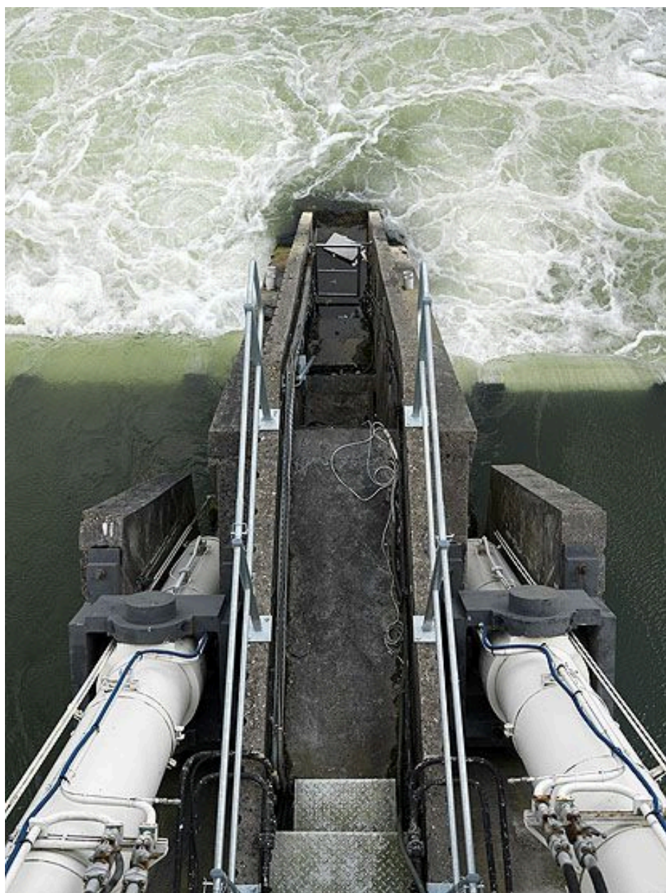
Ablon-sur-Seine, Vigneux. Barrage éclusé. Détail des vérins des vannes du barrage.
