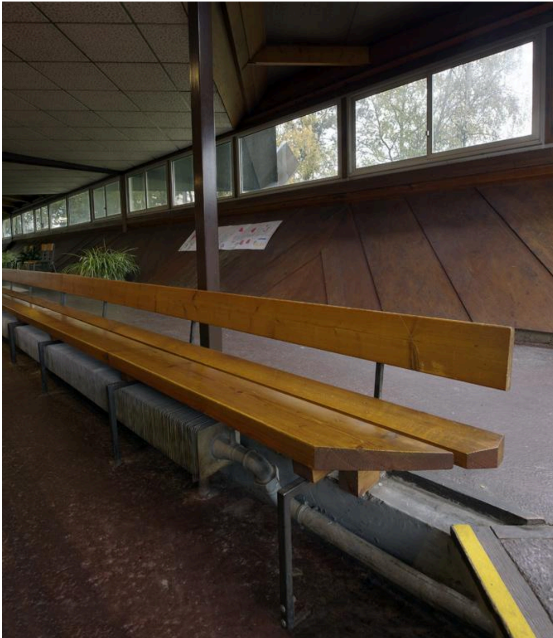
Vue de détail sur le système de chauffage.
