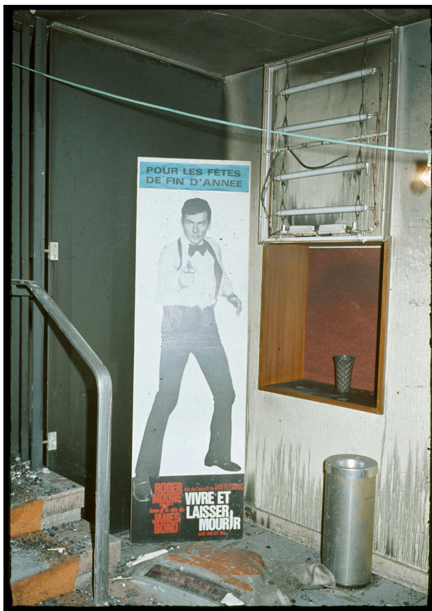
1973, le cinéma Publicis-Orly après l'incendie du 3 décembre 1973, 4ème étage.
