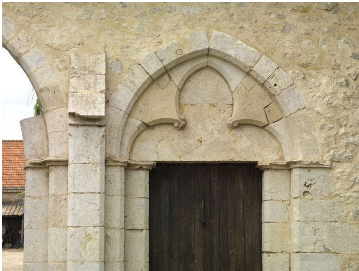
Détail du tympan en tiers-point et de l'arcature trilobée de la porte piétonne.
