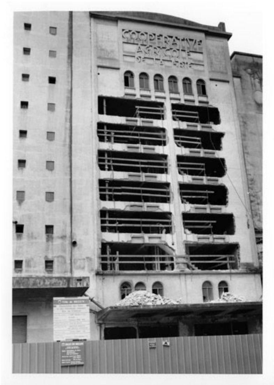
La façade des silos en cours de démolition. 1er novembre 1998. (Collection particulière)
