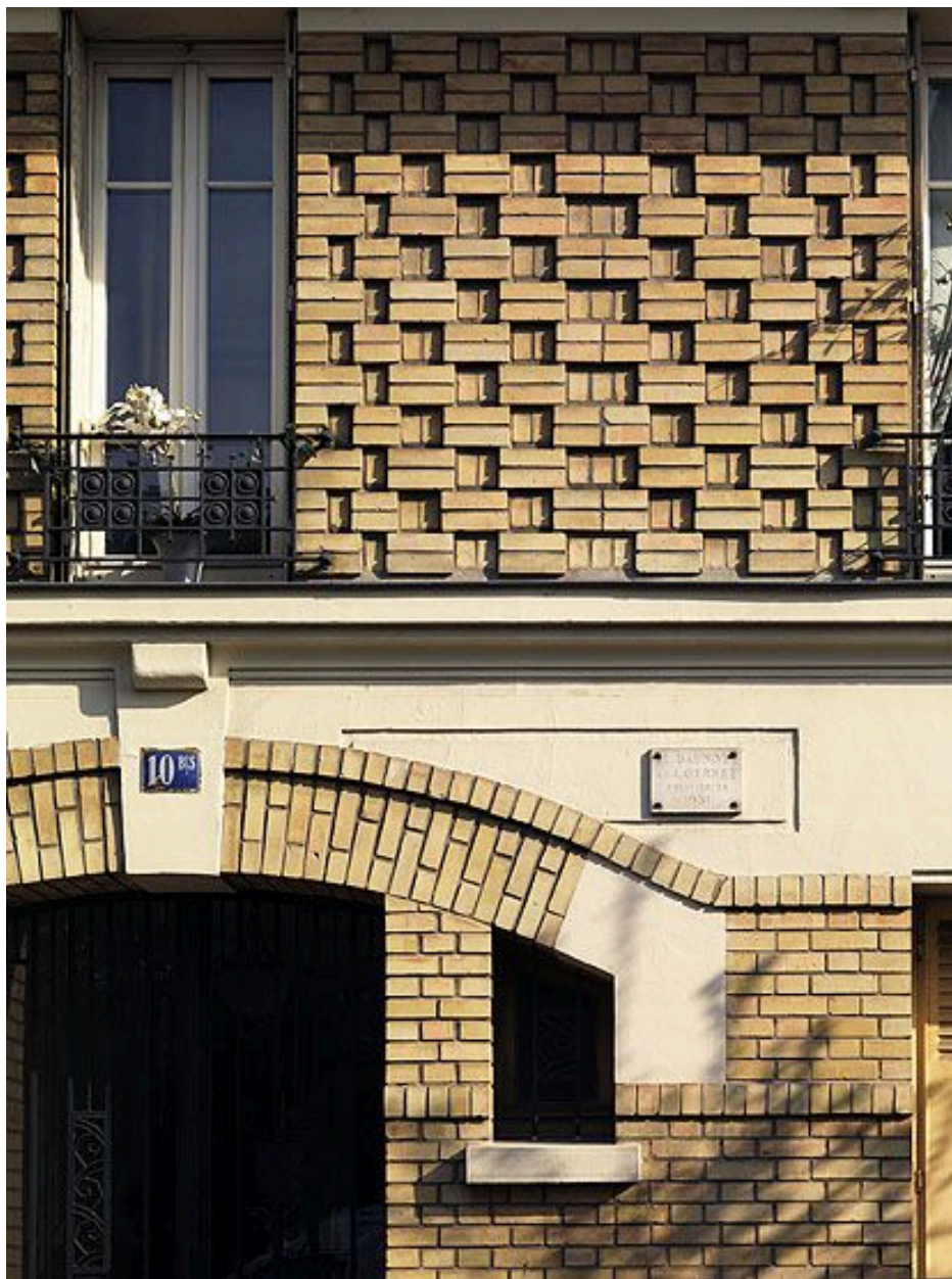
94, Maisons-Alfort, immeuble ,10 bis rue Gabriel-Péri . Détail de l'appareil de brique en relief et en damier sur la façade sur rue.
