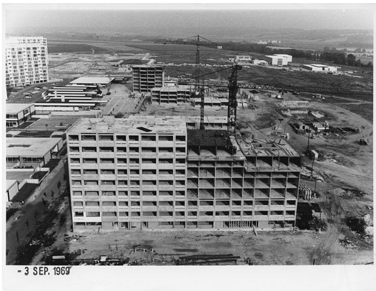
Chantier de la construction - Mise en place des grues sur rail et avancement de l'élévation des barres de Beauval. Vue de l'école primaire et du collège Camus- 4 juin 1969. (OPAC Meaux)
