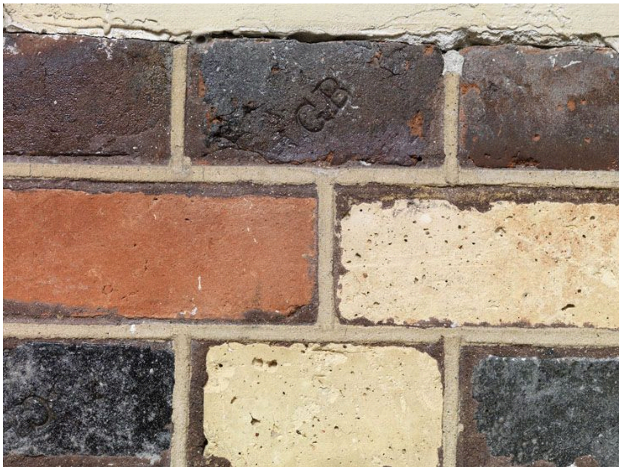
92, Sceaux, lycée Lakanal, 3-7 avenue du Président-Franklin-Roosevelt. Grande galerie nord-sud : briques polychromes en soubassement des murs.
