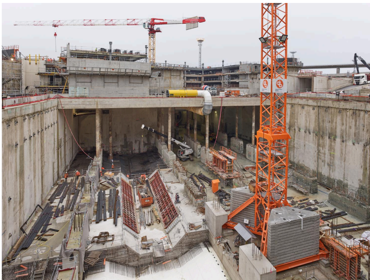
16/12/2020, chantier de construction de la station de métro Aéroport d'Orly (lignes 14 et 18) vu depuis le sud.
